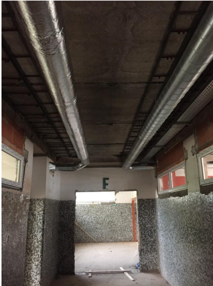
Obr. 17: Špatné napojení přiváděného a odváděného vzduchu [Vytvořeno autorem]
