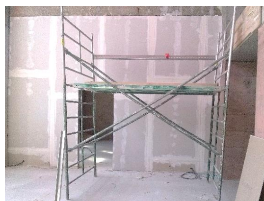
Obrázek 39 – budova B – špatná konstrukce lešení – chybí zábradlí, středový prvek a okopová lišta (archiv autora)
