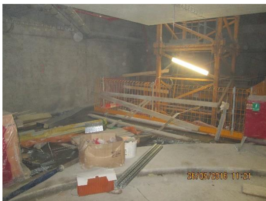
Obrázek 144 – budova A – nepořádek na stavbě, špatné skladování materiálu (Archiv autora)
