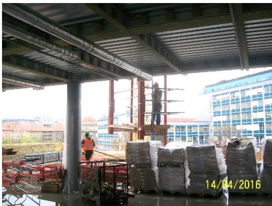
Obrázek 12 – budova A – pracovník na špatné konstrukci – chybí středový prvek a okopová lišta, pracovník nepoužívá OOPP (archiv autora)
