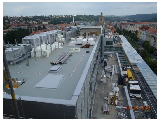
Obrázek 183 – budova B – nepořádek, špatné skladování materiálu, nezabezpečený materiál proti odlétnutí (Archiv autora)
