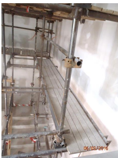
Obrázek 169 – budova B – špatná konstrukce lešení – chybí středový prvek a okopová lišta (archiv autora)
