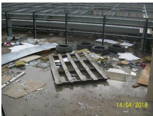
Obrázek 8 – budova A - nezabezpeč. materiál proti odlétnutí, nepořádek (archiv autora)
