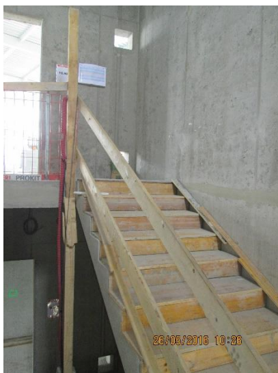
Obrázek 155 – budova A – špatná konstrukce zábradlí – není dostatečně únosné a vysoké, chybí okopová lišta, porušena nosná část – nosný sloupek (archiv autora)
