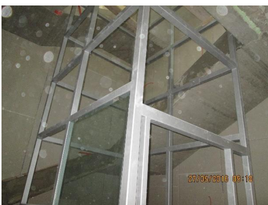
Obrázek 159 – budova B – chybí zajištění proti pádu (archiv autora)
