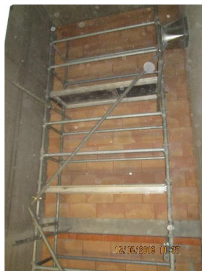
Obrázek 129 – budova A – špatná konstrukce lešení – chybí okopová lišta (archiv autora)
