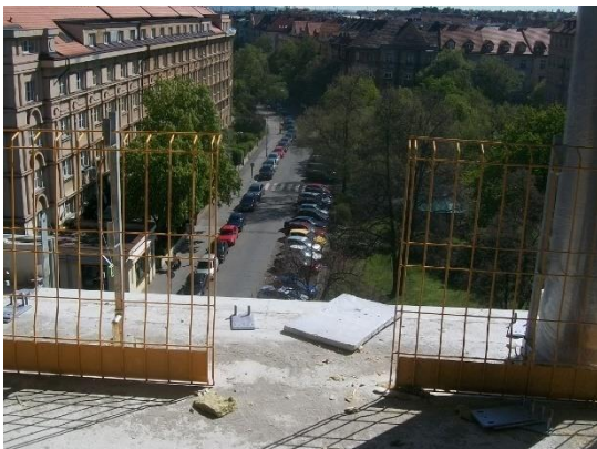
Obrázek 70 – budova A – chybí zajištění proti pádu (archiv autora)
