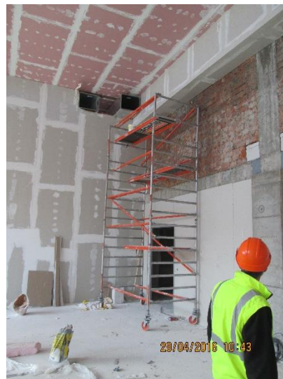
Obrázek 59 – budova B – špatná konstrukce lešení – nízké zábradlí, chybí středový prvek a okopová lišta (archiv autora)
