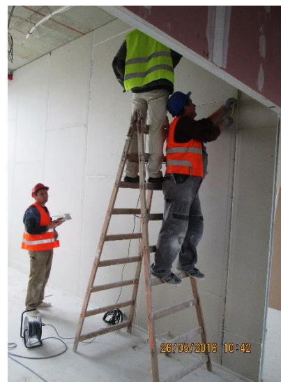
Obrázek 152 – budova B – špatné užívání dvojitého žebříku, pracovníci nepoužívají OOPP – nevhodná obuv (archiv autora)
