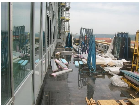
Obrázek 79 – budova B – nezabezpeč. lehký materiál proti odlétnutí, nepořádek na stavbě, špatné skladování materiálu (Archiv autora)
