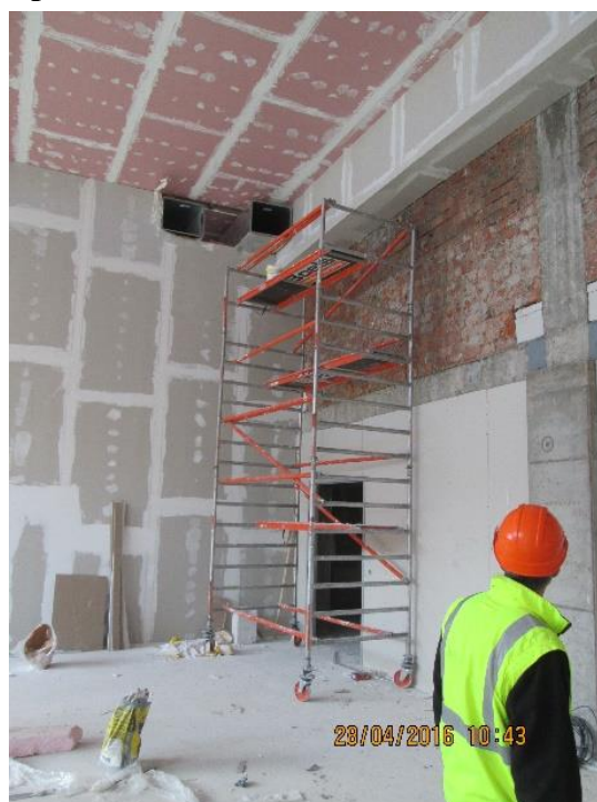
Obrázek 199 – budova B – špatná konstrukce lešení (archiv autora)
