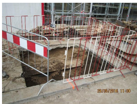
Obrázek 160 – okolí stavby – špatná konstrukce zábradlí – není dostatečně únosné, zábradlí není po celé délce hrany (archiv autora)
