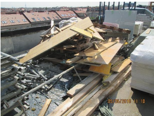
Obrázek 81 – budova B – nezabezpeč. lehký materiál proti odlétnutí, nepořádek na stavbě, špatné skladování materiálu (Archiv autora)
