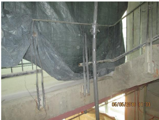
Obrázek 89 – budova B – špatná konstrukce zábradlí – zábradlí není dostatečně únosné, chybí středový prvek a okopová lišta (archiv autora)
