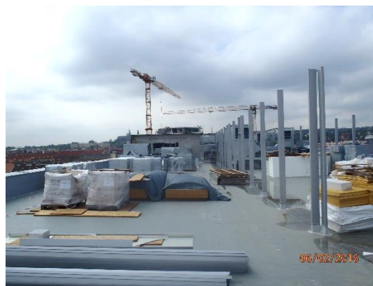
Obrázek 165 – budova B – nepořádek na střeše, nezabezpečený lehký materiál proti odlétnutí (Archiv autora)
