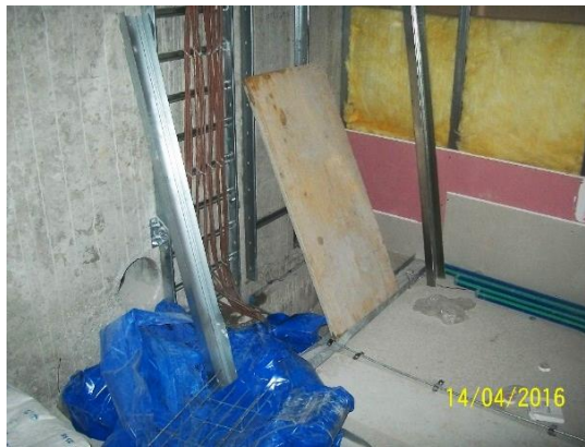
Obrázek 21 – budova B – otvor není dostatečně zajištěný proti pádu – nesplňuje normové požadavky, špatně zvolená konstrukce zajištění (archiv autora)
