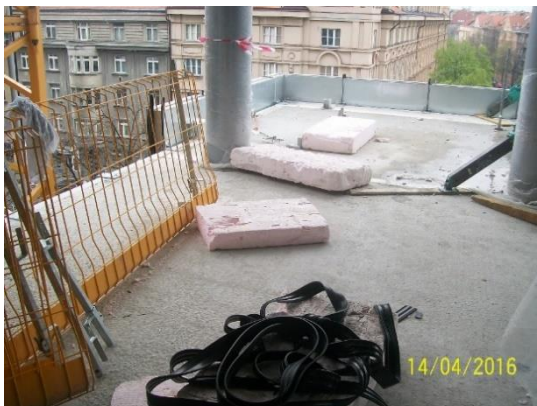
Obrázek 6 – budova A - nezabezpečený materiál proti odlétnutí, nepořádek, špatné skladování materiálu (archiv autora)
