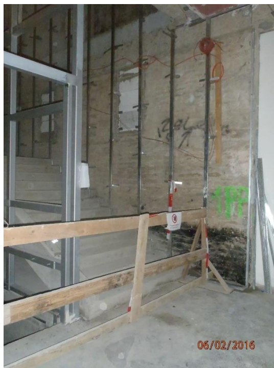
Obrázek 198 – budova B – správně uzavřený a ohraničený prostor proti pádu do prostoru schodiště (archiv autora)
