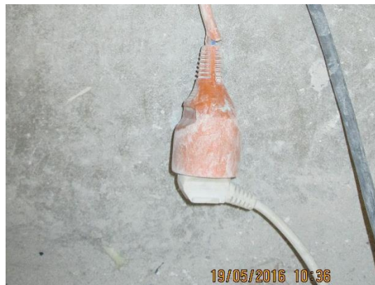
Obrázek 143 – budova B – porušení elektrického zařízení – porušená koncovka (Archiv autora)
