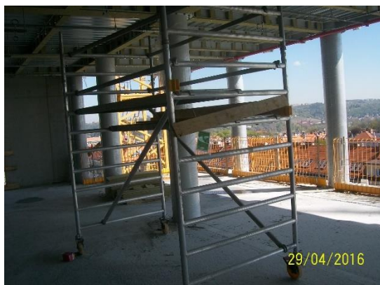
Obrázek 60 – budova A – špatná konstr. lešení – nízké zábradlí a okopová lišta (archiv autora)
