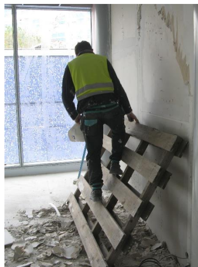
Obrázek 133 – budova A – špatně zvolená konstrukce k vyvýšení pracoviště, pracovník nepoužívá OOPP – pracovní helmu (archiv autora)
