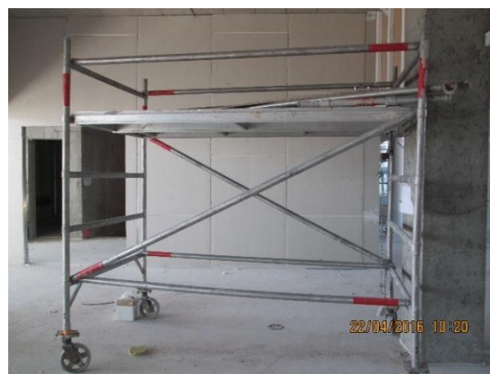
Obrázek 41 – budova B – špatná konstrukce lešení – nízké zábradlí a okopová lišta (archiv autora)
