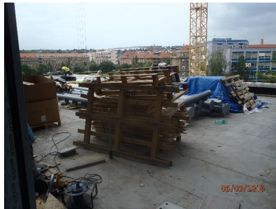
Obrázek 181 – okolí stavby – nepořádek, špatné skladování materiálu (Archiv autora)
