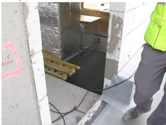
Obrázek 138 – budova B – chybí zajištění proti pádu (archiv autora)
