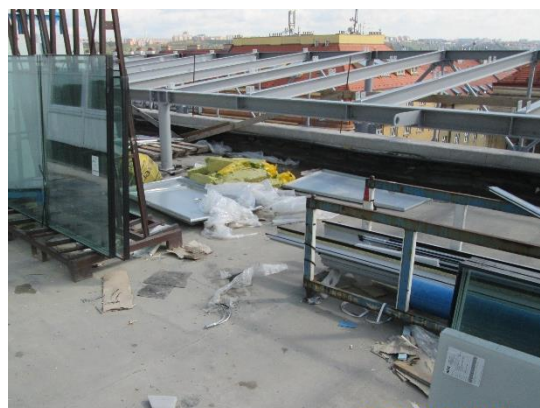
Obrázek 55 – budova B – nezabezpeč. lehký materiál proti odlétnutí, nepořádek na stavbě, špatné skladování materiálu (Archiv autora)
