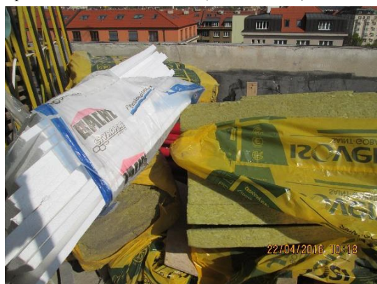
Obrázek 33 – budova B – nezabezpeč. lehký materiál proti odlétnutí, nepořádek na stavbě, špatné skladování materiálu (Archiv autora)
