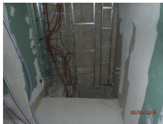
Obrázek 192 – budova A – chybí zajištění proti pádu (archiv autora)
