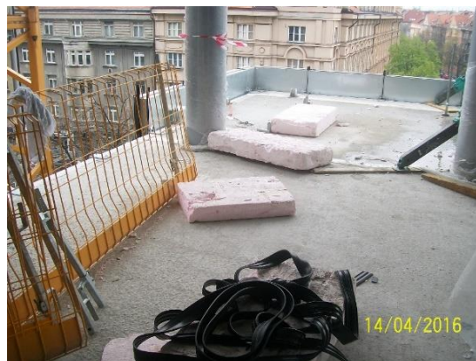
Obrázek 19 – budova A – chybí zajištění proti pádu (archiv autora)
