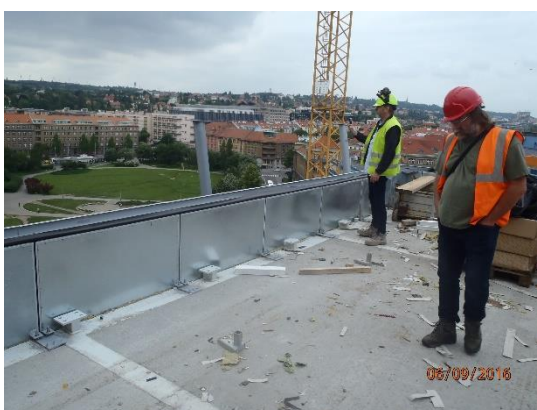
Obrázek 193 – budova A – špatné zajištění proti pádu – nízké (archiv autora)
