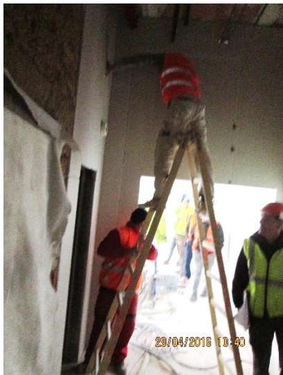
Obrázek 64 – budova B – špatné užívání dvojitého žebříku - pracovník nestojí čelně k žebříku a nedodrží bezpečnou vzdálenost od horní hrany, nestabilní konstrukce žebříku (archiv autora)
