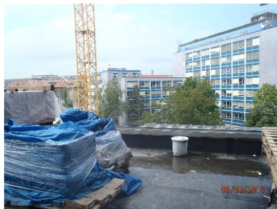
Obrázek 175 – budova A – chybí zajištění proti pádu (archiv autora)
