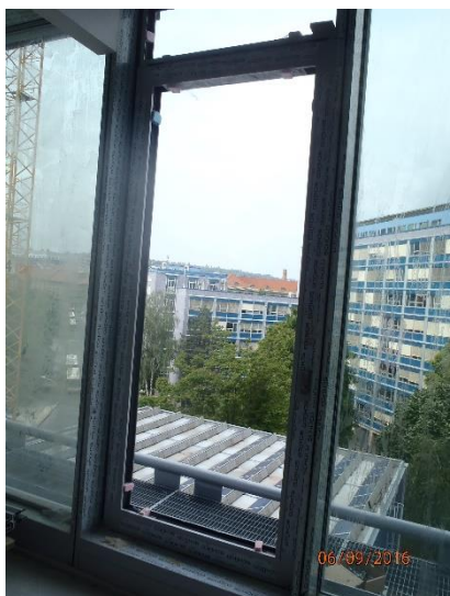
Obrázek 189 – budova A – chybí zajištění proti pádu (archiv autora)
