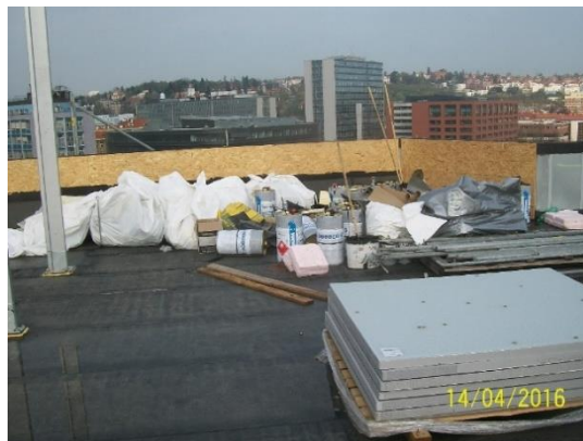
Obrázek 7 – budova B – nezabezpečený materiál proti odlétnutí, nepořádek, špatné skladování materiálu (archiv autora)
