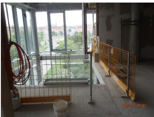
Obrázek 191 – budova A – špatné zajištění proti pádu – zajištění není po celé hraně (archiv autora)
