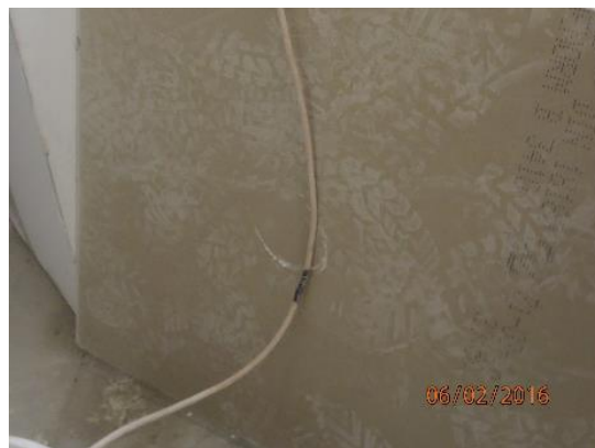
Obrázek 178 – budova B – špatně provedená oprava kabelu (Archiv autora)
