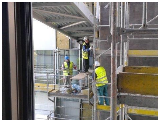
Obrázek 86 – budova B – pracovníci nevhodně užívají fasádní lešení – použ. Nevhod. konstrukci k vyvýšení pracoviště (archiv autora)
