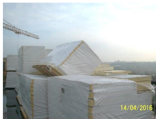
Obrázek 9 – budova B – nezabezpeč. materiál, špatné skladování materiálu (archiv autora)
