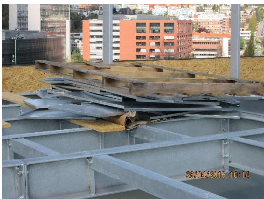
Obrázek 54 – budova B – nepořádek na stavbě, špatné skladování materiálu (Archiv autora)
