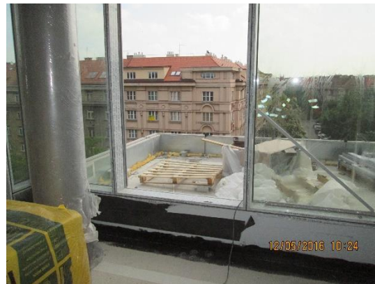
Obrázek 117 – budova A – chybí zajištění proti pádu (archiv autora)
