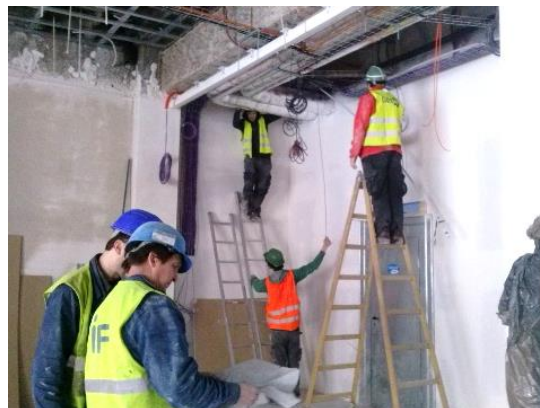
Obrázek 43 – budova B – špatné užívání žebříku – pracovníci nestojí čelně k žebříku a nedodržují bezpečnou vzdálenost od horního konce, nestabilní konstrukce žebříku, pracovník nepoužívá OOPP – pracovní helmu (archiv autora)
