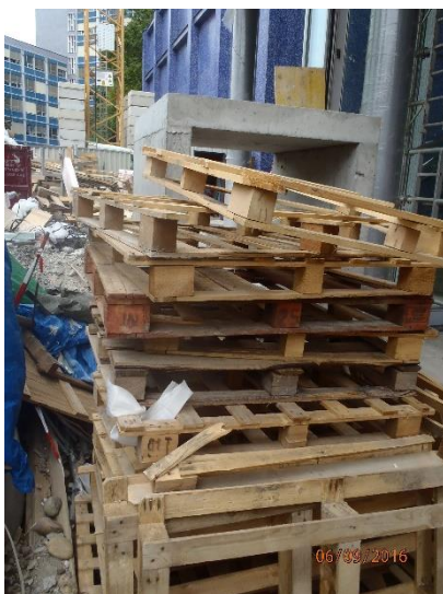
Obrázek 184 – okolí stavby – nepořádek, špatné skladování materiálu (Archiv autora)
