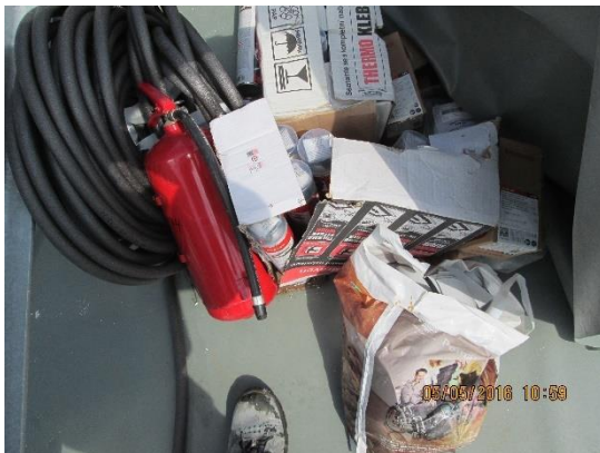
Obrázek 77 – budova A – nezabezpeč. lehký materiál proti odlétnutí, nepořádek na stavbě, špatné skladování materiálu (Archiv autora)
