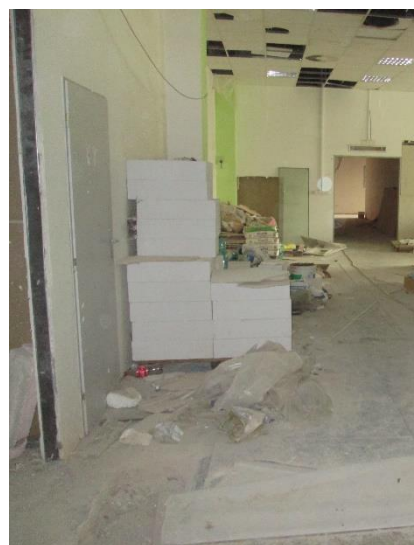
Obrázek 147 – budova B – nepořádek, špatné skladování materiálu (Archiv autora)
