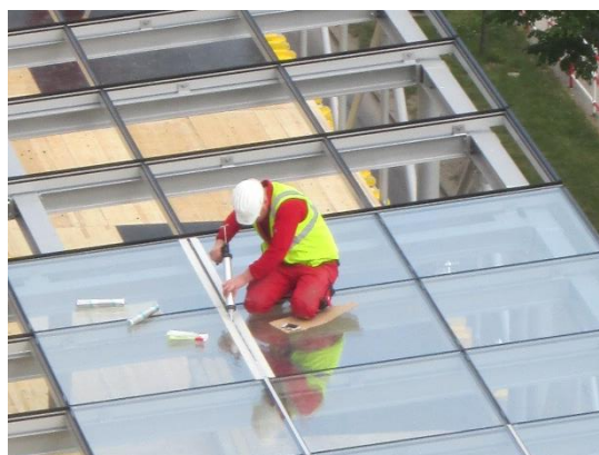
Obrázek 109 – budova B – pracovník nepoužívá OOPP – zajištění proti pádu (archiv autora)
