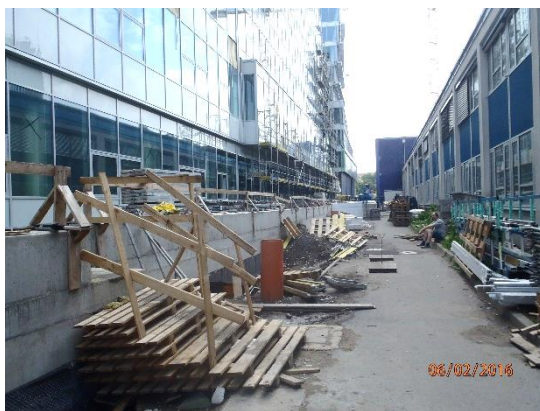
Obrázek 164 – okolí stavby – nepořádek, špatné skladování materiálu (Archiv autora)
