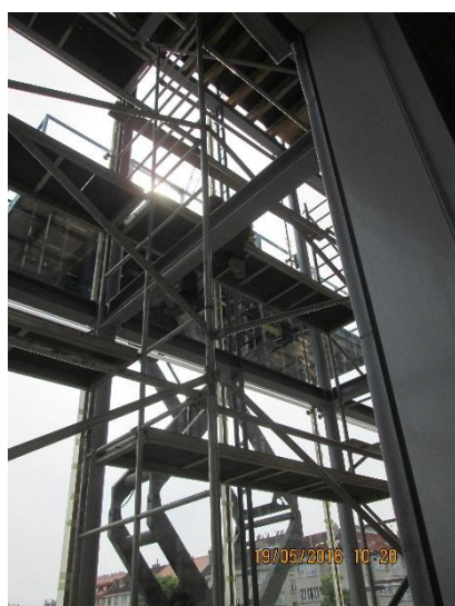
Obrázek 130 – budova A – špatná konstrukce lešení – chybí zábradlí, středový prvek a okopová lišta (archiv autora)
