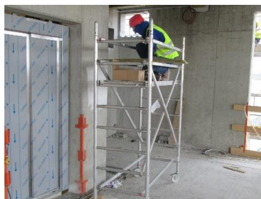
Obrázek 103 – budova A – špatná konstrukce lešení – nízké zábradlí, chybí okopová lišta (archiv autora)
