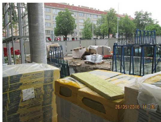
Obrázek 145 – okolí stavby – nepořádek, špatné skladování materiálu (Archiv autora)
