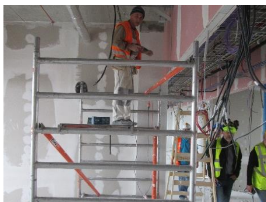
Obrázek 100 – budova A – špatná konstrukce lešení – nízké zábradlí, chybí středový prvek a okopová lišta pracovník na lešení nepoužívá OOPP (archiv autora)
