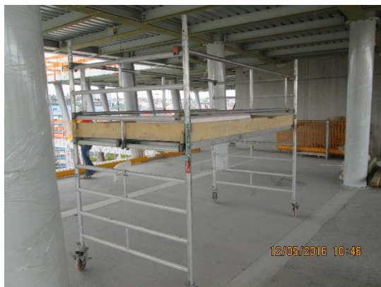
Obrázek 98 – budova A – špatná konstrukce lešení – nízké zábradlí a okopová lišta (archiv autora)
