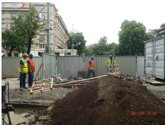
Obrázek 187 – okolí stavby – chybí zajištění proti pádu (archiv autora)
