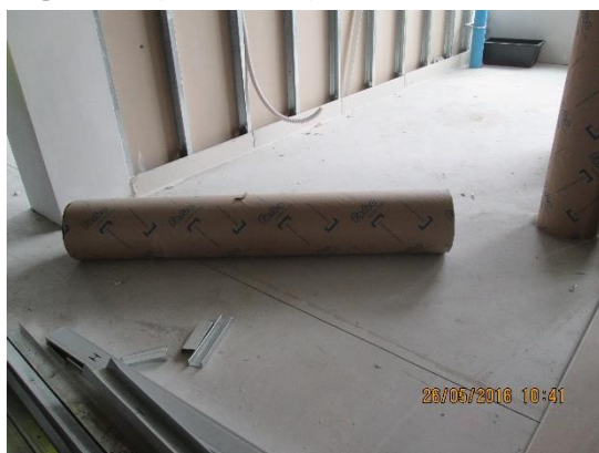
Obrázek 148 – budova B – nepořádek, špatné skladování materiálu (Archiv autora)
