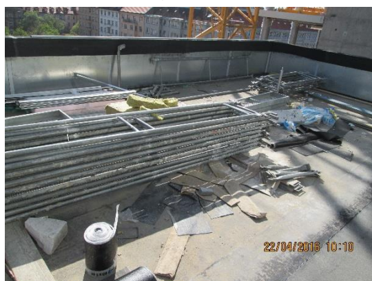
Obrázek 35 - budova B – nezabezpečený lehký materiál proti odlétnutí, nepořádek na stavbě, špatné skladování materiálu (Archiv autora)
