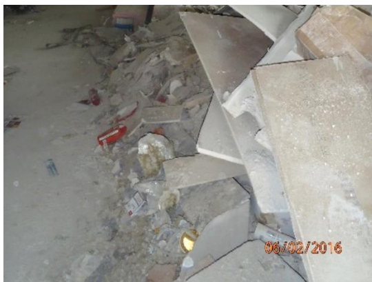
Obrázek 166 – Budova B – nepořádek, špatné skladování materiálu (Archiv autora)
