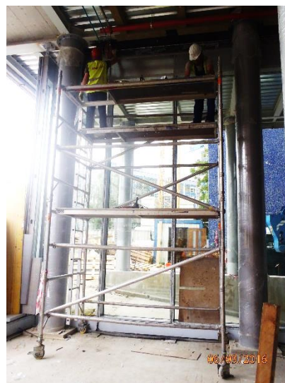
Obrázek 186 – budova A – špatná konstrukce lešení – nízké zábradlí, chybí středový prvek a okopová lišta (archiv autora)
