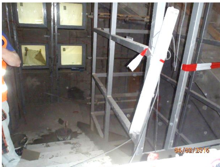
Obrázek 197 – budova B – chybí zajištění proti pádu (archiv autora)
