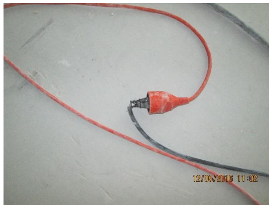
Obrázek 119 – budova B – porušené elektrické zařízení - koncovka kabelu (Archiv autora)
