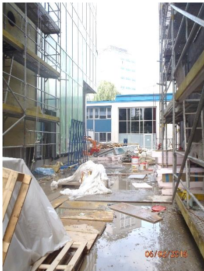
Obrázek 162 – okolí stavby – nepořádek, špatné skladování materiálu (Archiv autora)
