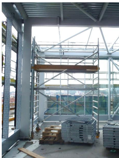
Obrázek 167 – budova A – špatná konstrukce lešení – nízké zábradlí (archiv autora)
