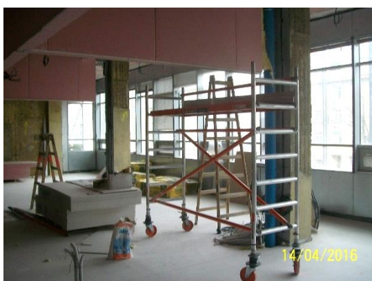
Obrázek 17 – budova B – špatná konstrukce lešení - chybí zábradlí a okopová lišta (archiv autora)
