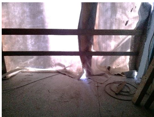
Obrázek 51 – budova B – špatná konstrukce zábradlí – není dost. únosné, nemá dostatečnou výšku, chybí okopová lišta (archiv autora)
