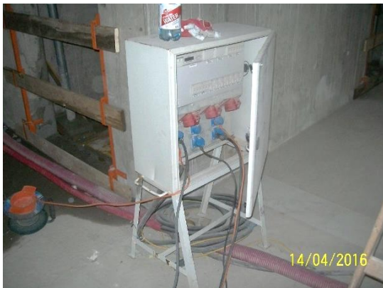
Obrázek 24 – budova A - špatně zapojené elektrické vedení – nejsou uzavřena dvířka u rozvaděče, tudíž není zabezpečeno proti neoprávněné manipulaci (Archiv autora)
