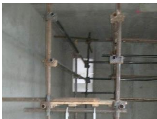
Obrázek 15 – budova B – špatná konstrukce lešení - chybí zábradlí středový prvek a okopová lišta (archiv autora)
