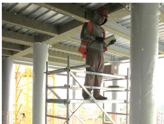
Obrázek 102 – budova A – špatná konstrukce lešení – nízké zábradlí, chybí okopová lišta (archiv autora)
