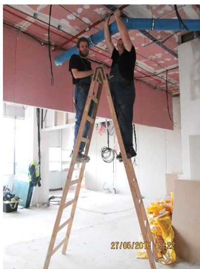
Obrázek 151 – budova B – špatné užívání dvojitého žebříku, pracovníci nepoužívají OOPP – pracovní přílby (archiv autora)
