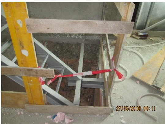
Obrázek 157 – budova B – špatná konstrukce zábradlí – není dostatečně únosné a vysoké, chybí středový prvek a okopová lišta (archiv autora)
