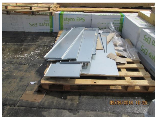
Obrázek 80 – budova B – nezabezpeč. lehký materiál proti odlétnutí, nepořádek na stavbě, špatné skladování materiálu (Archiv autora)
