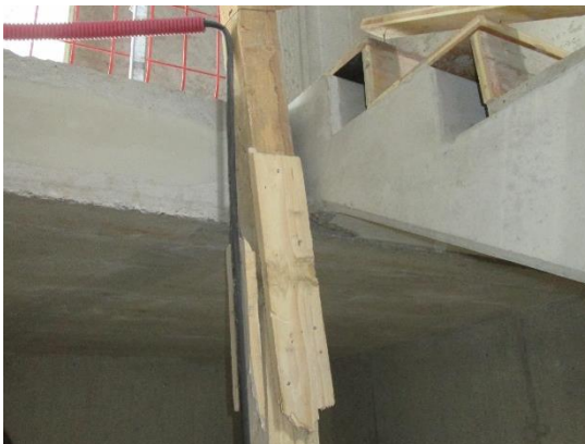
Obrázek 116 – budova A – špatná konstrukce zábradlí – není dostatečně únosné, porušena nosná část (archiv autora)
