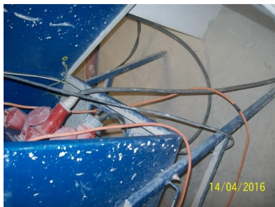
Obrázek 29 – budova B – - špatně zapojené elektrické vedení – nejsou uzavřena dvířka u rozvaděče, tudíž není zabezpečeno proti neoprávněné manipulaci (Archiv autora)
