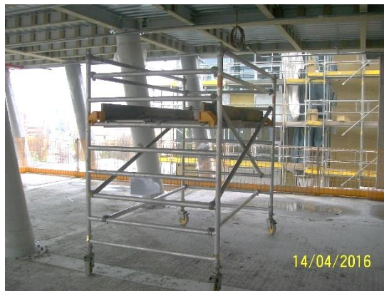
Obrázek 13 – budova A – špatná konstrukce lešení - nízké zábradlí a okopová lišta (archiv autora)
