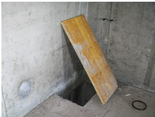
Obrázek 72 – budova A – otvor není dostatečně zajištěný proti pádu – nesplňuje normové požadavky, špatně zvolená konstrukce zajištění (archiv autora)
