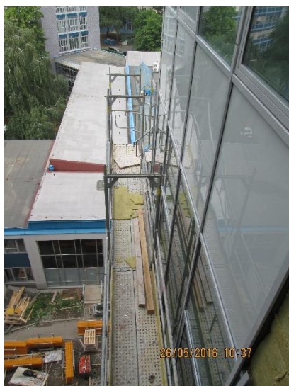
Obrázek 146 – budova A – nepořádek na lešení, chybí okopová lišta (Archiv autora)
