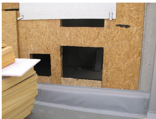
Obrázek 140 – budova B – chybí zajištění proti pádu do otvorů (archiv autora)
