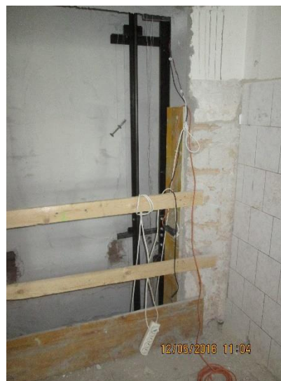
Obrázek 121 – budova B – použití nevhodných elektrických zařízení - prodlužovací kabel určený do domácnosti (Archiv autora)
