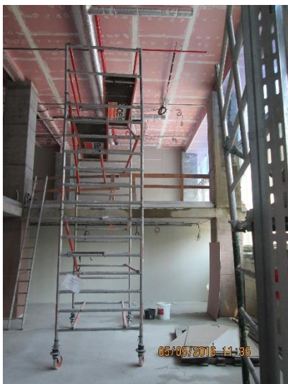
Obrázek 83 – budova B – špatná konstrukce lešení – nízké zábradlí, chybí středový prvek a okopová lišta (archiv autora)
