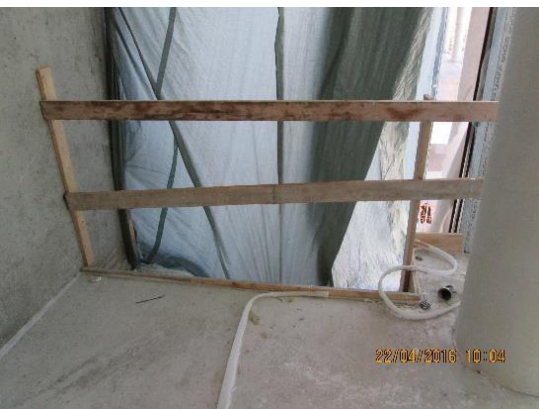
Obrázek 50 – budova B – špatná konstrukce zábradlí – není dost. únosné, nemá dostatečnou výšku, chybí okopová lišta (archiv autora)
