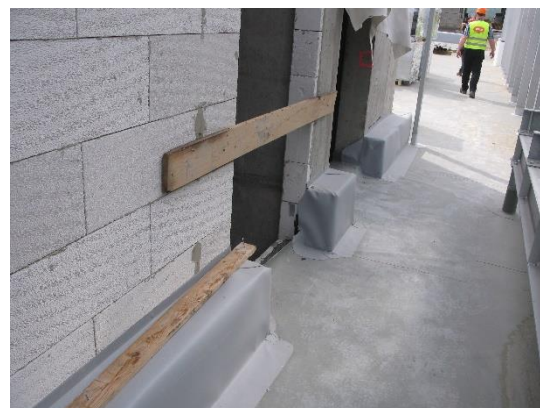
Obrázek 139 – budova B – špatná konstrukce zábradlí – zábradlí není dostatečně únosné, chybí středový prvek a okopová lišta (archiv autora)
