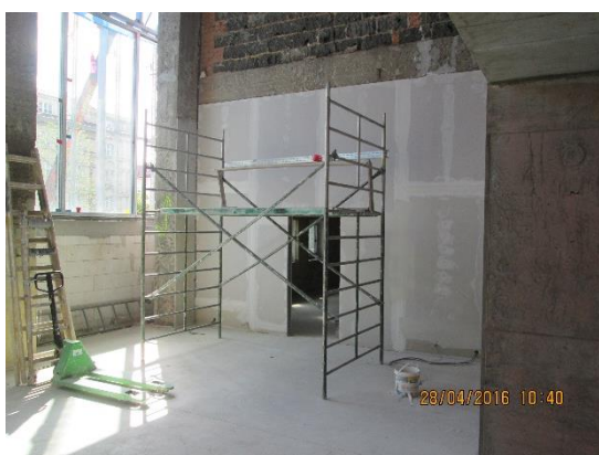
Obrázek 62 – budova B – špatná konstrukce lešení – chybí zábradlí, středový prvek a okopová lišta (archiv autora)
