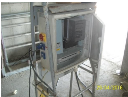
Obrázek 74 – budova B - špatně zapojené elektrické vedení – nejsou uzavřena dvířka i rozvaděče, tudíž není zabezpečeno proti neoprávněné manipulaci (Archiv autora)
