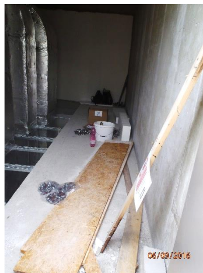
Obrázek 190 – budova A – chybí zajištění proti pádu (archiv autora)
