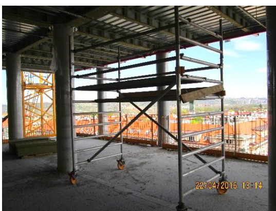
Obrázek 38 – budova A – špatná konstrukce lešení – nízké zábradlí a okopová lišta (archiv autora)
