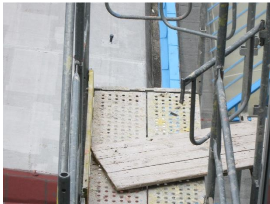
Obrázek 149 – budova A – špatná konstrukce fasádního lešení – nekvalitní nezajištěná podlážka, chybí okop (archiv autora)
