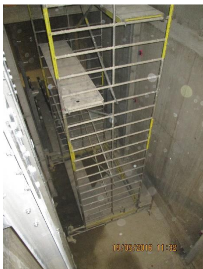
Obrázek 128 – budova A – špatná konstrukce lešení – chybí zábradlí, středový prvek a okopová lišta (archiv autora)
