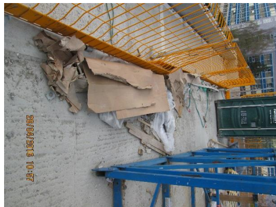
Obrázek 53 – budova A – nezabezpeč. lehký materiál proti odlétnutí, nepořádek na stavbě, špatné skladování materiálu (Archiv autora)
