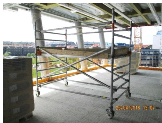
Obrázek 37 – budova A – špatná konstrukce lešení – nízké zábradlí (archiv autora)
