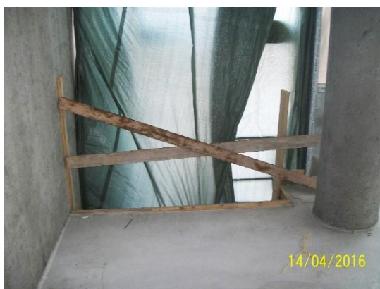
Obrázek 20 – budova A – špatná konstrukce zábradlí – není dostatečně vysoké a únosné, chybí okopová lišta (archiv autora)
