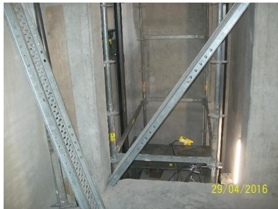
Obrázek 73 – budova A – chybí zajištění proti pádu do šachty (archiv autora)
