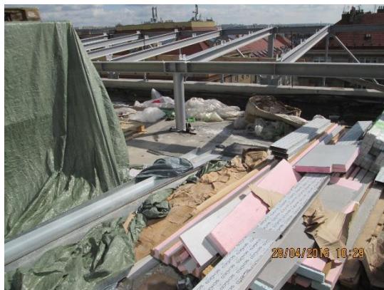
Obrázek 56 – budova B – nezabezpeč. lehký materiál proti odlétnutí, nepořádek na stavbě, špatné skladování materiálu (Archiv autora)
