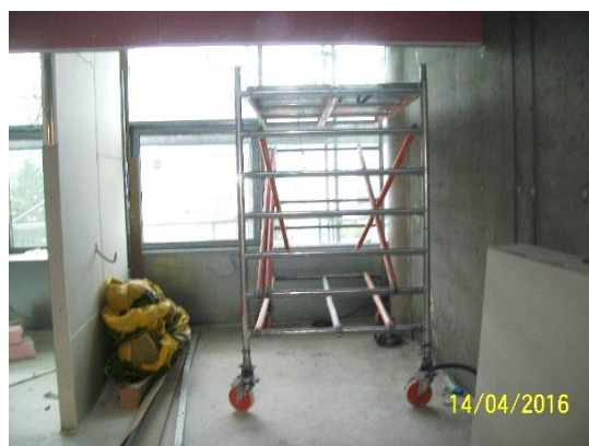
Obrázek 16 – budova B - špatná konstrukce lešení – chybí zábradlí středový prvek a okopová lišta (archiv autora)
