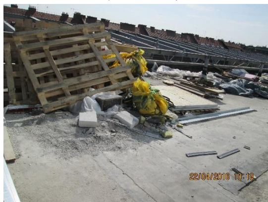
Obrázek 32 – budova B – nezabezpeč. lehký materiál proti odlétnutí, nepořádek na stavbě, špatné skladování materiálu (Archiv autora)
