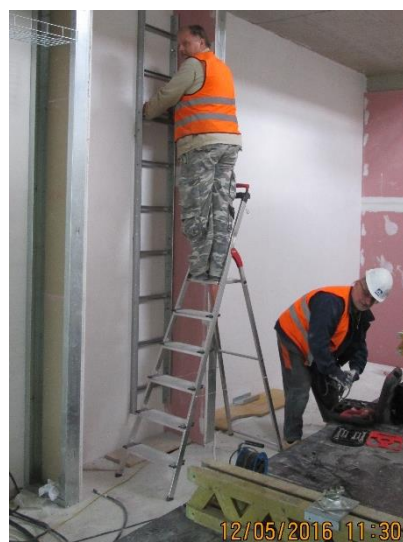
Obrázek 105 – budova A – špatné užívání schůdků, pracovník nepoužívá OOPP – pracovní helma (archiv autora)
