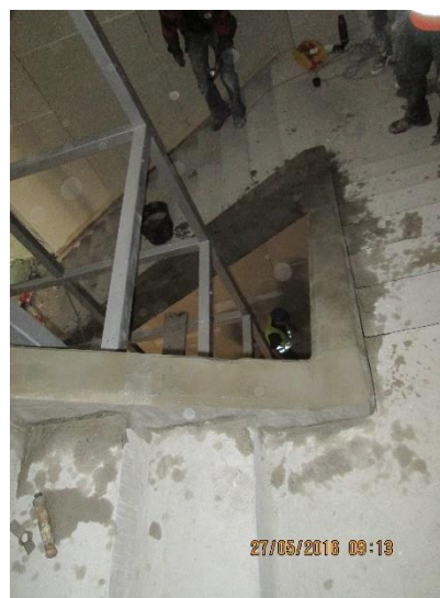
Obrázek 156 – budova B – chybí zajištění proti pádu (archiv autora)
