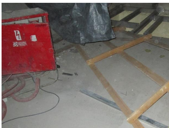
Obrázek 91 – budova B - špatně zapojené elektrické vedení – nejsou uzavřena dvířka i rozvaděče, tudíž není zabezpečeno proti neoprávněné manipulaci (Archiv autora)
