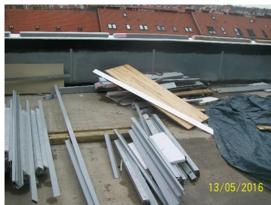
Obrázek 95 – budova B – nezabezpečený lehký materiál proti odlétnutí, nepořádek na stavbě, špatné skladování materiálu (Archiv autora)
