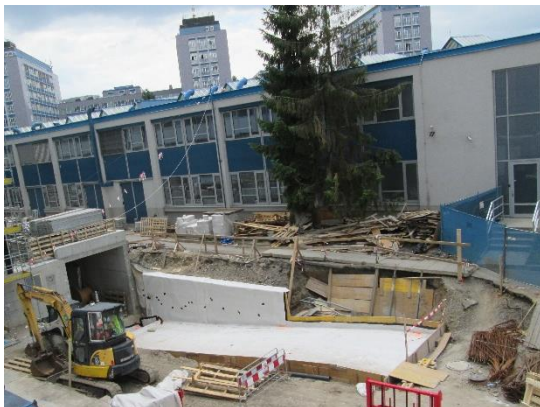
Obrázek 180 – okolí stavby – nepořádek, špatné skladování materiálu (Archiv autora)
