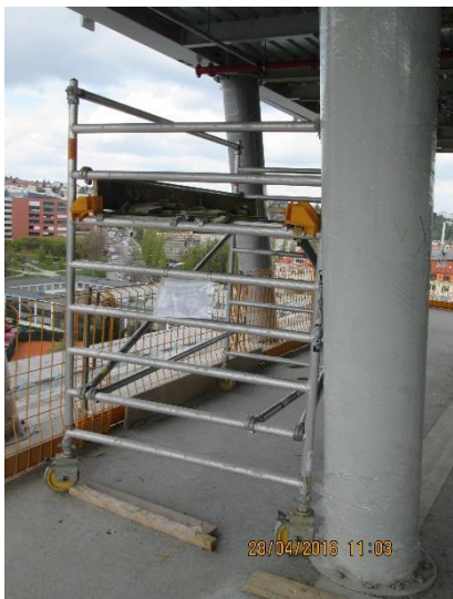
Obrázek 58 – budova A – špatná konstrukce lešení – nízké zábradlí a okopová lišta (archiv autora)
