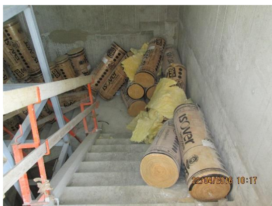
Obrázek 30 – budova A – nepořádek na stavbě, špatné skladování materiálu (Archiv autora)
