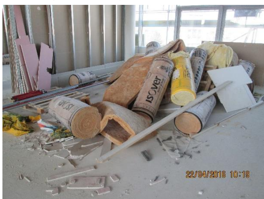
Obrázek 34 – budova B – nepořádek na stavbě, špatné skladování materiálu (Archiv autora)
