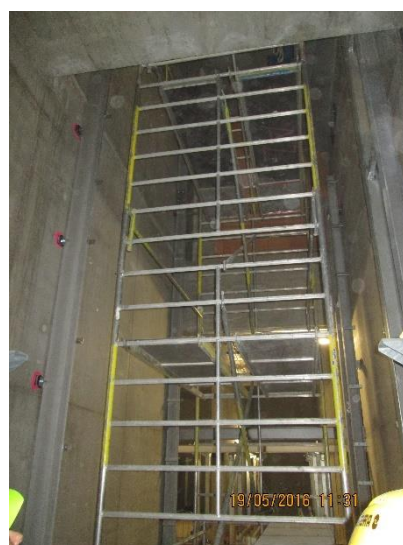
Obrázek 131 – budova A – špatná konstrukce lešení – chybí středový prvek a okopová lišta (archiv autora)
