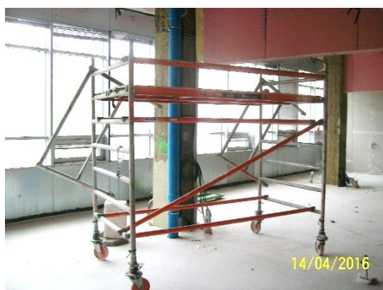
Obrázek 14 – budova B - špatná konstrukce lešení – nízké zábradlí a okopová lišta (archiv autora)
