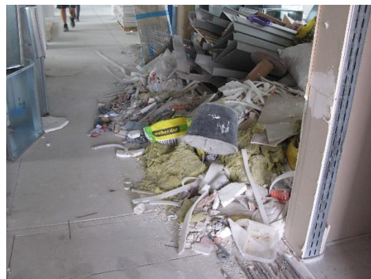
Obrázek 123 – budova A –nepořádek na stavbě, špatné skladování materiálu (Archiv autora)
