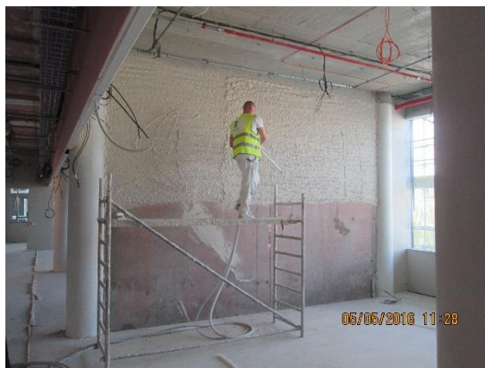
Obrázek 85 – budova A – špatná konstrukce lešení – chybí zábradlí, chybí středový prvek a okopová lišta, pracovník na lešení nepoužívá OOPP (archiv autora)
