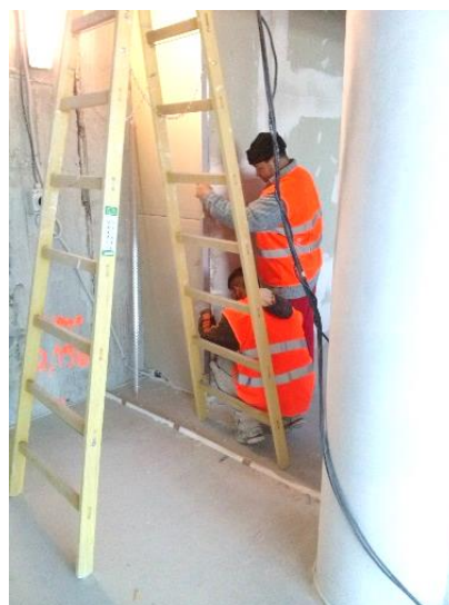
Obrázek 45 – budova B – nestabilní konstrukce žebříku, pracovníci nepoužívají OOPP – pracovní helmu (archiv autora)
