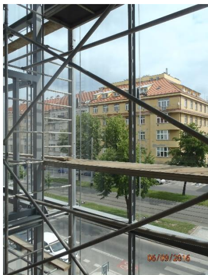
Obrázek 185 – budova A – špatná konstrukce lešení – chybí zábradlí, středový prvek a okopová lišta (archiv autora)
