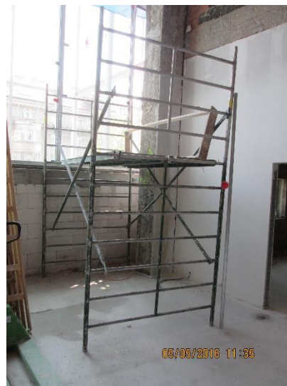
Obrázek 84 – budova B – špatná konstrukce lešení – nízké zábradlí, chybí středový prvek a okopová lišta (archiv autora)
