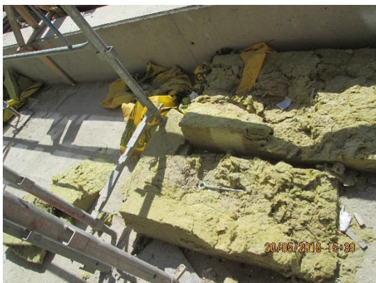
Obrázek 122 – budova A –nepořádek na stavbě, špatné skladování materiálu (Archiv autora)
