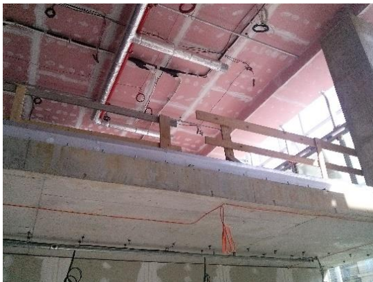
Obrázek 46 – budova B – špatná konstrukce zábradlí – není dost. vysoké a únosné, zábradlí není po celé délce hrany (archiv autora)
