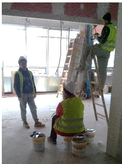
Obrázek 44 – budova B – špatné užívání dvojitého žebříku - pracovník nestojí čelně k žebříku a nedodržuje bezpečnou vzdálenost od horní hrany, nestabilní konstrukce žebříku, pracovník nepoužívá OOPP – pracovní helmu (archiv autora)
