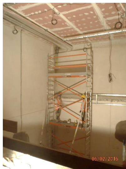
Obrázek 168 – budova B – špatná konstrukce lešení – nízké zábradlí, chybí středový prvek a okopová lišta (archiv autora)
