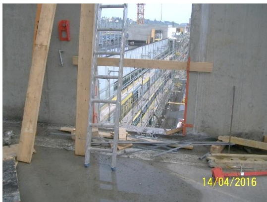
Obrázek 18 – budova A – špatná konstrukce zábradlí – není dost. únosné, chybí středový prvek a okopová lišta (archiv autora)
