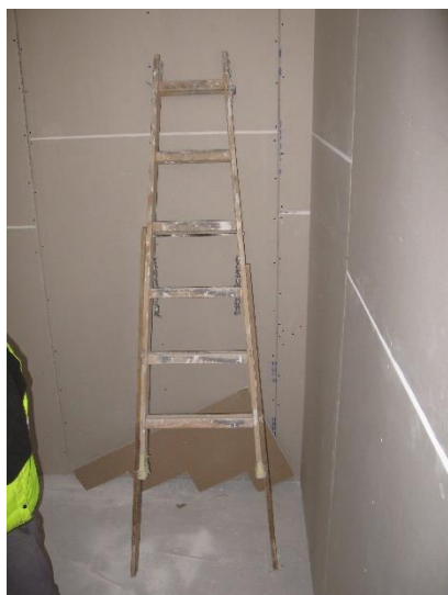
Obrázek 132 – budova A – špatná konstrukce žebříku – nestabilní, není dost. únosný (Archiv autora)
