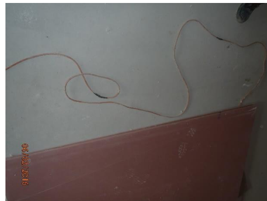
Obrázek 179 – budova B – špatně provedená oprava kabelu (Archiv autora)
