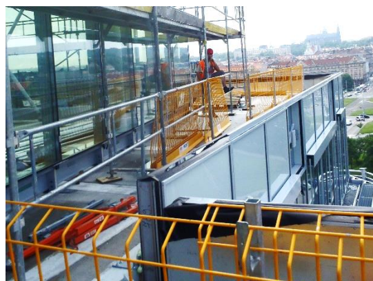
Obrázek 176 – budova A – chybí zajištění proti pádu - zajištění není po celé hraně (archiv autora)
