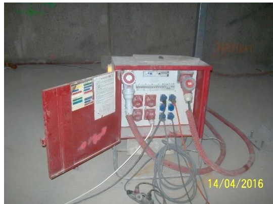
Obrázek 25 – budova A - špatně zapojené elektrické vedení – nejsou uzavřena dvířka u rozvaděče, tudíž není zabezpečeno proti neoprávněné manipulaci (Archiv autora)
