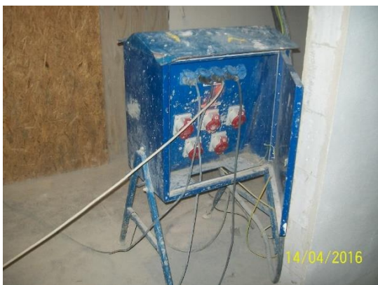
Obrázek 28 – budova B - špatně zapojené elektrické vedení – nejsou uzavřena dvířka u rozvaděče, tudíž není zabezpečeno proti neoprávněné manipulaci (Archiv autora)
