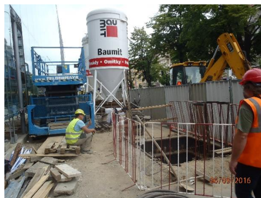
Obrázek 188 – okolí stavby – špatná konstrukce proti pádu – zábradlí není po celé délce hrany, není dostatečně únosné (archiv autora)
