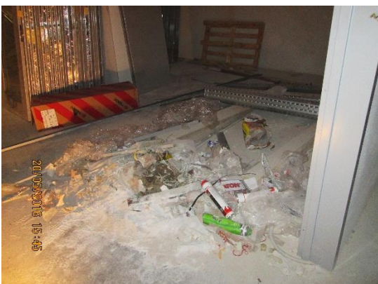
Obrázek 126 – budova B – nepořádek na stavbě, špatné skladování materiálu (Archiv autora)
