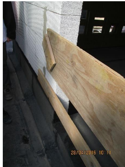
Obrázek 69 – budova B – špatná konstrukce zábradlí – zábradlí není dostatečně vysoké, ve spoji vyčnívají hřebíky – možnost zranění (archiv autora)
