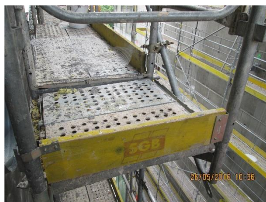
Obrázek 150 – budova A – špatná konstrukce fasádního lešení – chybí okopová lišta (archiv autora)
