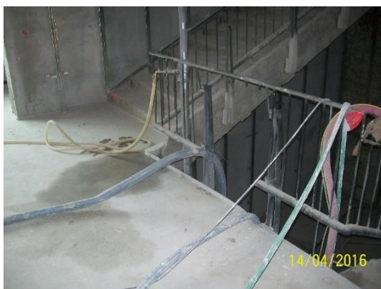
Obrázek 22 – budova B – špatná konstrukce zábradlí – není dost. únosné, chybí středový prvek a okopová lišta (archiv autora)
