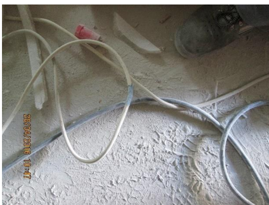
Obrázek 76 – budova B – špatně provedená oprava kabelu (Archiv autora)
