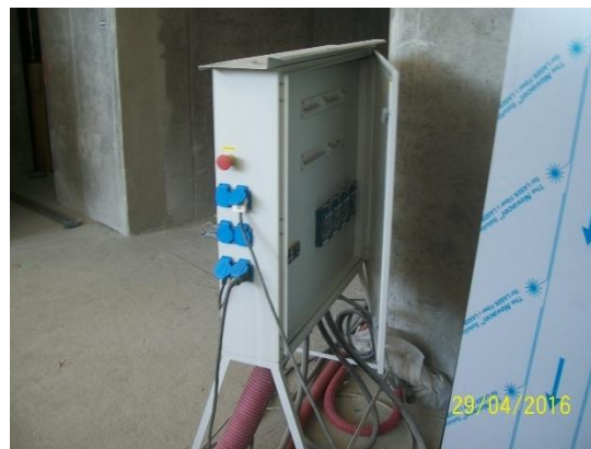
Obrázek 75 – budova B - - špatně zapojené elektrické vedení – nejsou uzavřena dvířka i rozvaděče, tudíž není zabezpečeno proti neoprávněné manipulaci (Archiv autora)
