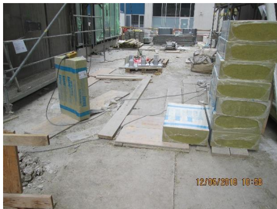
Obrázek 92 – okolí stavby – nepořádek na stavbě, špatné skladování materiálu (Archiv autora)
