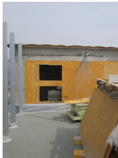
Obrázek 137 – budova B – chybí zajištění proti pádu do otvorů (archiv autora)
