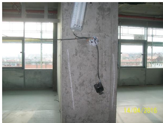
Obrázek 27 – budova B – elektrické zařízení je ve nevhovujícím stavu (Archiv autora)
