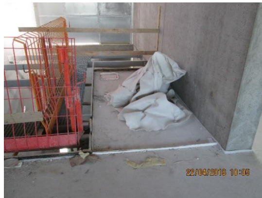
Obrázek 47 – budova B – špatná konstrukce zábradlí – není dost. únosné, nemá dostatečnou výšku (archiv autora)
