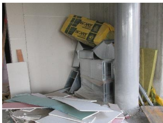
Obrázek 31 – budova A – nepořádek na stavbě, špatné skladování materiálu (Archiv autora)
