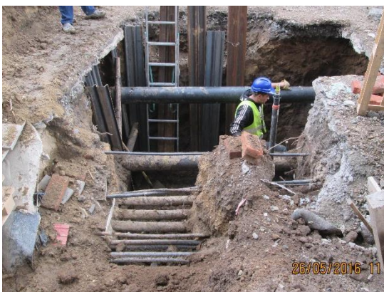
Obrázek 161 – okolí stavby – chybí zajištění proti pádu, pracovníci nepoužívají OOPP (archiv autora)
