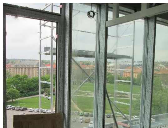
Obrázek 101 – budova A – špatná konstrukce lešení – špatně zajištěné, chybí středový prvek a okopová lišta, (archiv autora)
