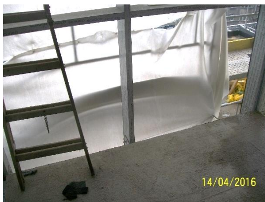
Obrázek 23 – budova B – špatná zajištění proti pádu – chybí zábradlí, středový prvek a okopová lišta (archiv autora)
