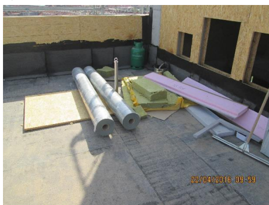
Obrázek 49 – budova B – chybí zajištění proti pádu do otvorů (archiv autora)
