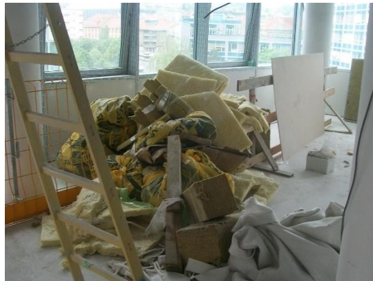
Obrázek 78 – budova A – nepořádek na stavbě (Archiv autora)
