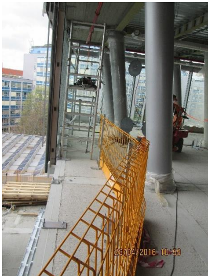
Obrázek 68 – budova A – špatná konstrukce zábradlí – zábradlí není po celé délce hrany (archiv autora)
