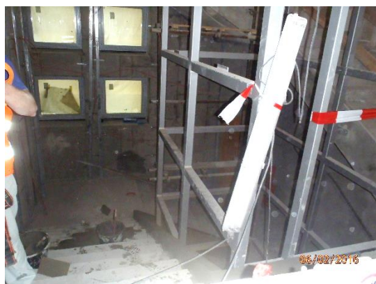
Obrázek 177 – budova B – chybí zajištění proti pádu (archiv autora)
