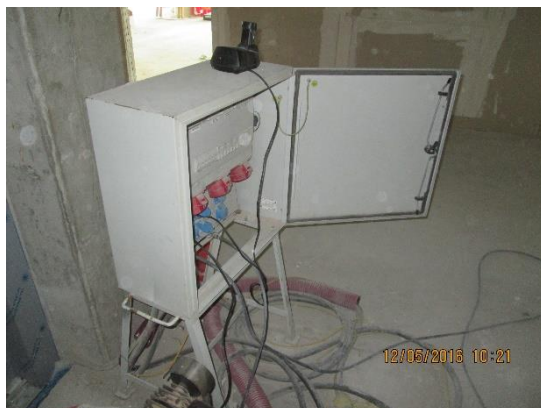
Obrázek 118 – budova B - špatně zapojené elektrické vedení – nejsou uzavřena dvířka i rozvaděče, tudíž není zabezpečeno proti neoprávněné manipulaci (Archiv autora)
