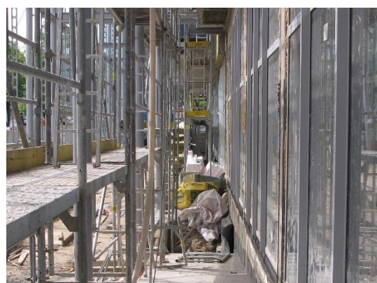
Obrázek 125 – budova B –nepořádek na stavbě, špatné skladování materiálu (Archiv autora)
