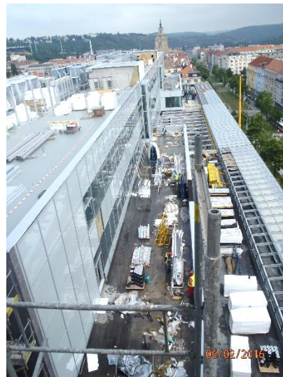
Obrázek 163 – okolí stavby – nepořádek, špatné skladování materiálu (Archiv autora)
