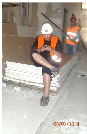
Obrázek 173 – budova B – pracovník nepoužívá OOPP – nevhodná obuv na stavenišť (archiv autora)
