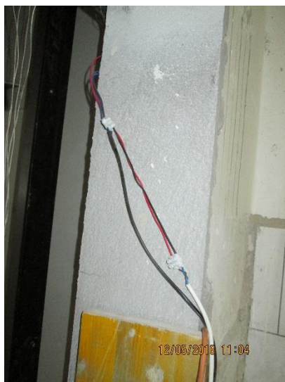
Obrázek 120 – budova B – porušené elektrické zařízení, nevhodně zvolené na stavbu (Archiv autora)
