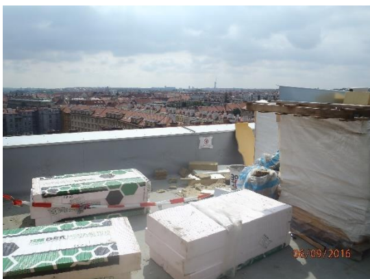
Obrázek 182 – budova B – nepořádek, špatné skladování materiálu, nezabezpečený materiál proti odlétnutí (Archiv autora)
