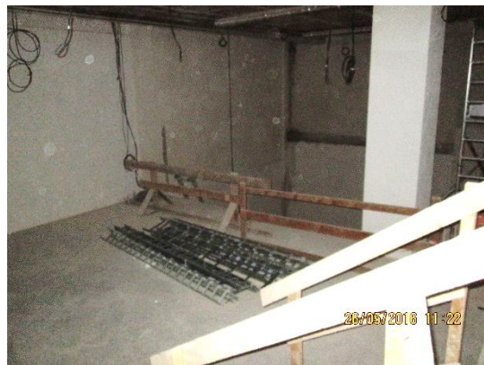
Obrázek 158 – budova B – špatná konstrukce zábradlí – není dostatečně únosné a vysoké, chybí okopová lišta, zábradlí není po celé délce hrany (archiv autora)
