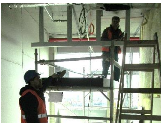
Obrázek 40 – budova B – špatná konstrukce lešení – nízké zábradlí, chybí středový prvek, pracovník na lešení nepoužívá OOPP – pracovní helmu (archiv autora)
