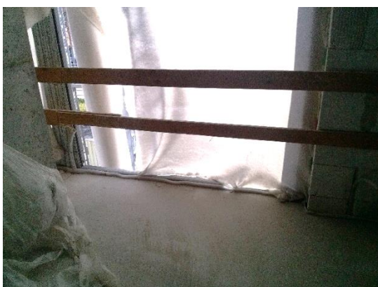
Obrázek 48 – budova B – špatná konstrukce zábradlí – není dost. únosné, nemá dostatečnou výšku, chybí okopová lišta (archiv autora)
