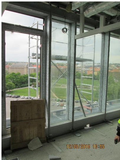
Obrázek 114 – budova A – otvor není dostatečně zajištěný proti pádu – nesplňuje normové požadavky, špatně zvolená konstrukce zajištění (archiv autora)
