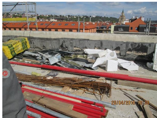
Obrázek 57 – budova B – nezabezpeč. lehký materiál proti odlétnutí, nepořádek na stavbě, špatné skladování materiálu – hl. výztuže (Archiv autora)
