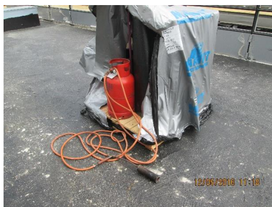
Obrázek 93 – budova B – nepořádek na stavbě, špatné skladování materiálu (Archiv autora)
