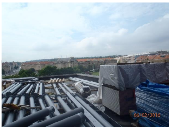
Obrázek 174 – budova A – chybí zajištění proti pádu (archiv autora)
