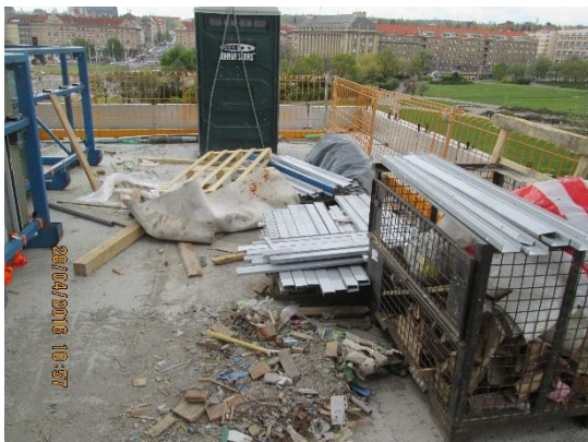
Obrázek 52 – budova A – nezabezpeč. lehký materiál proti odlétnutí, nepořádek na stavbě, špatné skladování materiálu (Archiv autora)
