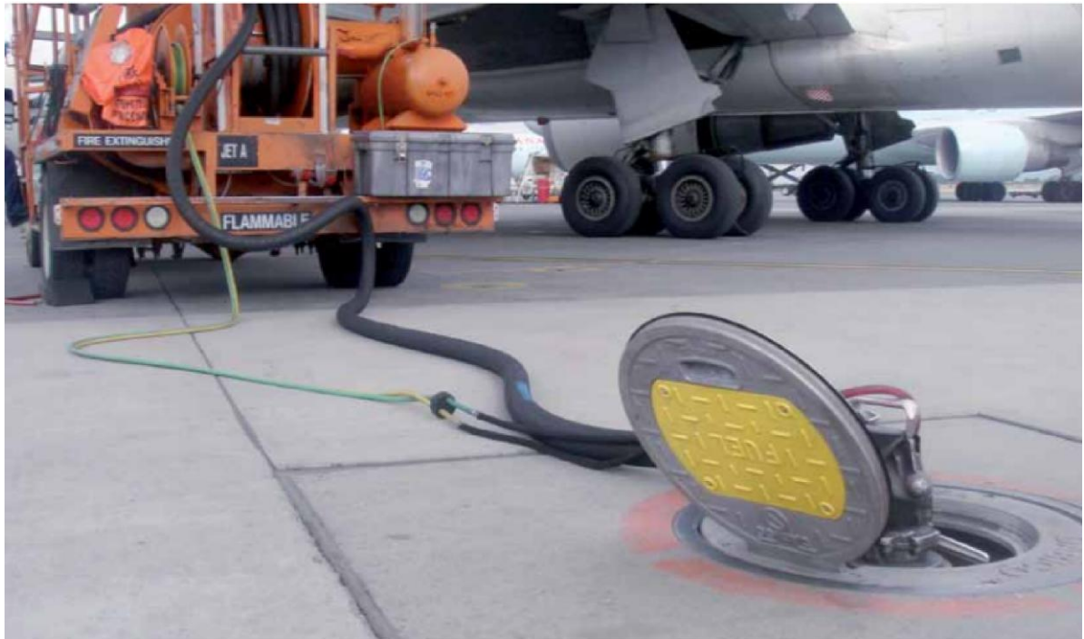
Obrázek 11 - Hydrantový ventil na odbavovací ploše zdroj: Cavotec Market Unit Brochure [38]
