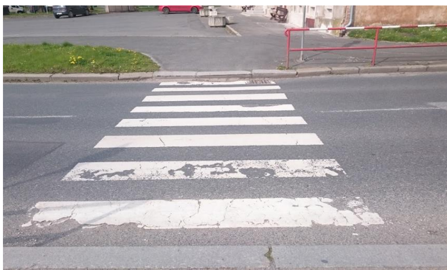
Obr. 42: Opotřebované VDZ na a v okolí přechodu v prostoru před zámkem
