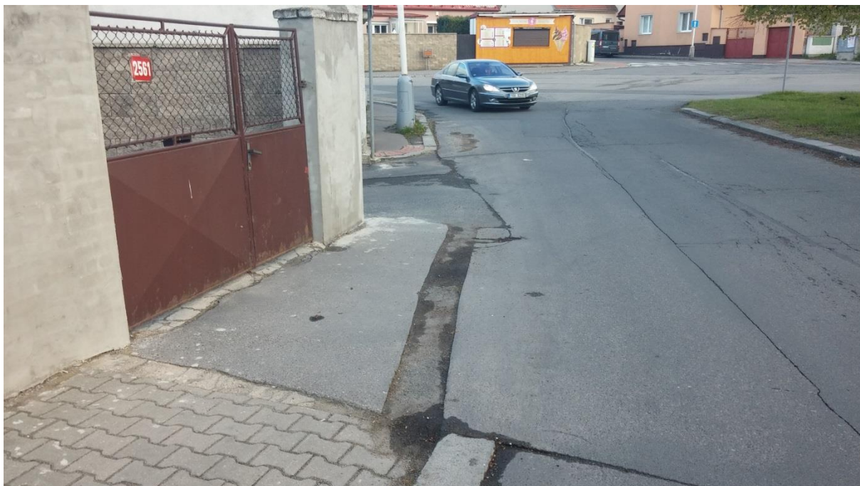
Obrázek 13 - Nedostatečná šířka chodníku větve ústící do ulice Šachetní [autor]
