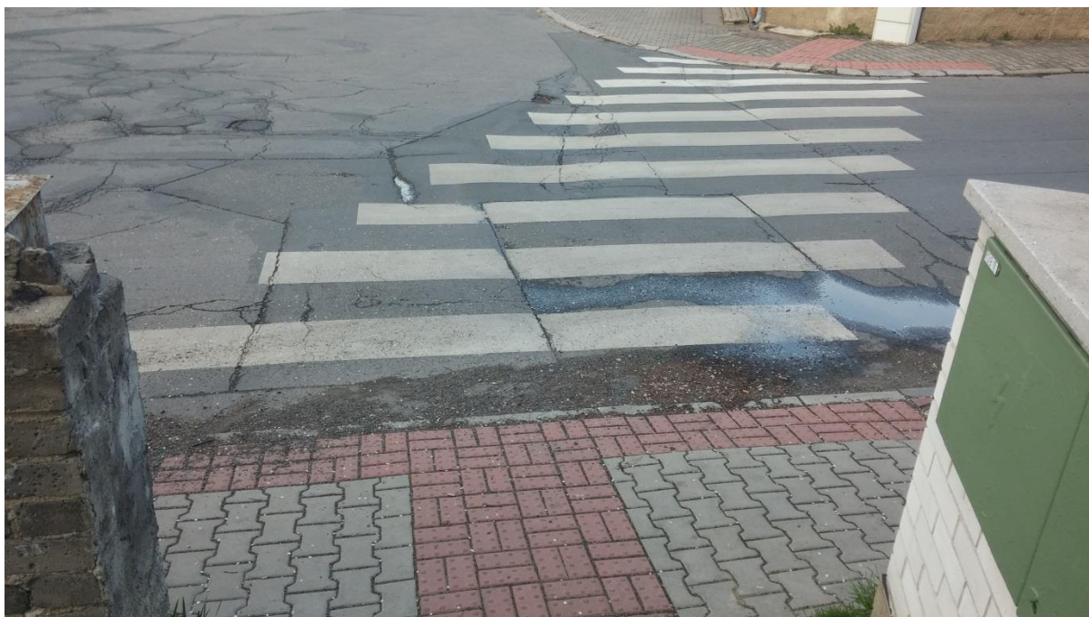
Obrázek 12 - Špatné provedení přechodu pro chodce [autor]
