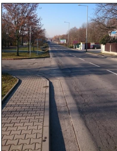
Obrázek 39: Vyjeté koleje v krytu vozovky.
