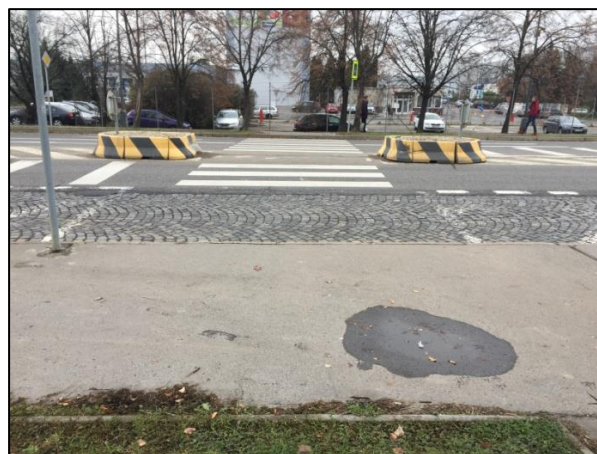
Obrázek 57: Přechod přes zastávkový záliv a chybějící prvky pro OsOSP a O.
