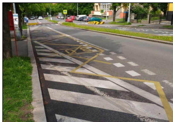
Obrázek 31: Pohled na problémové VDZ v prostoru autobusové zastávky Pod Pekařkou.
