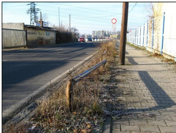
Obrázek 49: Kovové zábradlí po kolizi.
