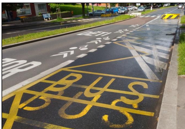
Obrázek 30: Pohled na problémové VDZ v prostoru autobusové zastávky Pod Pekařkou.
