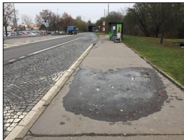
Obrázek 59: Chybějící prvky pro OsOSPao na autobusové zastávce Sídliště Jahodnice.
