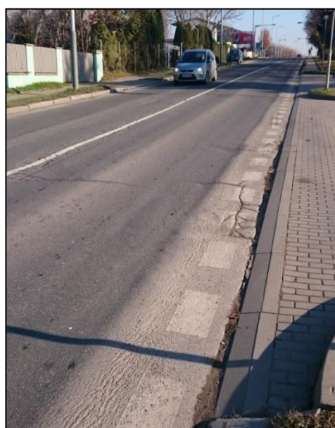
Obrázek 40: Vyjeté koleje v krytu vozovky.
