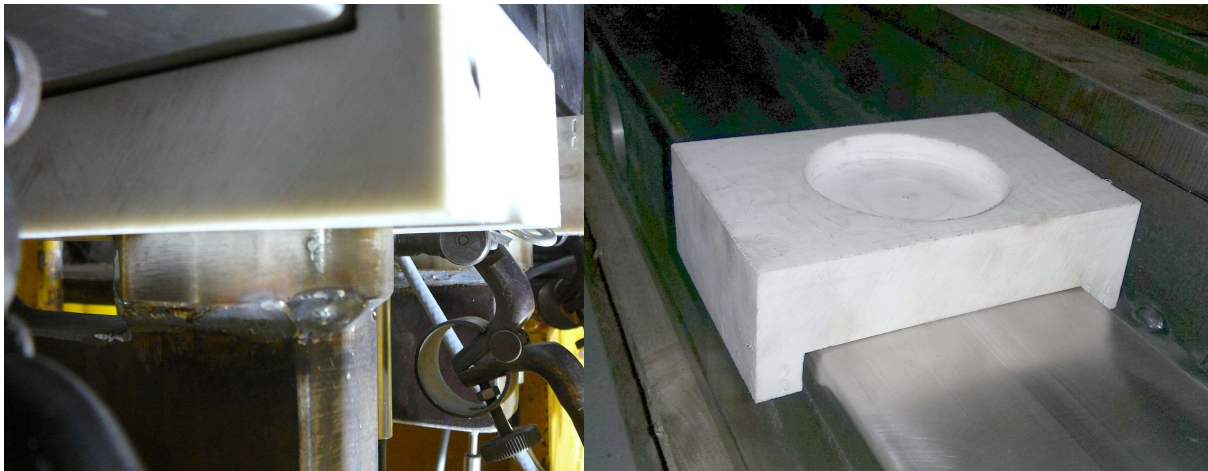
Obr. 34: Vlevo dolní kluzný blok mezi traverzou a úchytem, patrná vůle v uložení, vpravo kluzný blok mezi traverzou a lamelou, po osazení lamely plně dotlačen
