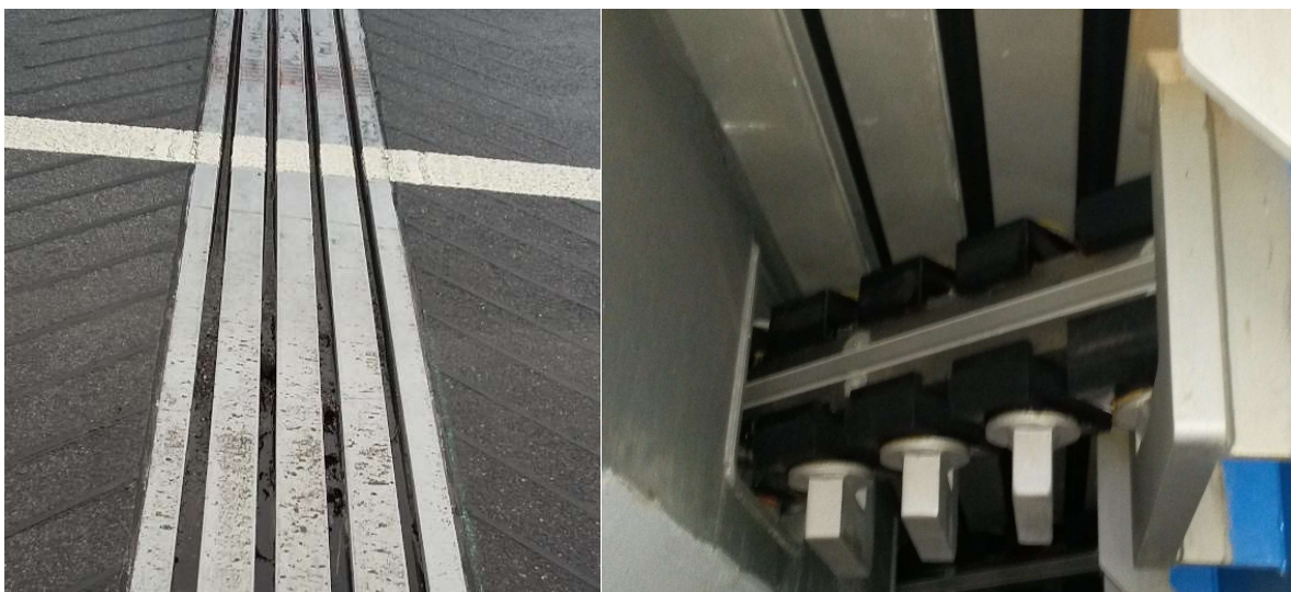
Obr. 16: Vlevo pohled shora na MZ na mostě přes Černovický potok, vpravo roznášecí mechanismus na dálničním mostě přes Ohři
