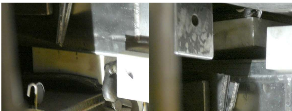
Obr. 91: Vlevo deformovaný úložný elastomer, vpravo vzniklá vůle nad traverzou
