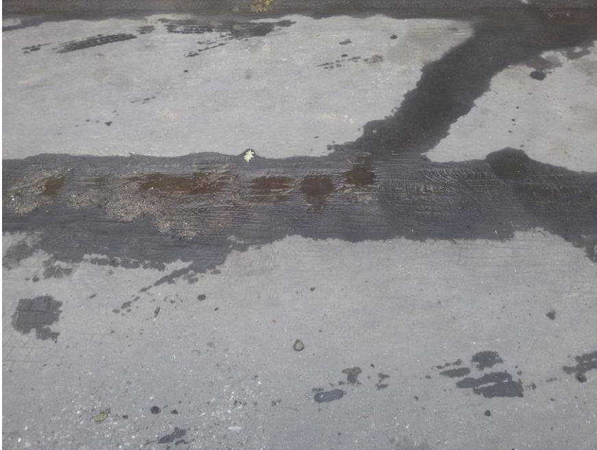
Obr. 12: Trvalé deformace v parkovacím pruhu
