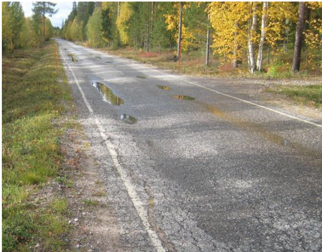
Obr. 30: Plastická deformace podloží [111]
