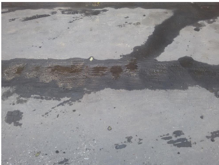
Obr. 34: Trvalé deformace v parkovacím pruhu - litý asfalt
