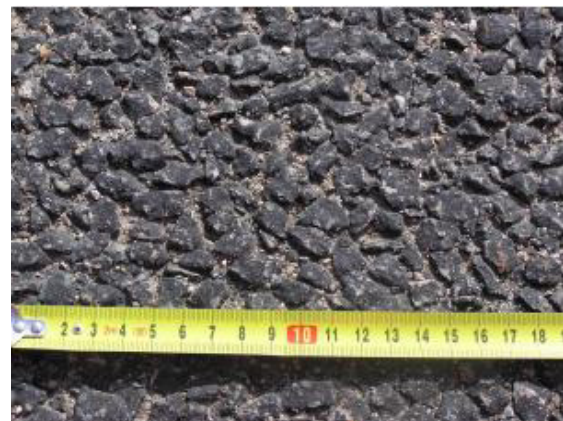
Obr. č.9: Detail zaneseného drenážního koberce [22]
