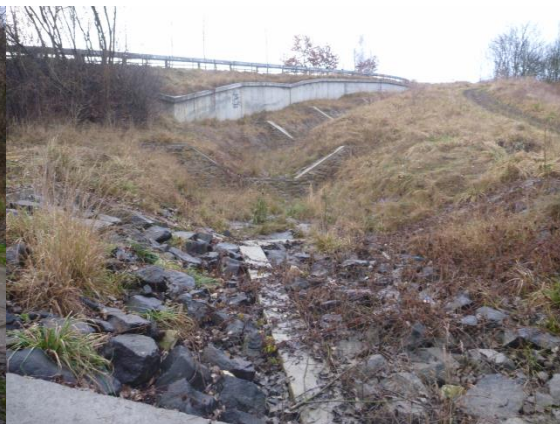
Foto 10 - přítok z výsypky
