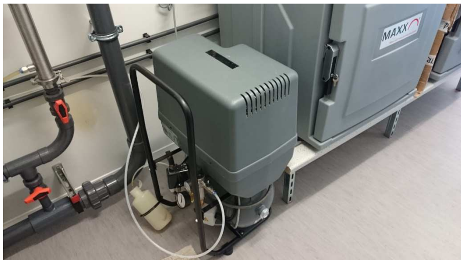
Příloha 12 - Kompresor zajišťující profuk tangenciálního filtru
