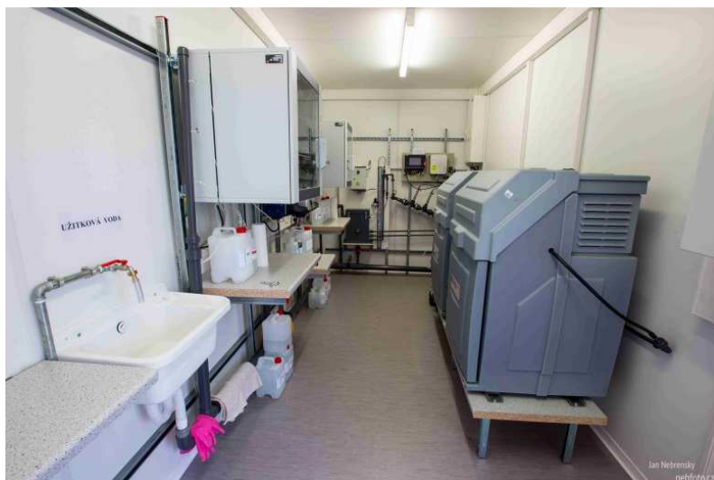
Obr. 4.6 – Řešení interiéru monitorovací stanice
