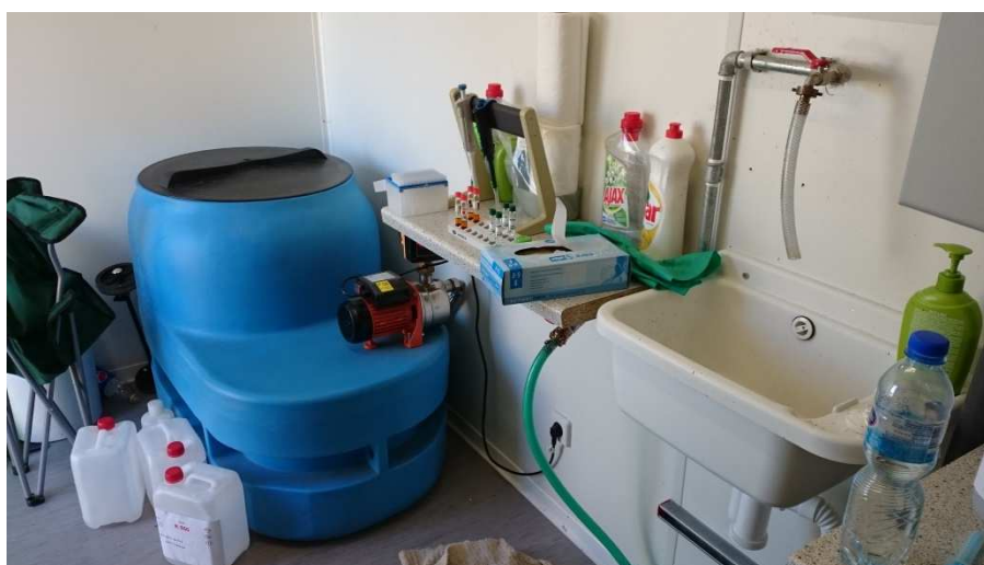
Příloha 11 – Nádrž na užitkovou vodu s čerpadlem
