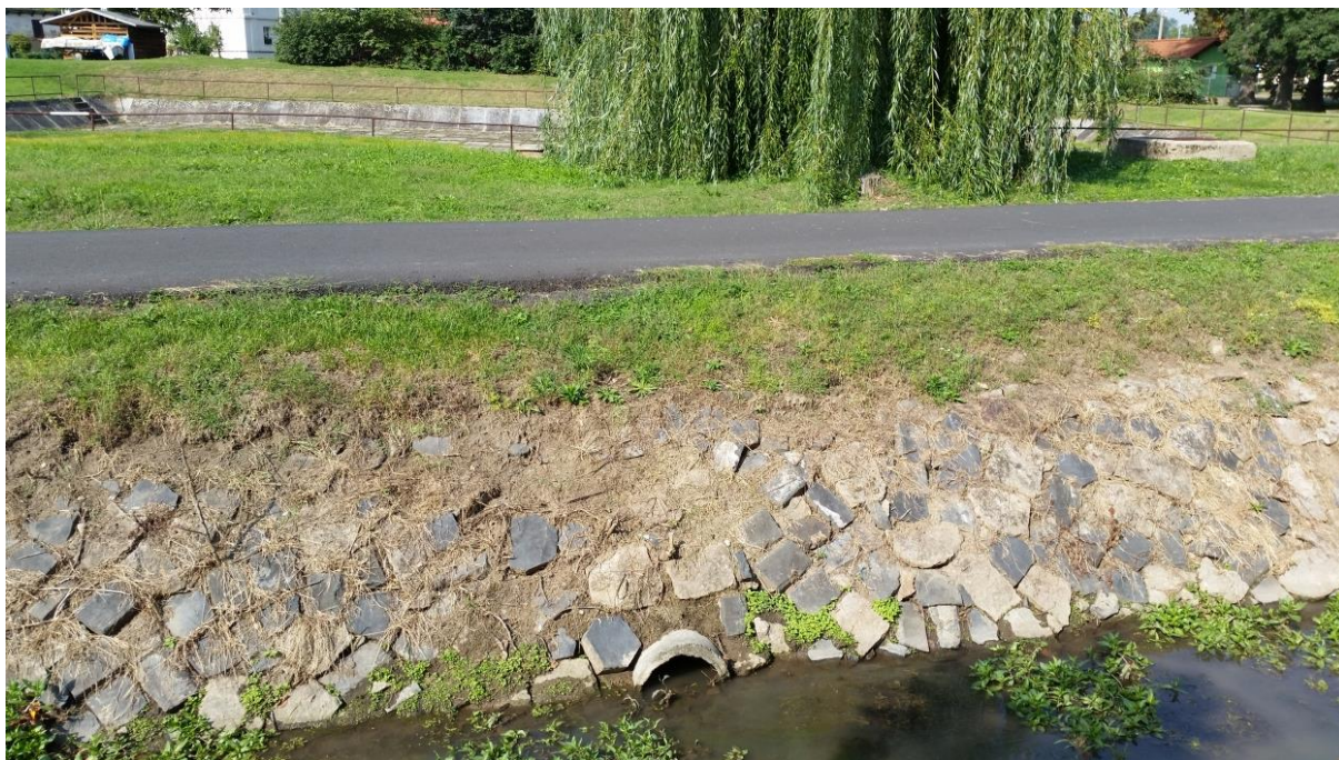
Obr. č.5: Pohled na výpouštěcí potrubí z nádrže do koryta vodního toku
