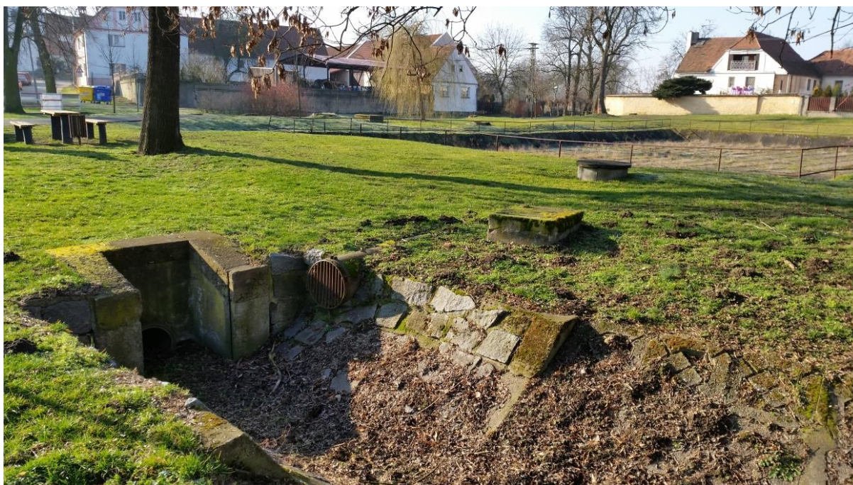
Obr. č.8: Stávající odběrný objekt nádrže z koryta toku, dnes již nefunkčního
