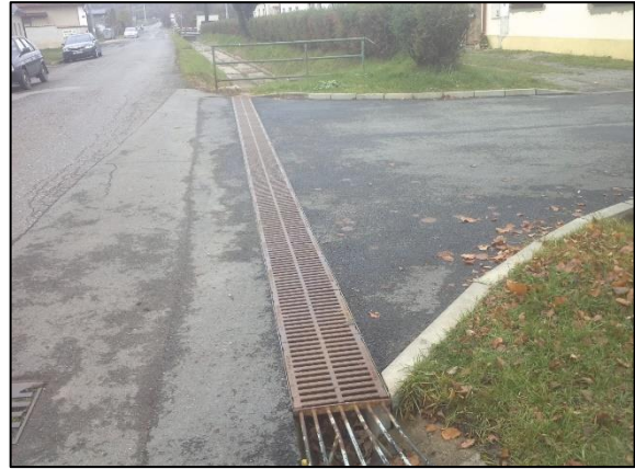
Obr. 8 - Krytý žlábek na křížení ulice 9. Května a ulice Na Rybníkách
