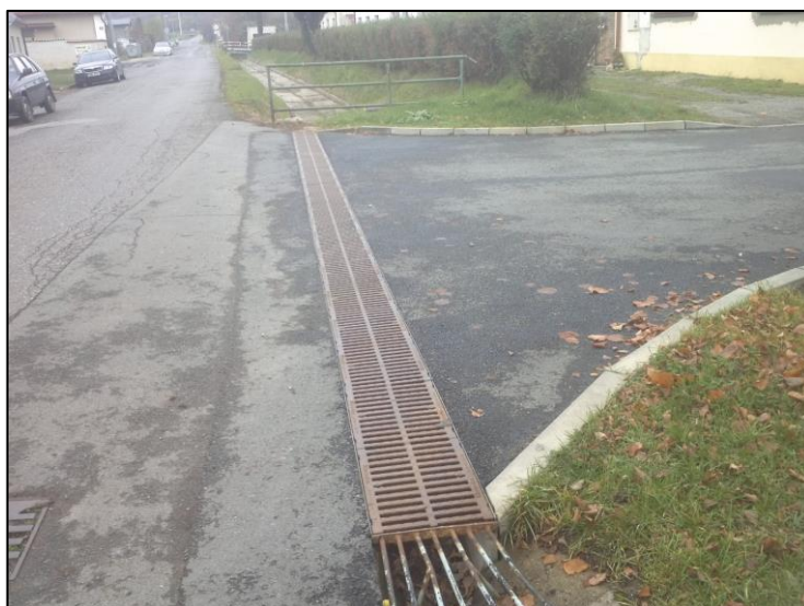
Obr. 22 – Krytý žlábek na křížení ulice 9. Května a ulice Na Rybníkách
