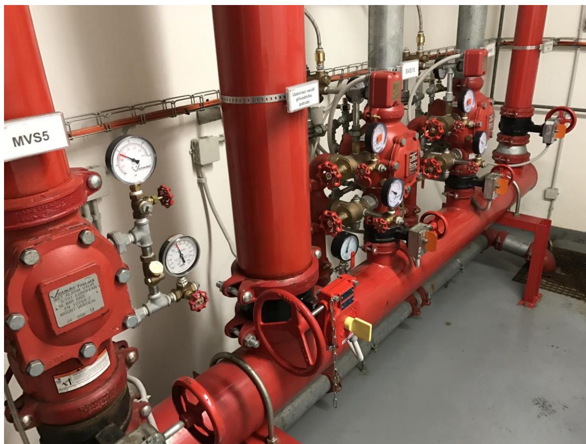
Obrázek 23 – Ventilová stanice SHZ
