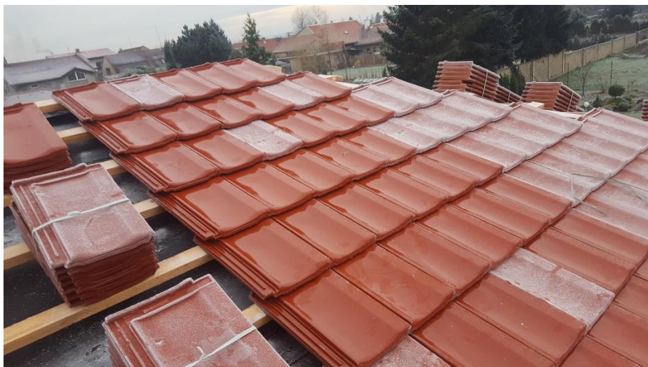
Obrázek č. 4 Namrzlá střešní krytina
