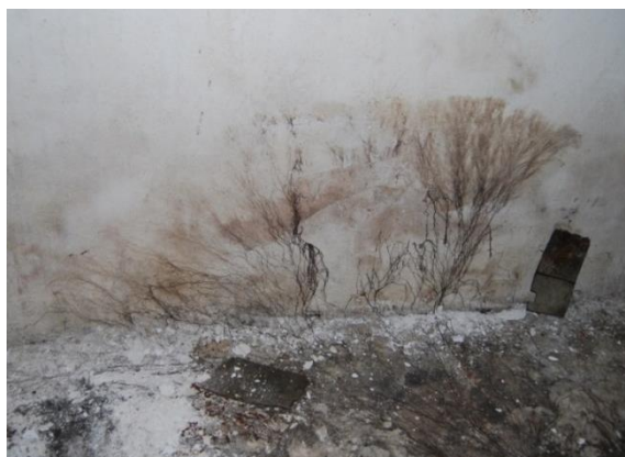
Obr. 16 – Vlákňitý porost na zdi v suterénu
