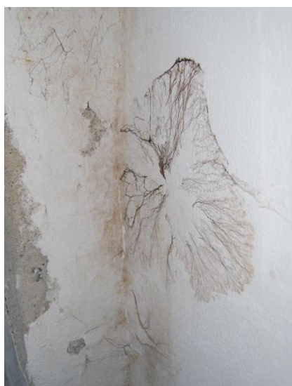
Obr. 17 – Vlákňitý porost na zdi v suterénu
