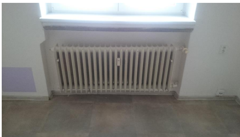
Obrázek 54: Litinové článkové otopné těleso osazené termostatickou hlavicí.
