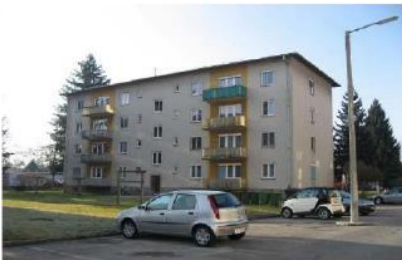
Obrázek 24: Bytový dům z šedesátých let v Grazu (Rakousko) před rekonstrukcí (IEA ECBCS Annex 50). [9]
