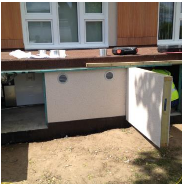
Obrázek 39: Před budou byl přistavěn zateplený box pro vzduchotechnickou jednotku. Zdroj tepla je řešen individuálně v rámci bytů v podobě kotlů na zemní plyn napojených na stávající otopnou soustavu s radiátory [34].
