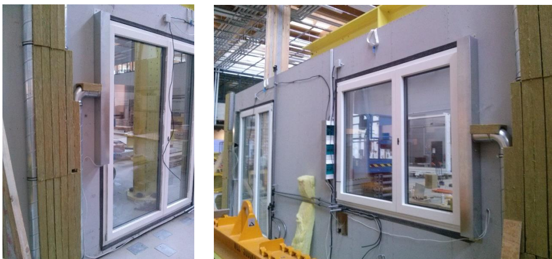
Obrázek 61: Kruhové vzduchotechnické potrubí vedeno ve vrstvě tepelné izolace, zakončené v technickém boxu zabudovaném vedle rámu okna nebo balkonových dveří [36].
