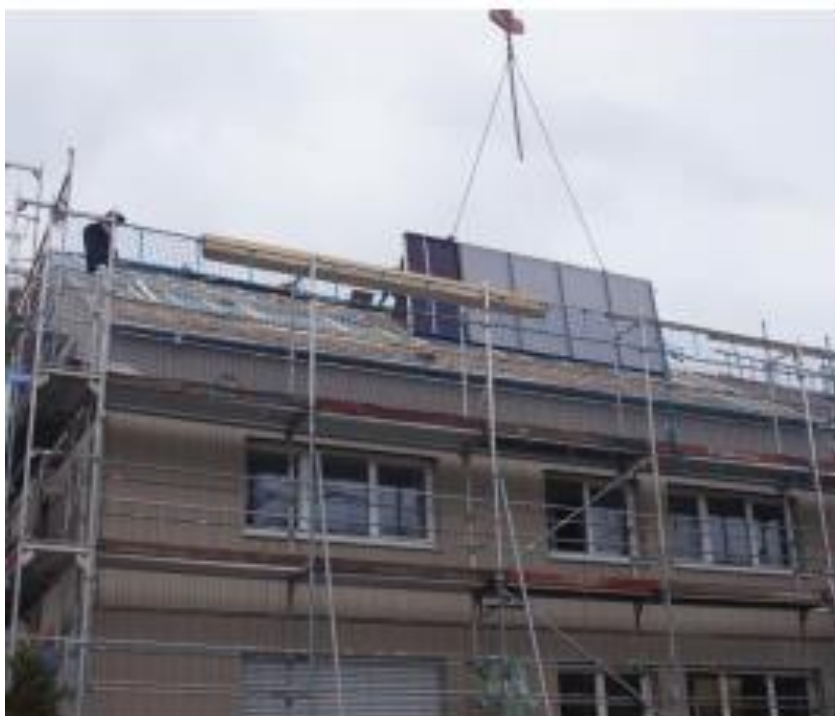
Obrázek 46: Instalace 11,3 m 2 solárních panelů na střechu. Zdrojem tepla pro vytápění je tepelné čerpadlo vzduch-voda [31].
