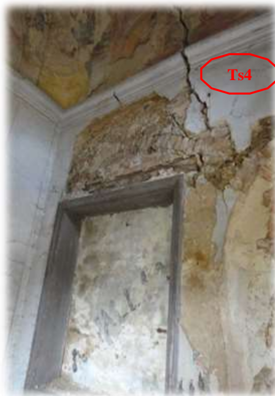
Obrázek 31 - Trhlina Ts4 ve věži 2.04
