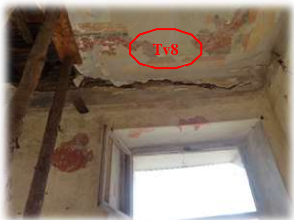
Obrázek 34 - Trhlina Tv8 v místnosti 2.10
