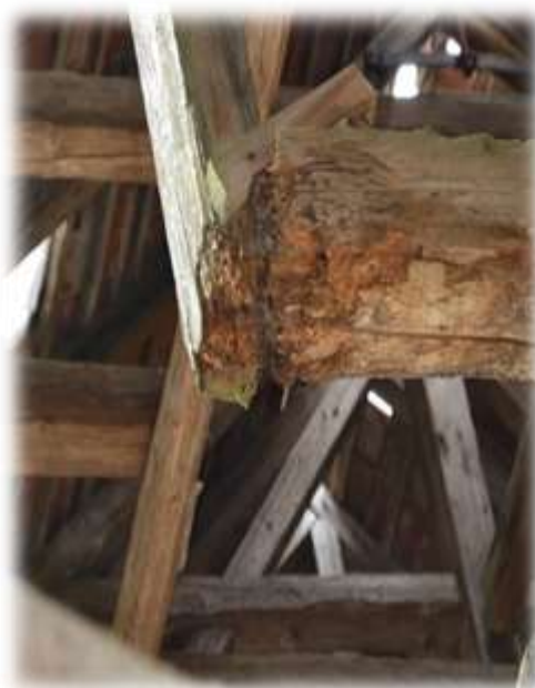
Obrázek 55 - Hniloba dřevěného vazného trámu
