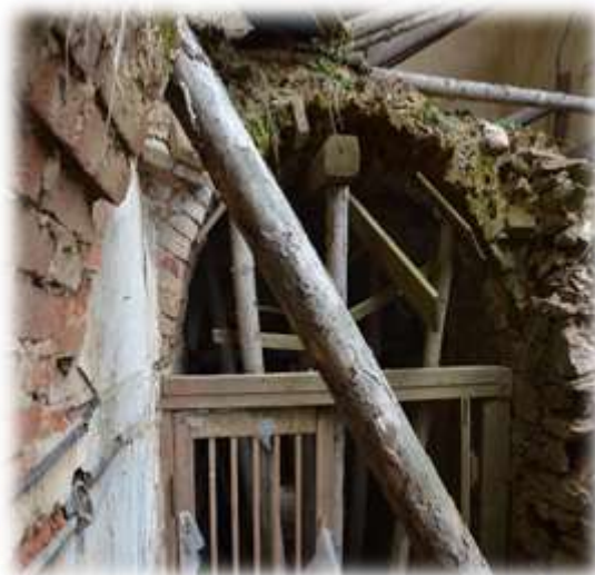
Obrázek 58 – Porušené dveře v chodbě 1.14
