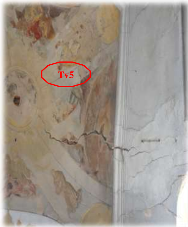
Obrázek 36 - Trhlina Tv5 ve věži 2.04
