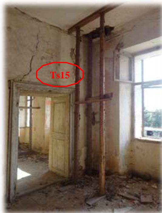
Obrázek 29 - Trhliny Ts15 v nadpraží místnosti 2.13
