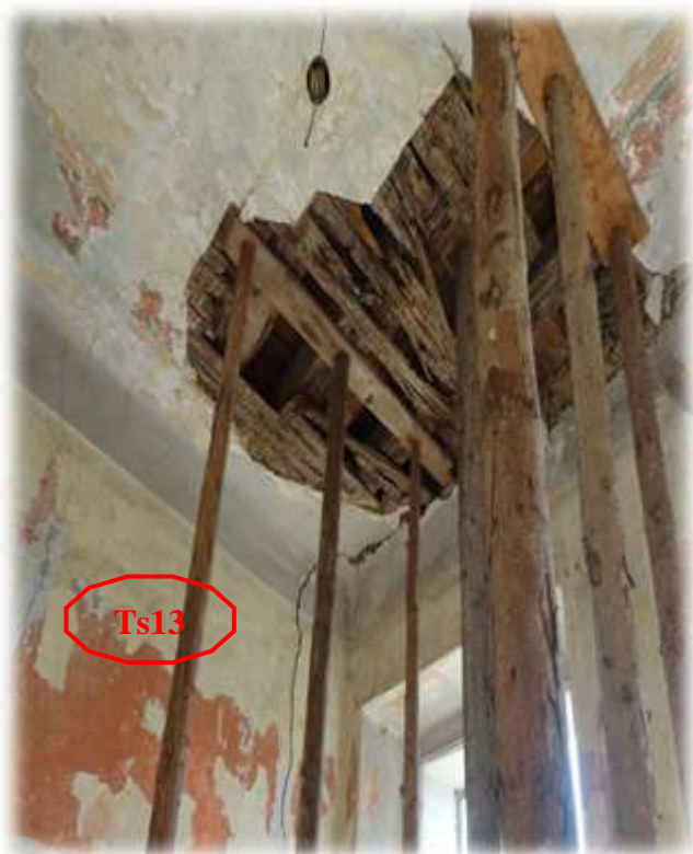
Obrázek 30 - Trhlina Ts13 v místnosti 2.10
