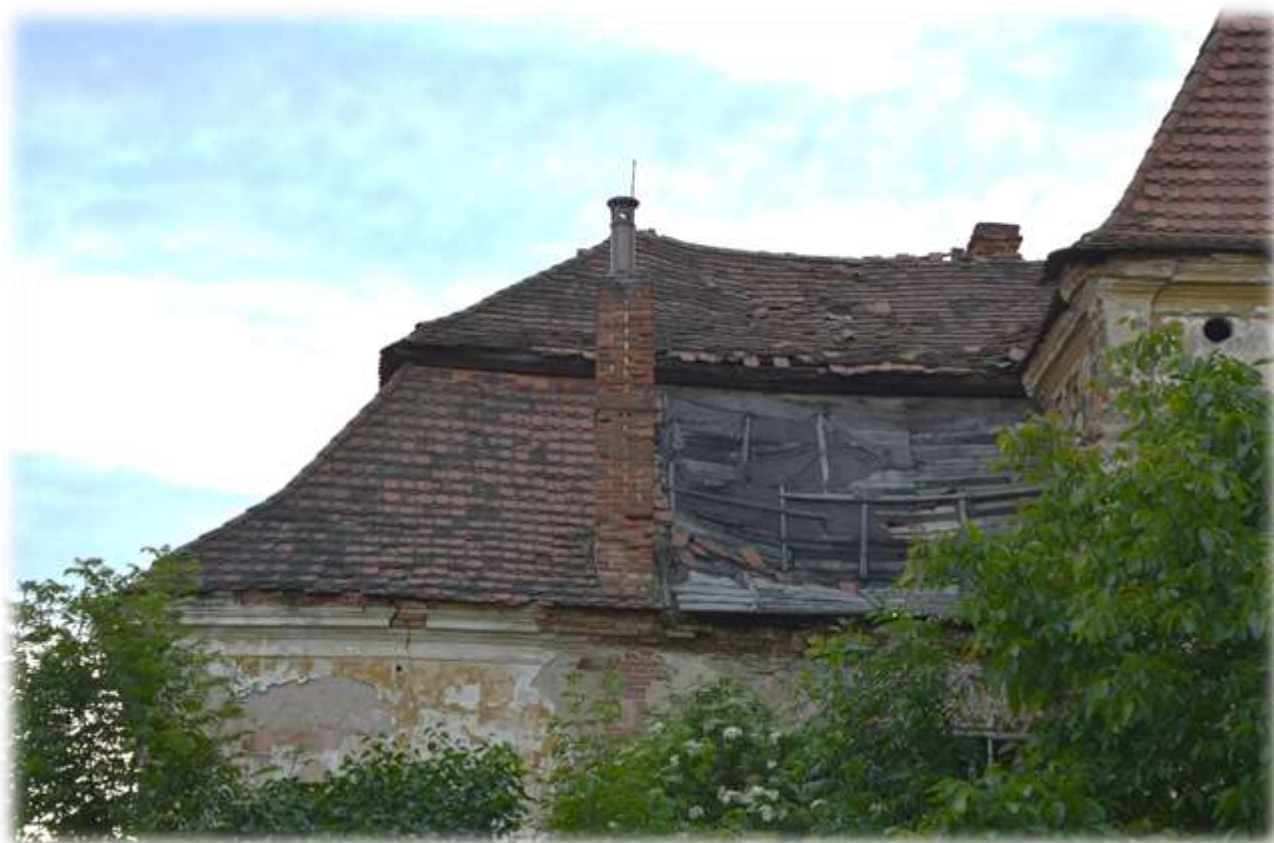
Obrázek 44 - Chybějící střešní krytina východní části jižního křídla zámku
