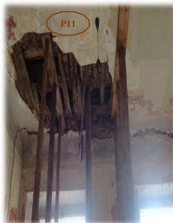
Obrázek 39 - Propad stropní kce P11 v místnosti 2.09
