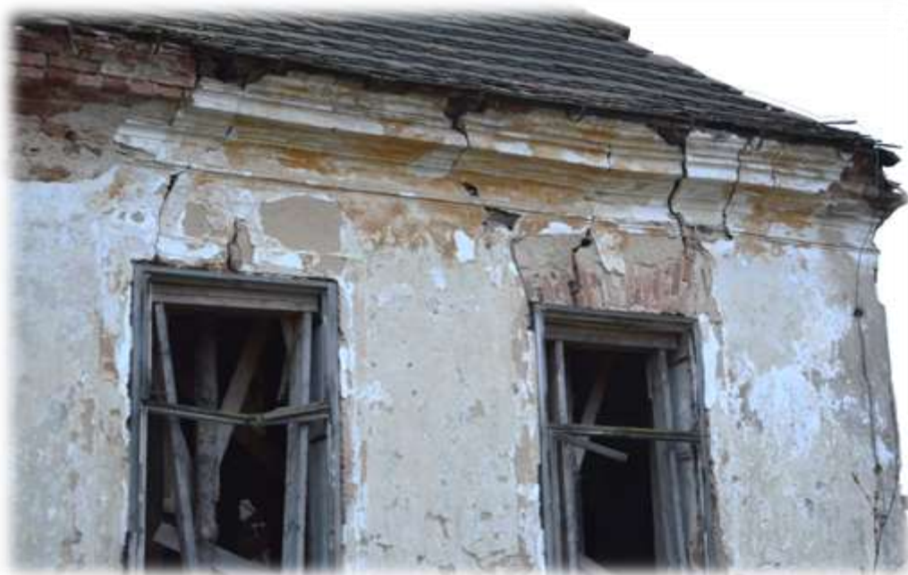
Obrázek 47 - Prohnilé dřevěné okenní rámy a trhliny
