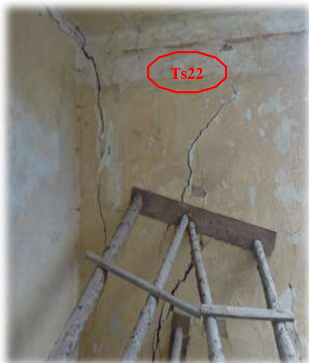
Obrázek 28 - Trhliny Ts22 v místě schodiště 1.14
