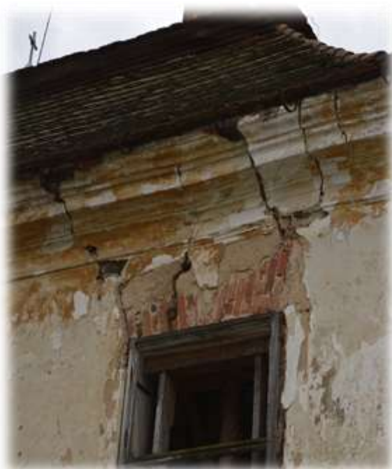
Obrázek 51 - Tahové trhliny na římse
