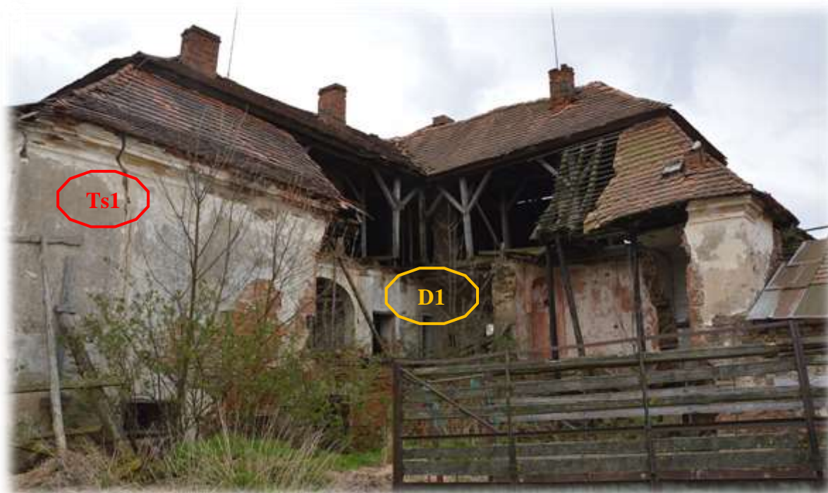
Obrázek 27 - Trhlina Ts1 v obvodovém zdivu a destrukce zdiva ve vnitřním průčelí
