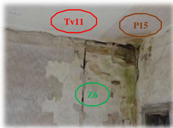
Obrázek 35 - Trhlina Tv11 a otvor P15 v místnosti 2.13
