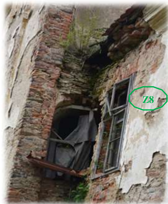
Obrázek 52 - Obvodové zdivo porušeno rostlinami
