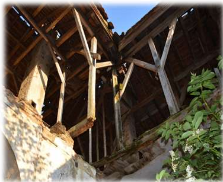
Obrázek 56 - Hniloba vazného trámu a sloupku v místě zřícení severozápadního průčelí
