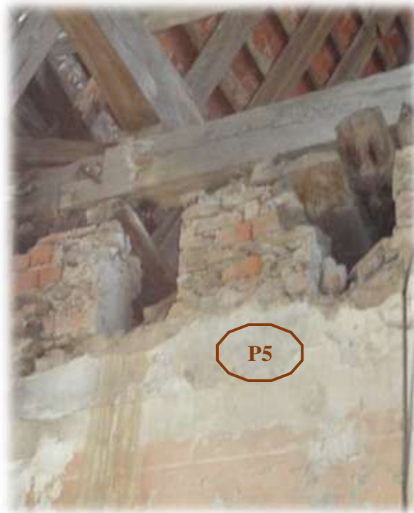
Obrázek 37 – Zřícení části stropní kce P5 v místnosti 2.05
