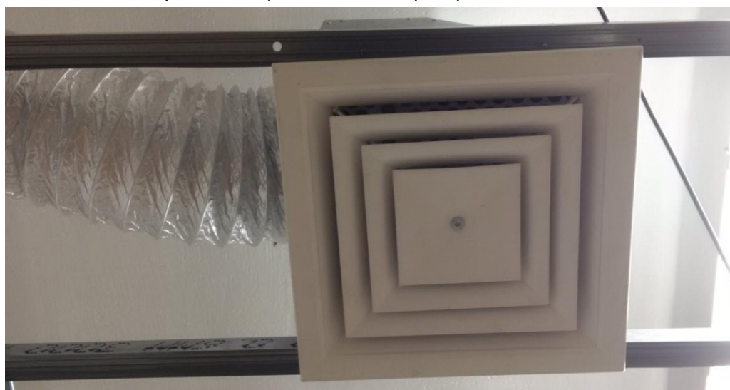
Obr. 2. 10 Měřená vyústka - lamelový anemostat s plenum boxem, foto autor
