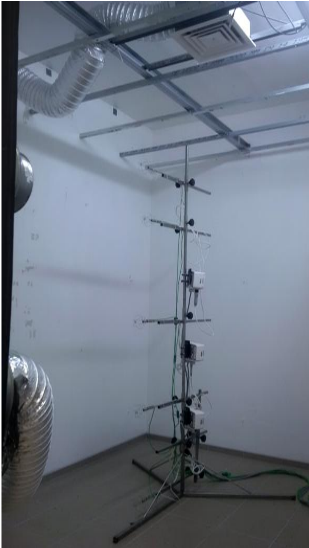
Obr. 4.7 Měřící sestava, vlevo přívod/odvod, anemostat, stojan s měřicími přístroji, foto autor
