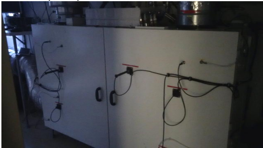
Obr. 4.3 Vzduchotechnická jednotka, foto autor
