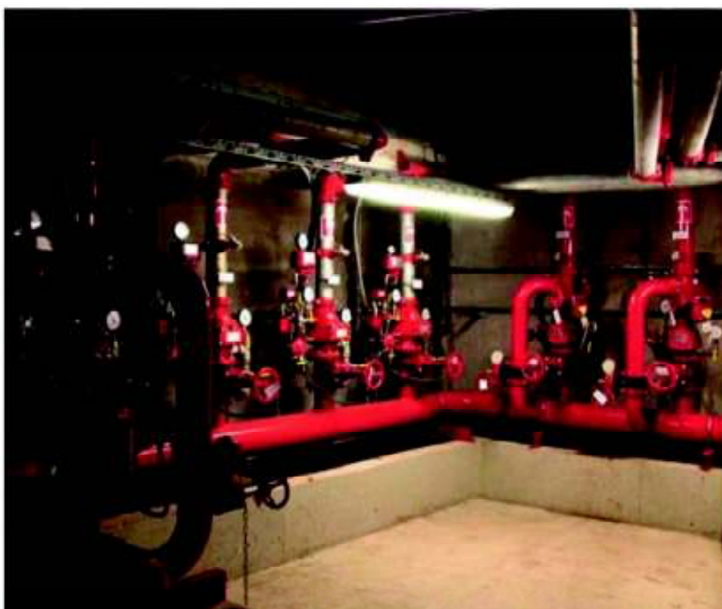
Obrázek 17: Strojovna stabilního hasicího zařízení
