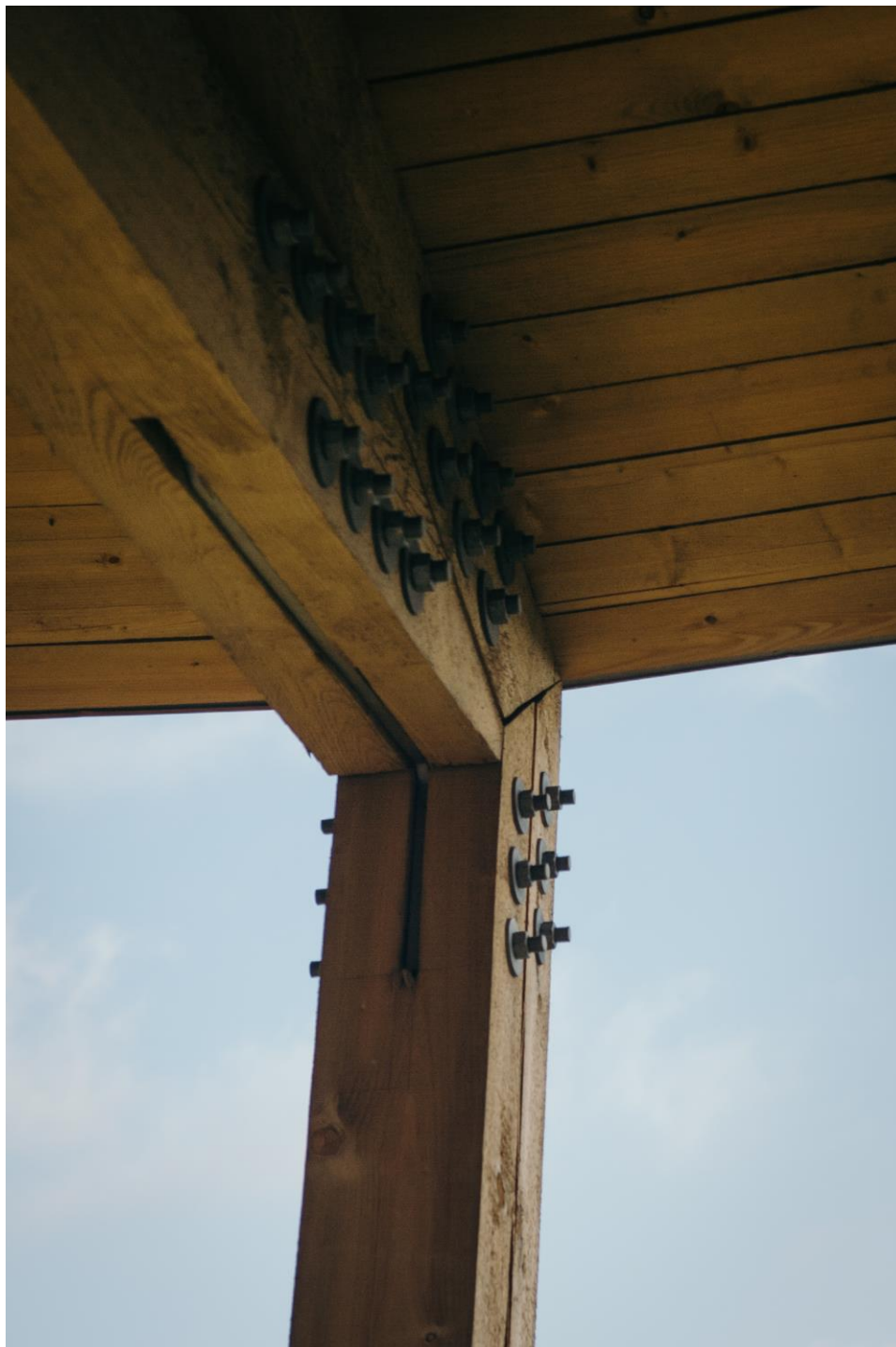
Obrázek 52 – Fotografie – detail C – roh střešní konstrukce
