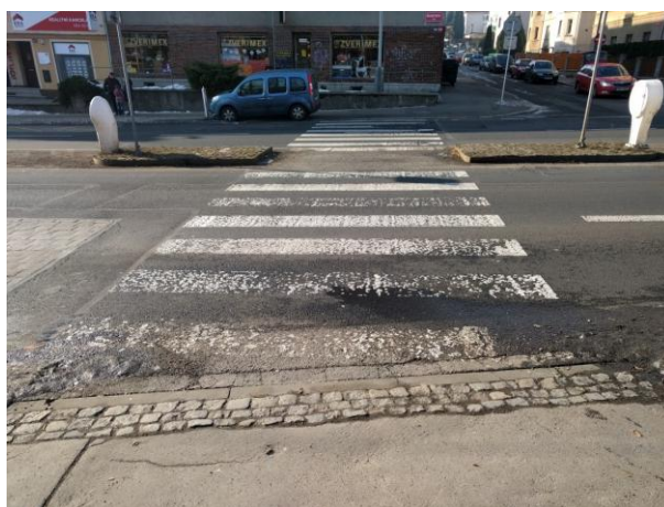
Obrázek 26 Chybějící prvky pro OOSPO a opotřebované VDZ
