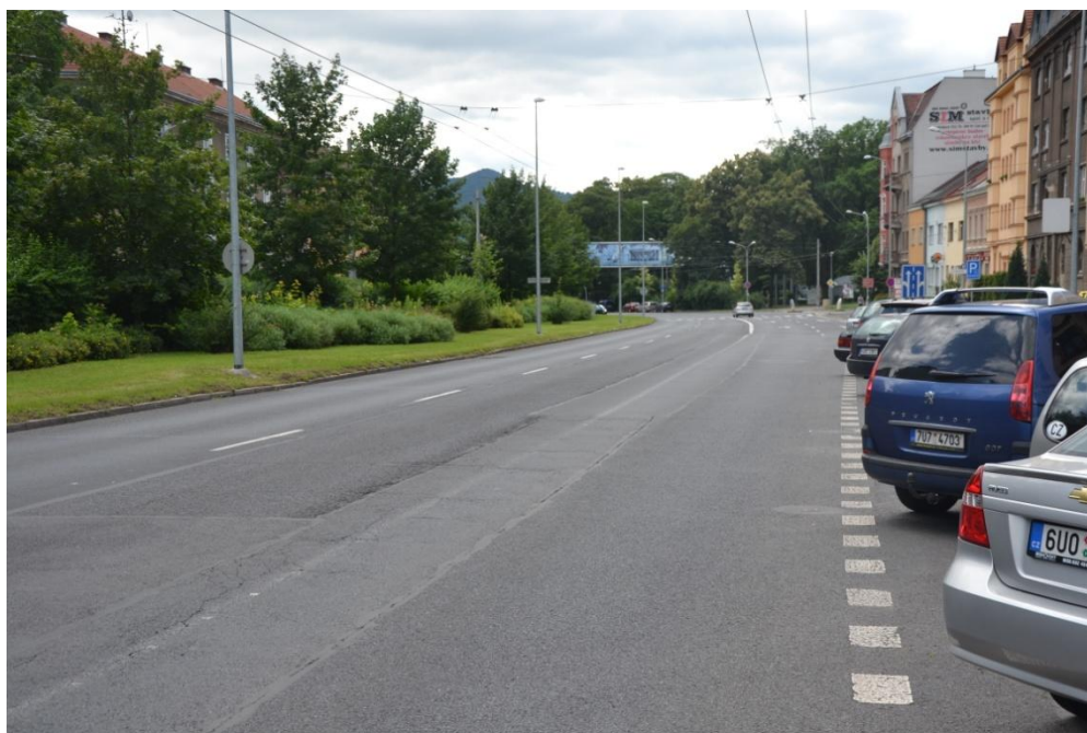
Obrázek 17 Rozlehlý prostor místní komunikace a neviditelné VDZ zdroj: autor
