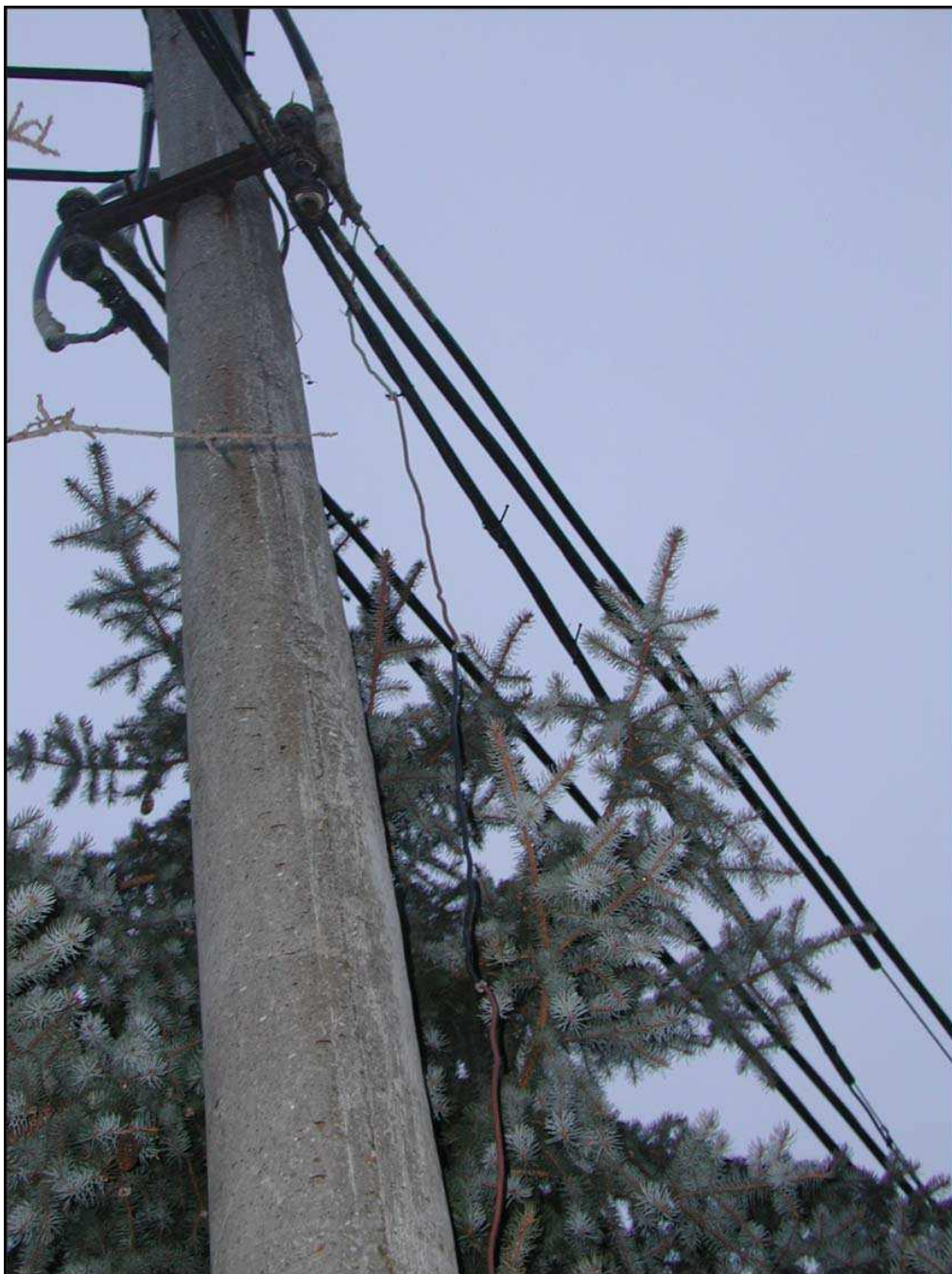
Obr. 25 Neoprávněný odběr elektrické energie zvaný „rybář“
