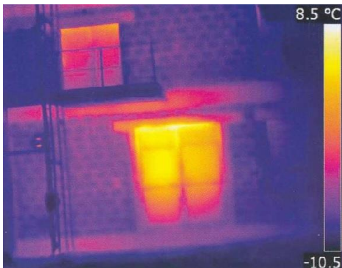
Obr. 14 Termokamera prozrazuje, že je v budově velmi teplo. Cihly izolují lépe než pojivo mezi nimi.
