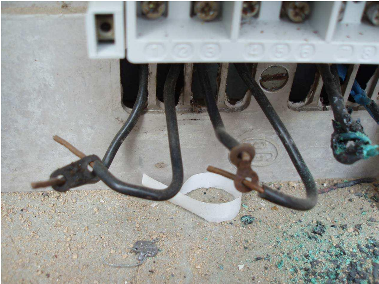
Obr. 27 Napojení odběru elektrické energie před elektroměrem
