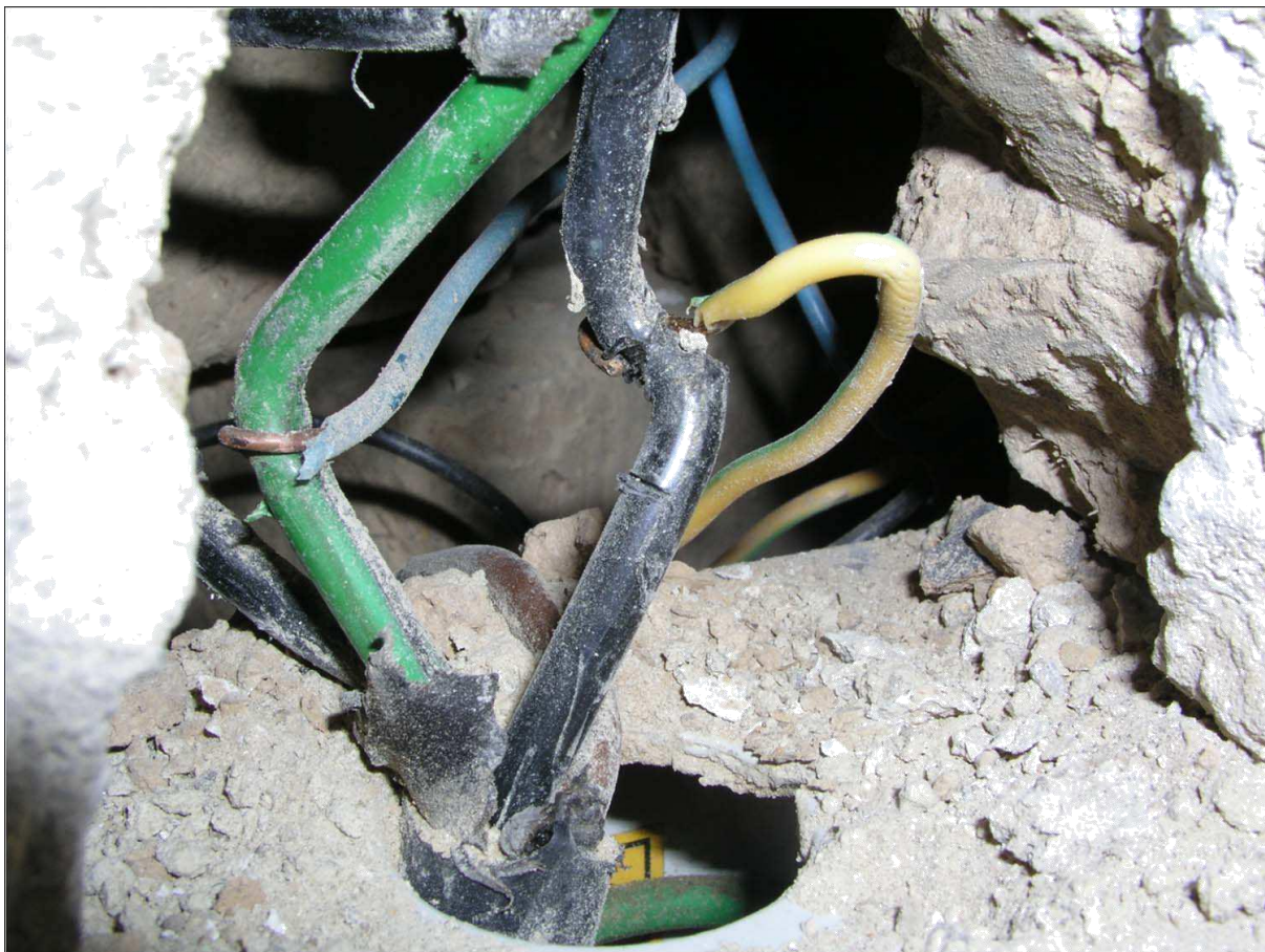
Obr. 24 Napojení odběru elektrické energie před měřením
