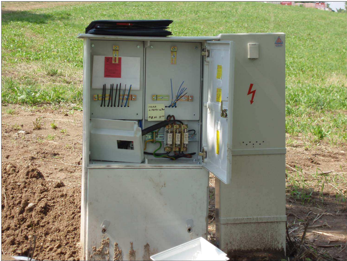
Obr. 23 Napojení odběru elektrické energie před měření
