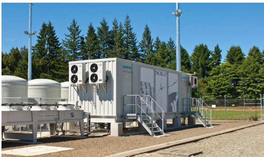
Obr. 1.4 – Systém SVC PLUS nainstalovaný v Norsku [12]
