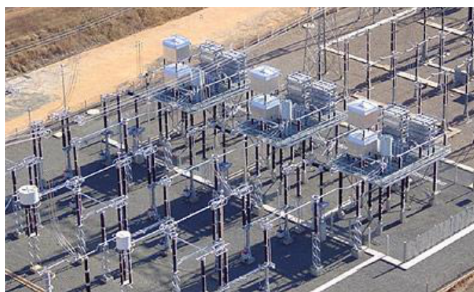
Obr. 2.17 – Pevná sériová kompenzace Siemens realizovaná v Brazílii [12]
