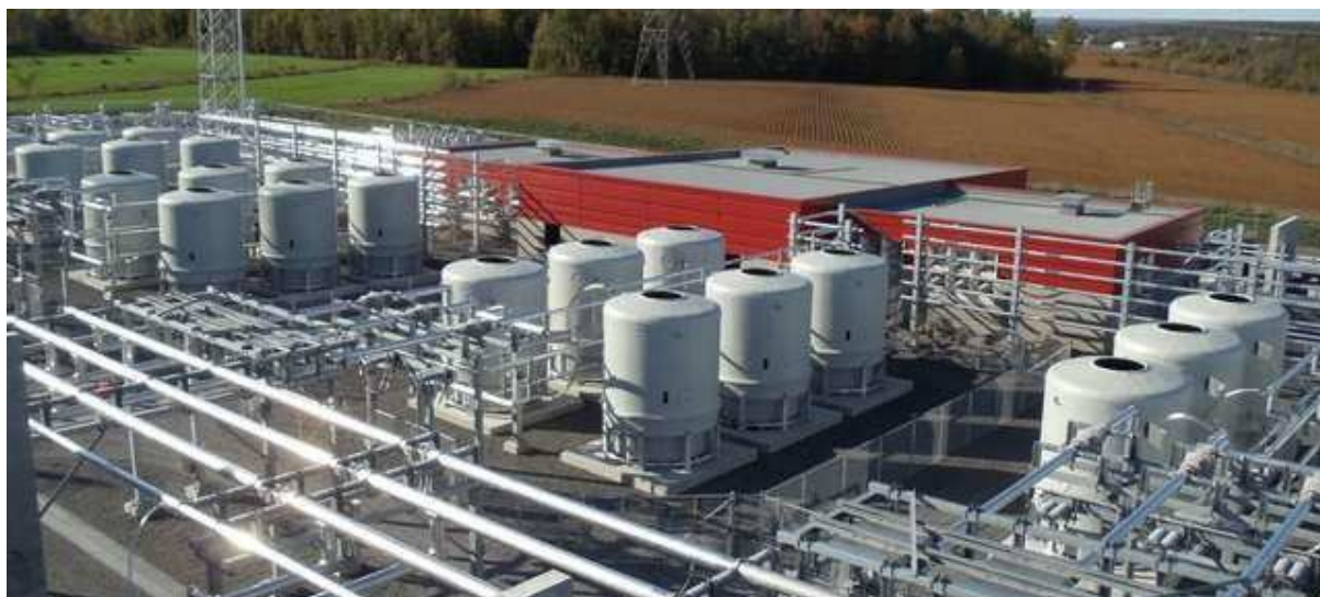
Obr. 2.18 – Systém SVC od ABB realizovaný v Kanadě, Chénier [11]
