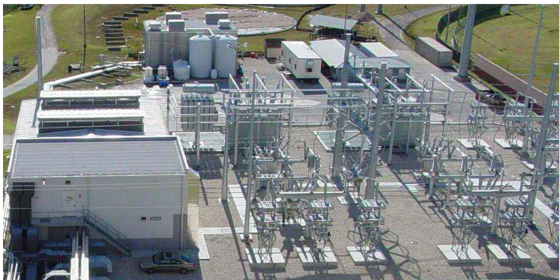
Obr. 2.20 - Systém STATCOM od ABB, Austin, Texas, USA [11]
