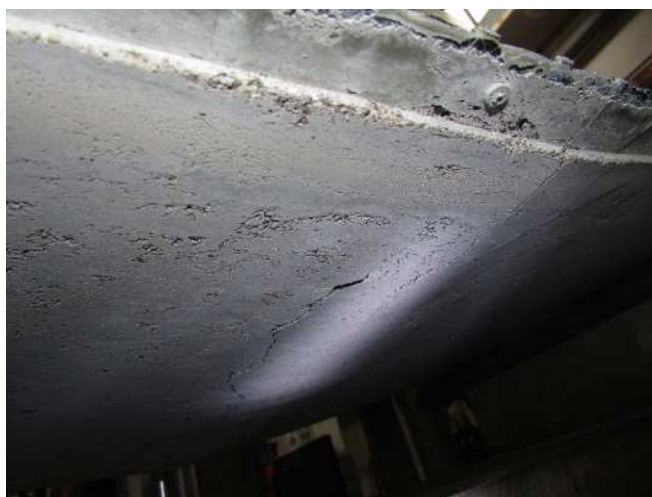
Obrázek 102- Viditelné trhliny na spodní straně desky při zkoušce třibodovým ohybem, D1b. [68]
