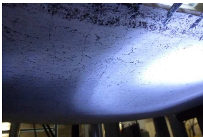
Obrázek 88- Trhliny na spodní ploše desky během čtyřbodové zkoušky. [68]
