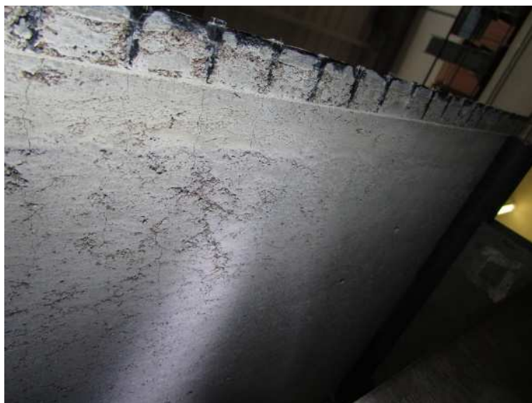
Obrázek 95- Viditelné trhliny na spodní straně desky v místech vláken sítě, D1a. [68]
