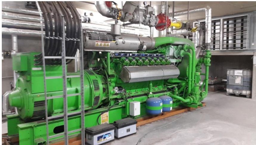
Obrázek 15 – Motor Jenbacher 999kW kogenerační jednotka
