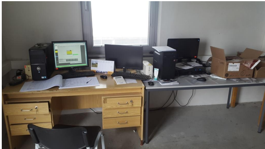
Obrázek 12 – Velín bioplynové stanice Karlovice
