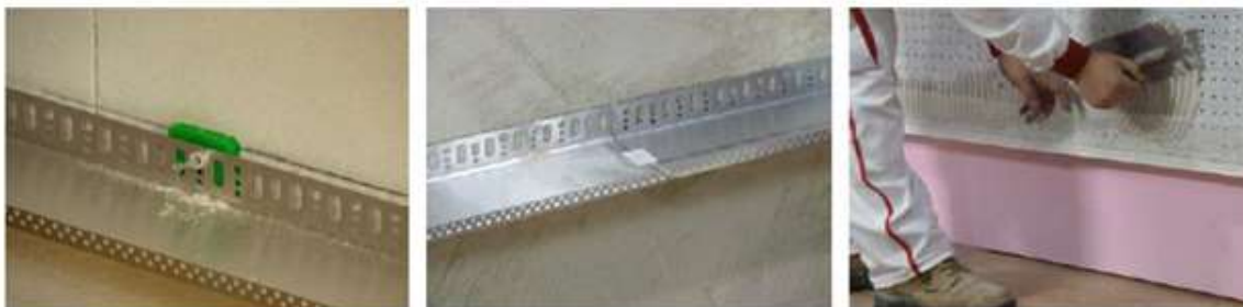
Obrázek 6.4 Soklová distanční podložka, spojka doklových lišt PV 30 a okapnička k soklovému profilu ETICS. Převzato z 6.1 .
