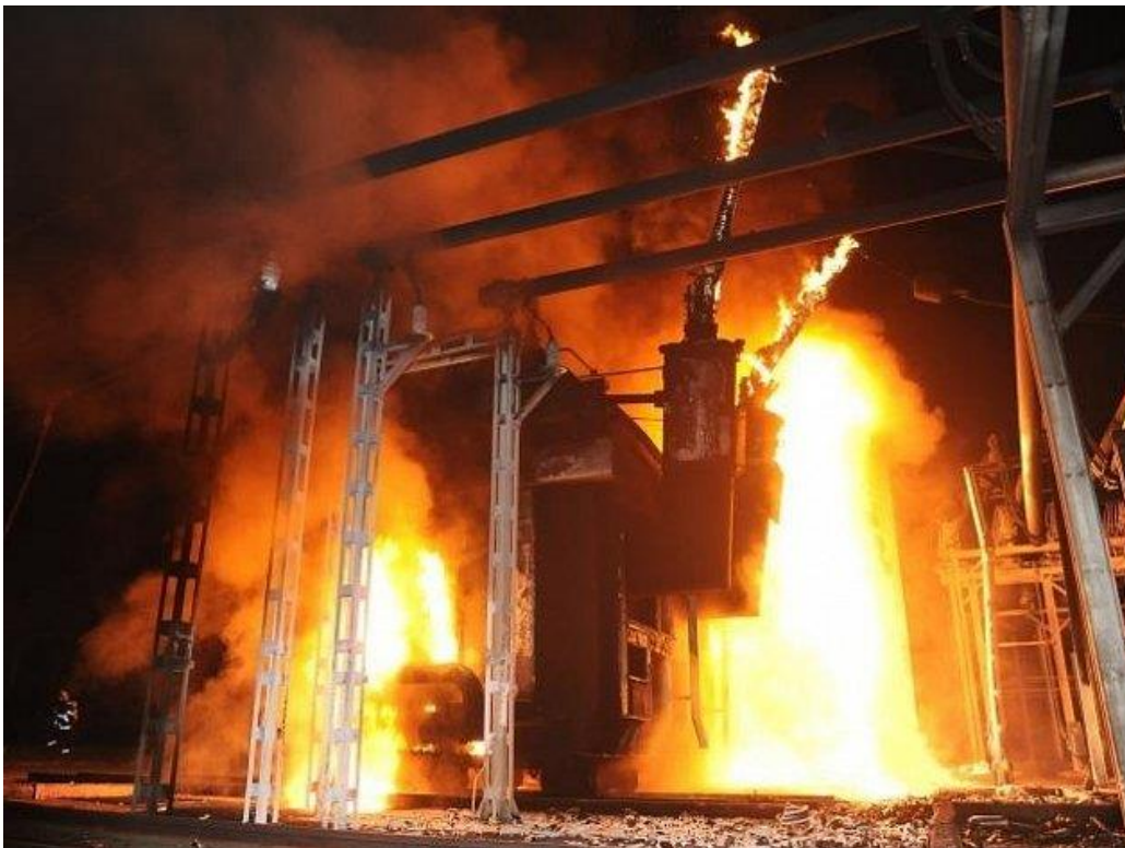
Obr. č. 11, hořící transformátor Chodov [47]
