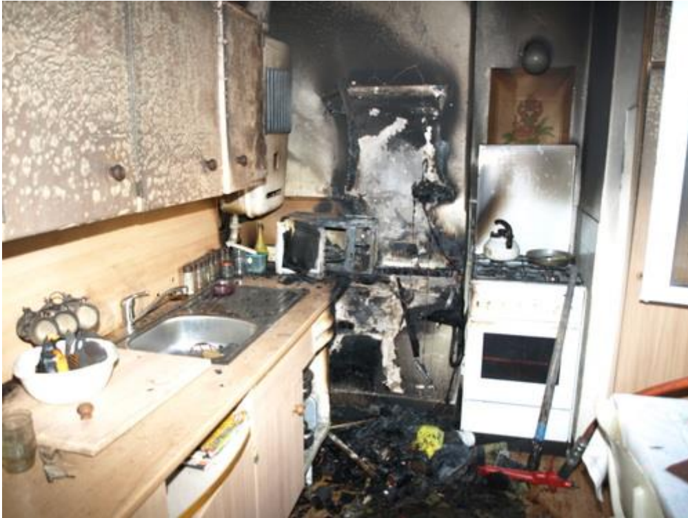
Obr. č. 10 ukázka kuchyňského koutu poškozeného vyhořením rychlovarné konvice [43]
