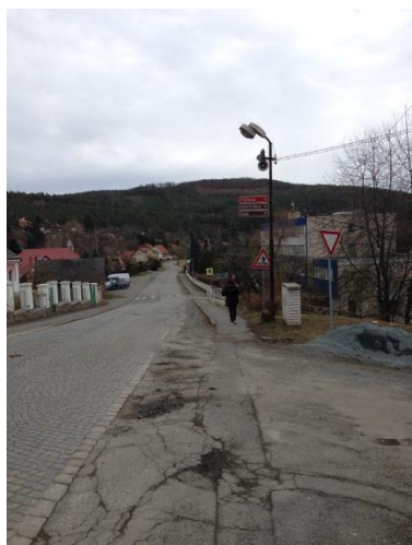
Obrázek 13 – Trhliny v místě napojení
