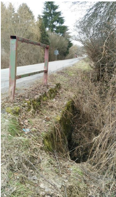
Obrázek 2 - Propustek v havarijním stavu
