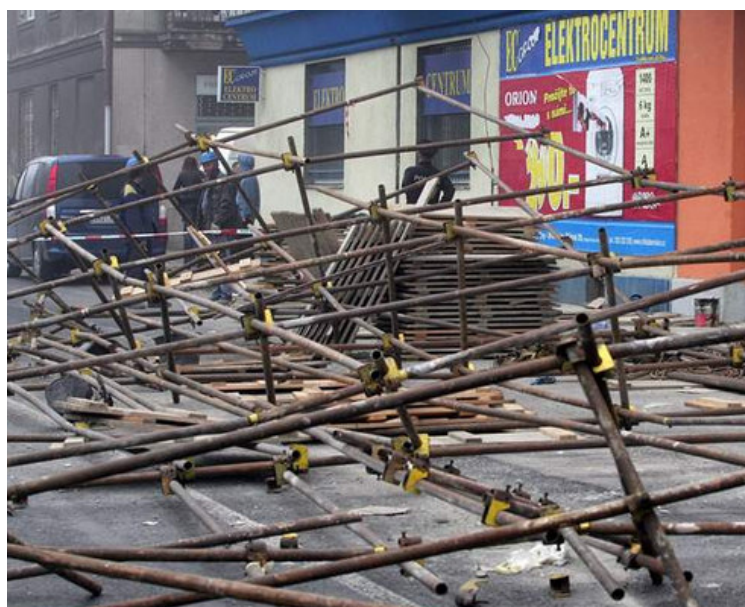
Obrázek 30 - Následek špatně ukotvené konstrukce v Karlových Varech
