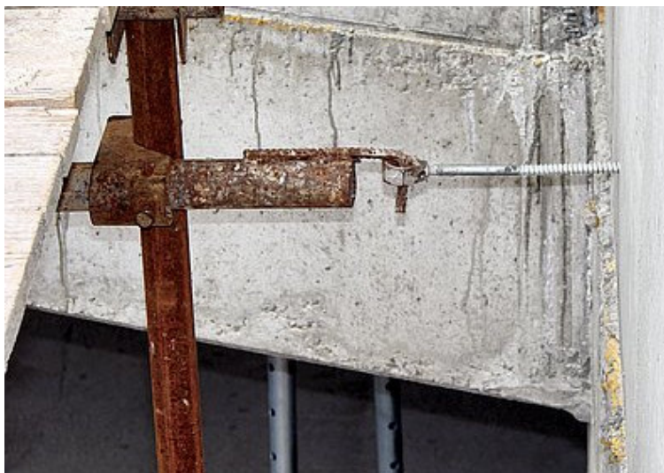
Obrázek 29 - Nesprávně provedená kotva, při působení tlaku kolabuje
