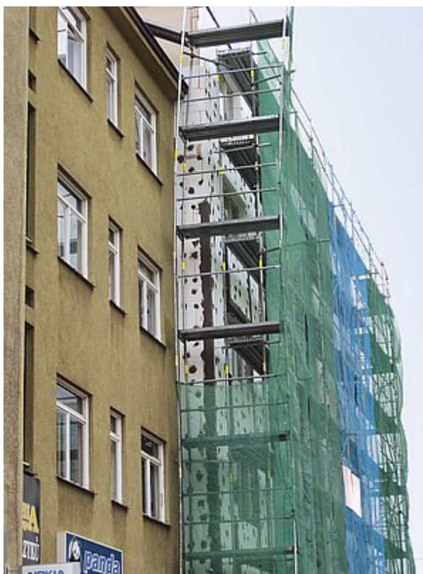
Obrázek 27 - Nevhodné řešení špatného založení
