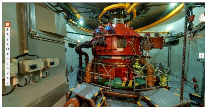
Obrázek 14: Víko turníny vodní přečerpávací elektrárny Dlouhé Stráně 30
