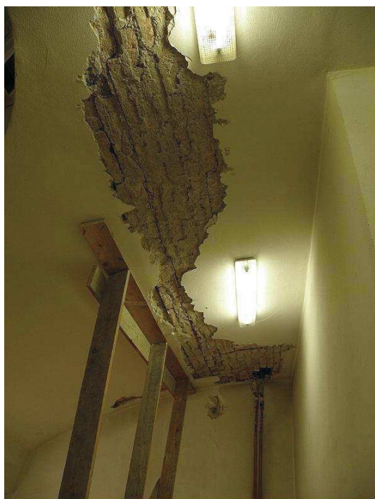
Obr. 57 Porušená segmentová valená klenba
