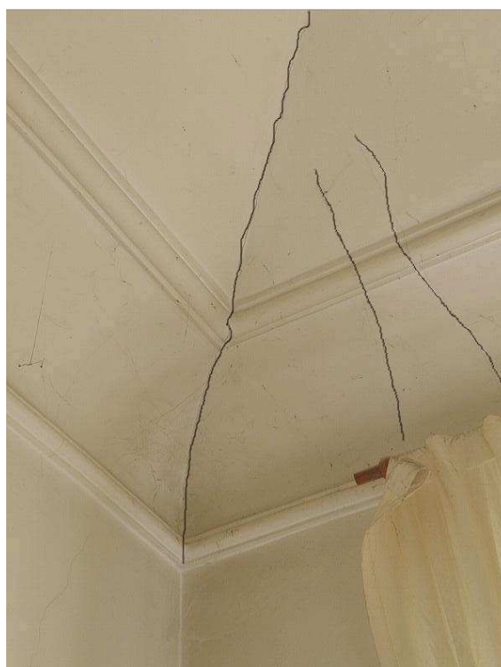
Obr. 56 Trhlina na klenbě v místnosti 1.06
