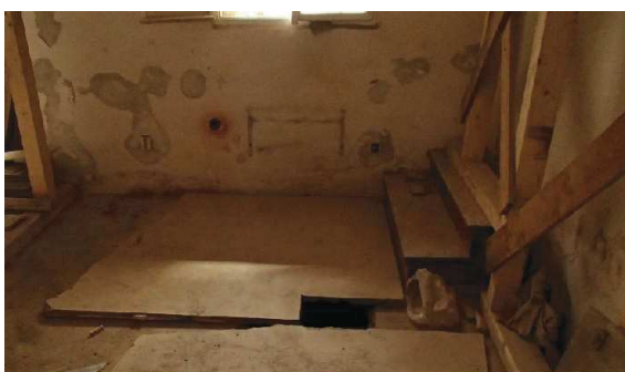
Obr. 35 Degradace vnitřních omítek v suterénu
