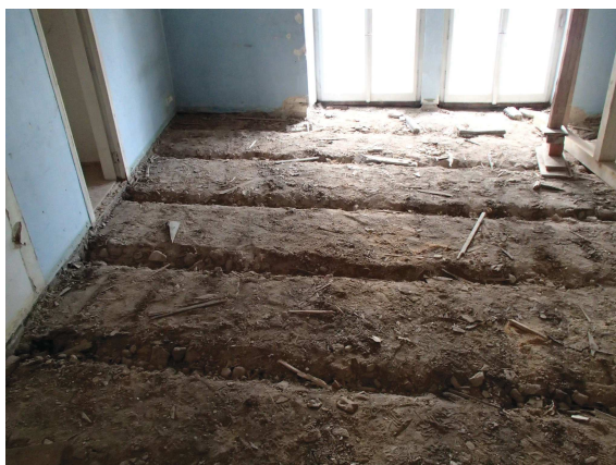
Obr. 17 Podlaha III. NP – trámový strop s rákosníky, pohled na suť
