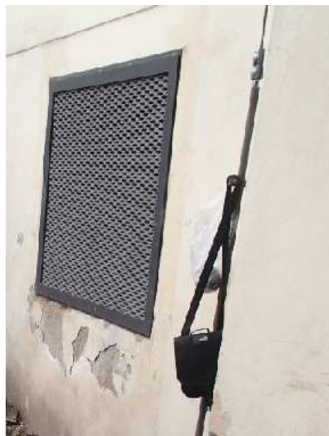
Obr. 34 Degradace omítky na fasádě v soklové části
