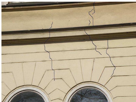
Obr. 49 Svislé trhliny na jižní fasádě
