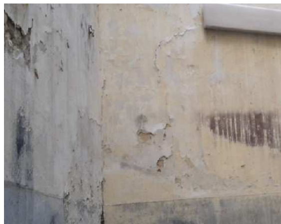
Obr. 36 Degradace fasády na východním průčelí
