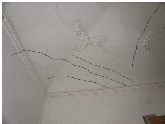
Obr. 55 Trhliny na klenbě v místnosti 1.04
