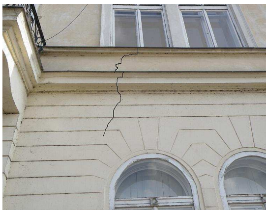
Obr. 50 Svislé trhliny na západní fasádě
