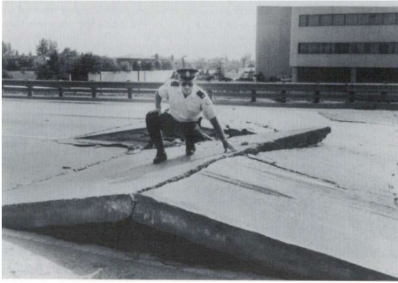
Obrázek 45 – Boule na vozovce integrovaného mostu v místě rozhraní opěry a násypu. Vozovka byla v době porušení 16 let stará (Toronto, Kanada, 1986). [6]
