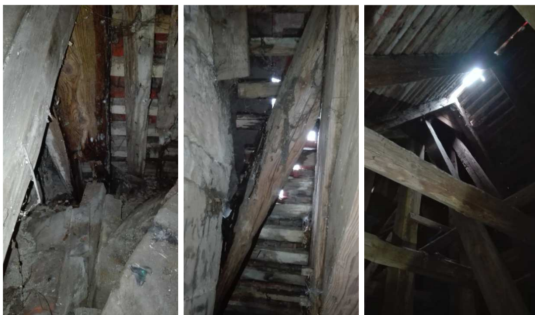
Obr. č. 54, 55, 56 uhnílé zhlaví krokve v SZ rohu střechy u stěny věže, poškozená krytina nad tímto rohem a viditelné zatékání, Chybějící hřebenače u sanktusníku a degradované zhlaví krokví
