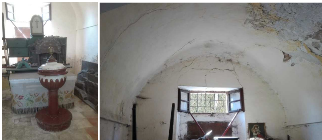
Obr. č. 14 a 15 vlevo kamenná křtitelnice vpravo porušení okenního nadpraží
