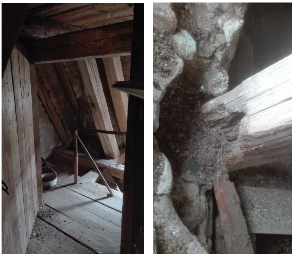
Obr. 21 a 22 pohled z místnosti hodinového stroje, uhnílé zhlaví příčné vzpěry
