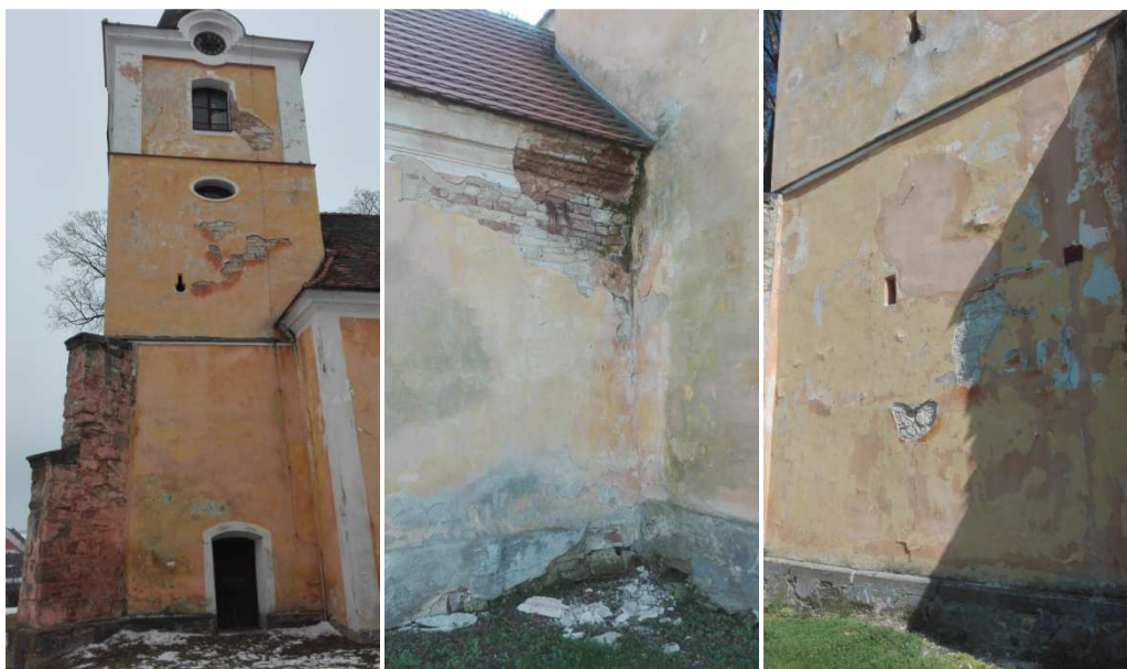
Obr. č. 2, 3, 4 poruchy na fasádní omítce, zleva jižní strana věže, roh u sakristie, průčelí věže
