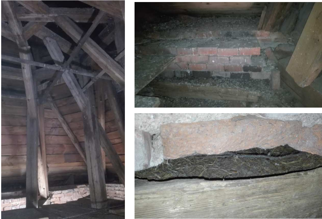
Obr. č. 24, 25 a 26 krov věže s vaznicovým roštem ztuženým lešenářskými rourami, degradovaná pozednice na severní straně, degradovaná pozednice na západě
