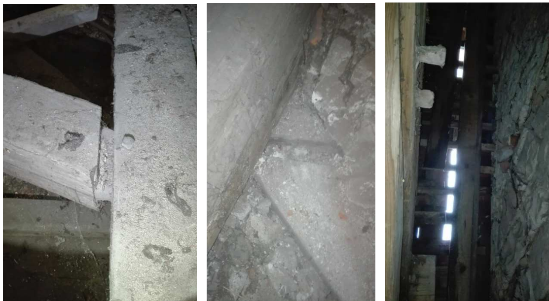
Obr. č. 32, 33 a 34 uvolněný spoj vazného trámu ve valbě, uvolněný spoj pozednic nad rohem presbytáře, chybějící krytina u věže.
