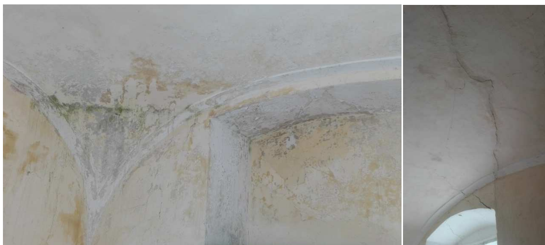
Obr. č. 12 a 13 vlhkostní mapy v jihozápadním rohu a trhlina nad oknem a ve stropní klenbě
