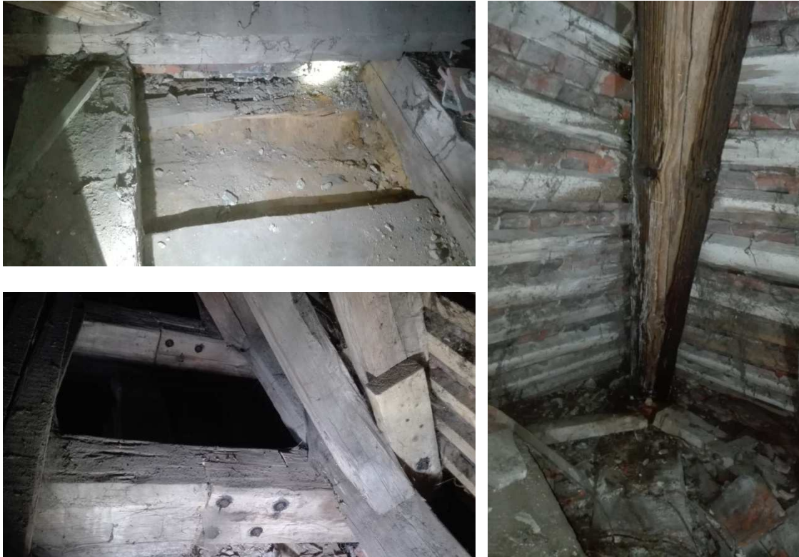
Obr. 35, 36 a 37 druhé pole od přechodu krovů hl. lodi a presbytáře se zničenou pozednicí, napadená rohová krokev v severním rohu za věží, protézované trámy a krokev na severní straně
