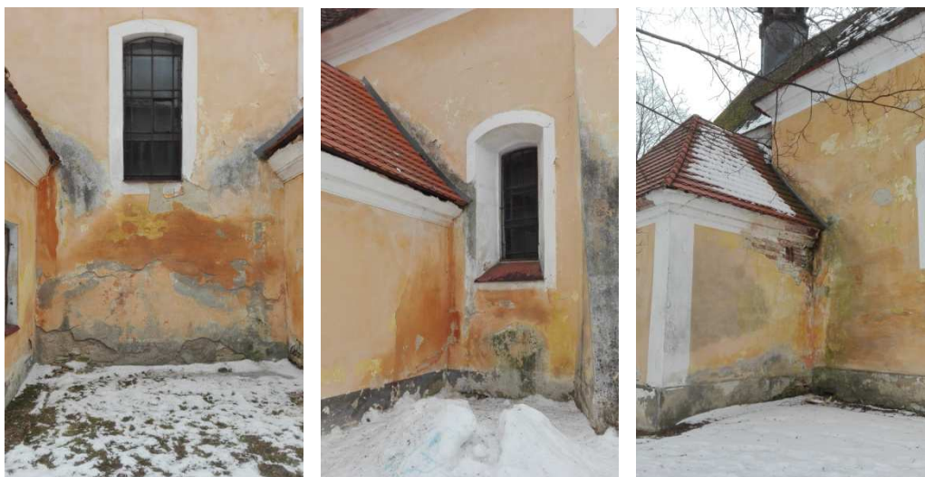
Obr. č. 57, 58, 59 obrázky slině zavlhlé omítky díky stékající vodě ze střech přístavků, zleva mezi předsíní a oratoří, presbytář vedle oratoře a roh sakristie u hl. lodi
