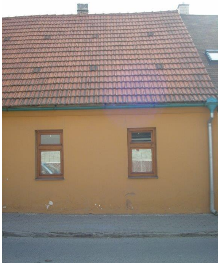
fasáda směrem k hlavní komunikaci, odpadávající omítka z důvodu vzlínající vlhkost
