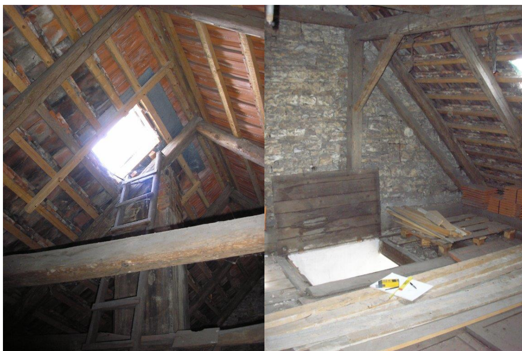
degradovaná vaznice z hlediska průhybu a napadení dřevokazným hmyzem
