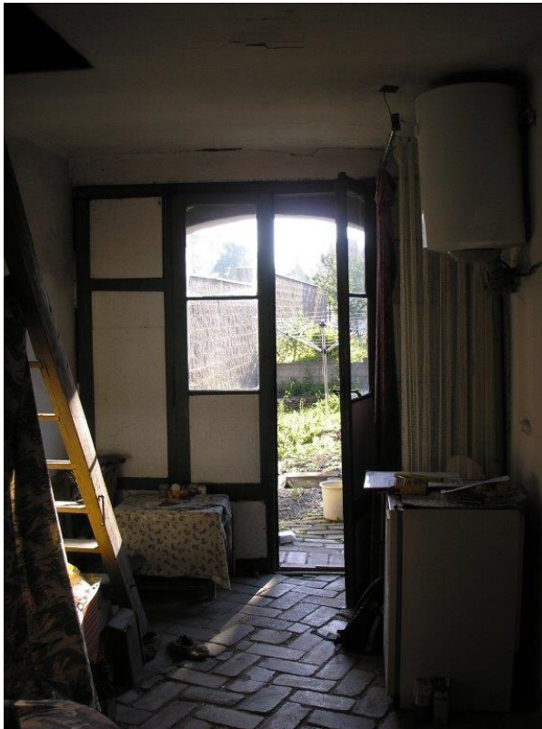
Obrázek 37: Elektrický boiler na přípravu teplé vody
