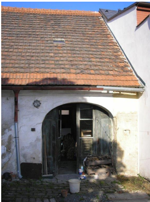
Obrázek 33: Nevhodné spádování žlabu v pravé části, voda nemůže odtékat do svodu, volné vytékání vody na terén za svodu, popraskané tašky
