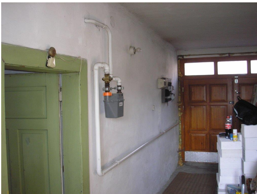
plynoměr umístěn v chodbě
