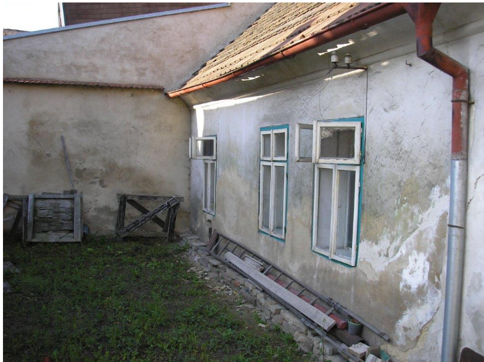
Obrázek 32: Vlhké obvodové zdivo
