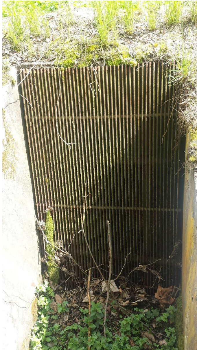
Jemné česle jednoho vtokového pole u mlýna
