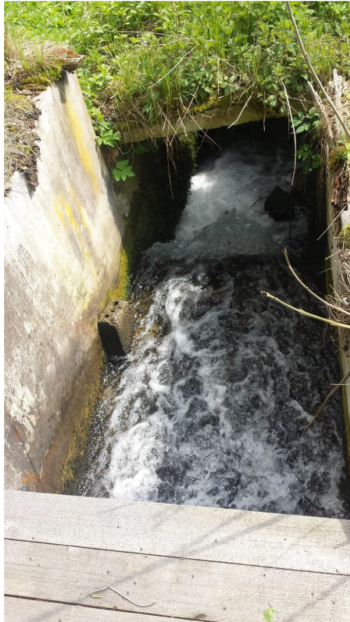
Přívod vody k turbíně
