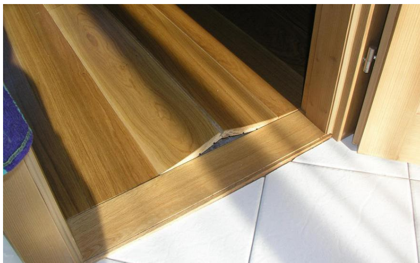
Obr. 22: Důsledek extrémních objemových změn dřevěné podlahy (bobtnání) [36]
