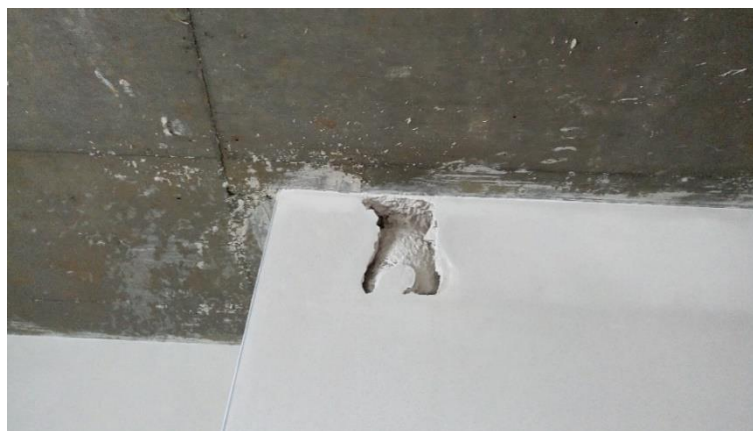
Obr. 116 Nedokončený detail po omítání I (M1040A)
