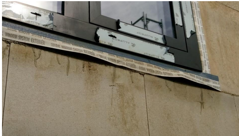
Obr. 78 Odlepující se paropropustná páska (M820)
