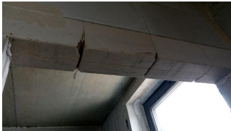
Obr. 108 Poškozený překlad (M820)
