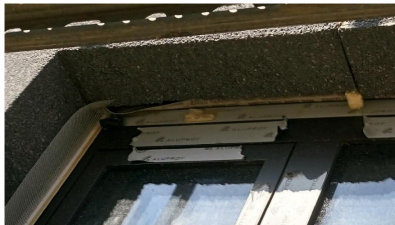
Obr. 79 Chybně přilepená paropropustná páska (M820)
