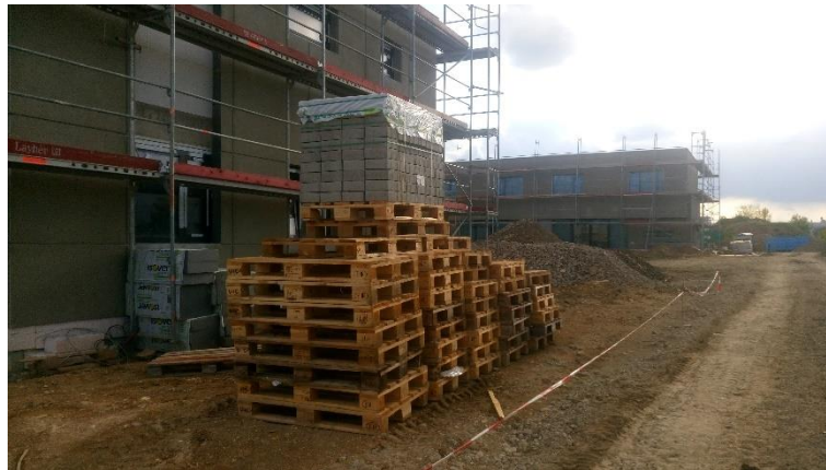
Obr. 61 Nebezpečné skladování dlažby
