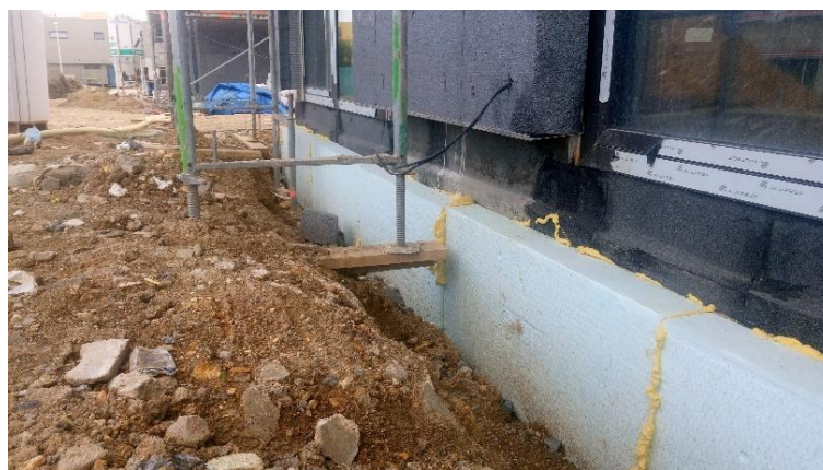
Obr. 66 Nevhodné založení lešení I
