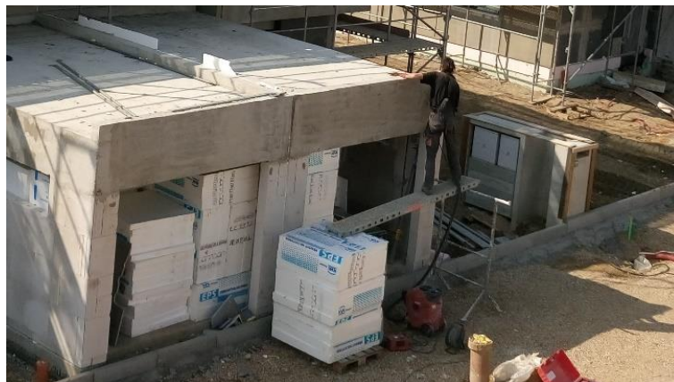
Obr. 62 Nedodržení základů BOZP
