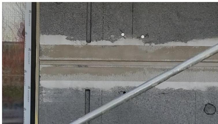
Obr. 19 Vodorovná drážka v KZS (M820)
