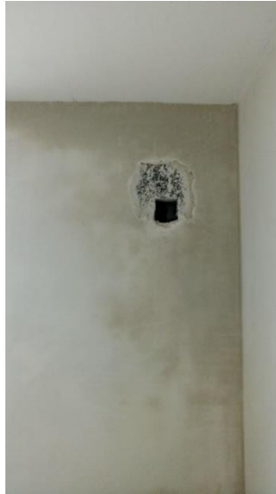
Obr. 117 Nedokončený detail po omítní II (M1040A)
