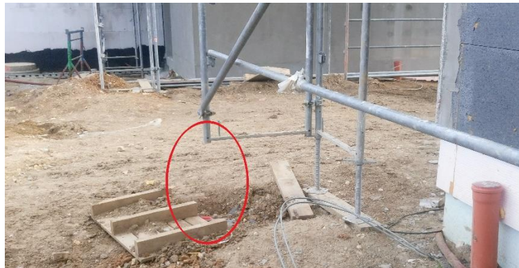
Obr. 67 Nevhodné založení lešení II
