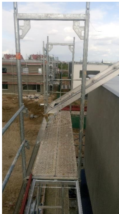
Obr. 68 Nezabezpečeně lešení I
