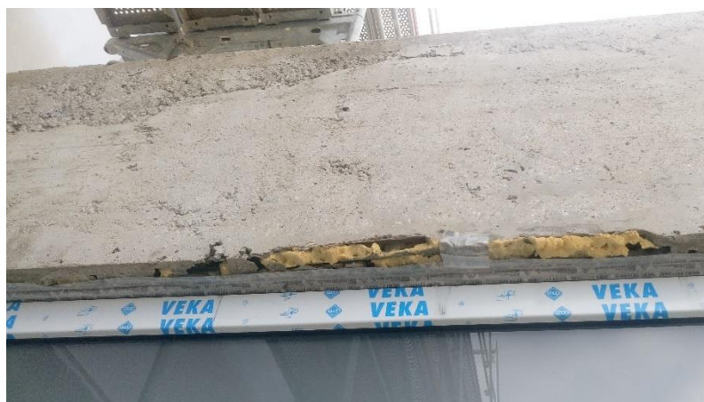
Obr. 90 Pokus o zapravení chyb po betonáži I
