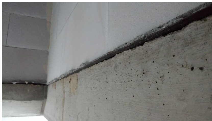
Obr. 110 Přečnávající hydroizolace v prostoru schodiště (M1040A)
