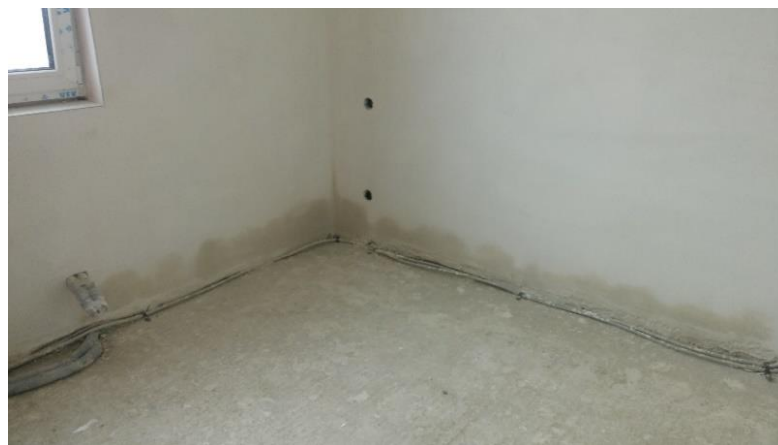
Obr. 36 Vysychání omítnuté místnosti
