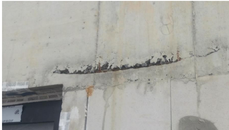
Obr. 89 Viditelná výztuž (nedodržení krycí vrstvy)
