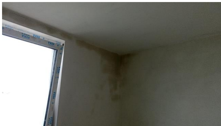
Obr. 120 Vlhký roh místnosti (M700)
