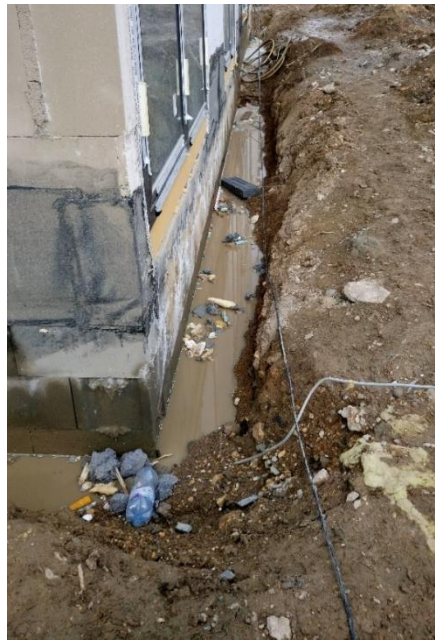
Obr. 82 Neodvodněná základová spára (M820)
