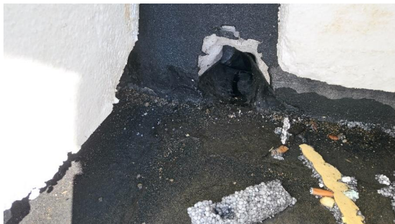
Obr. 99 Detail provizorní vpusti na vnitřní straně atiky (M700)
