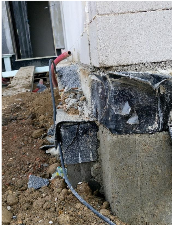
Obr. 85 Detail posunuté desky garáže I
