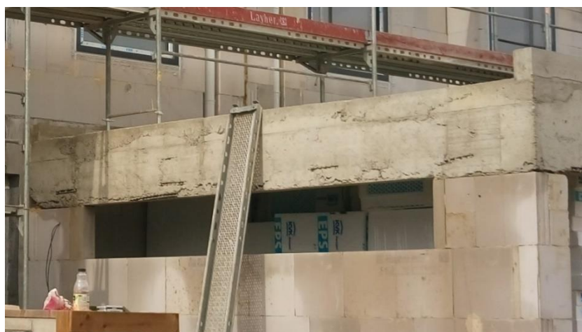
Obr. 88 Chybně provedená monolitická deska
