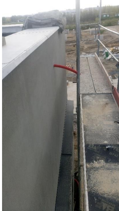
Obr. 69 Nezabezpečené lešení II
