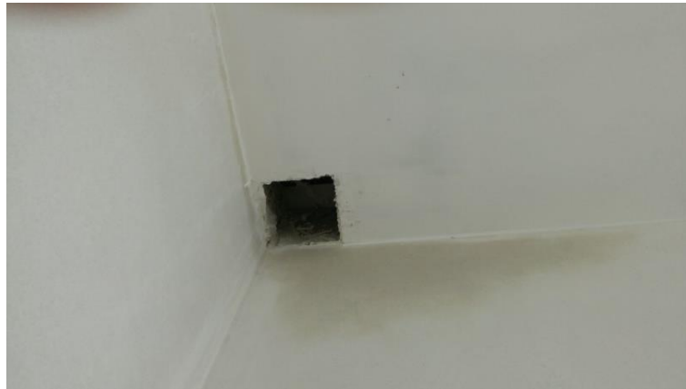
Obr. 119 Zbytečný prostup ve stropní konstrukci (M700)
