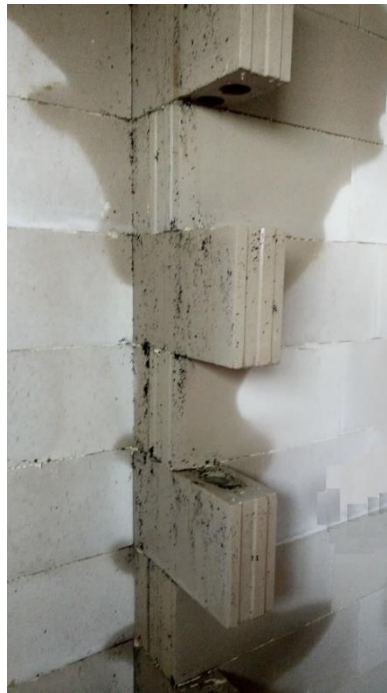
Obr. 113 Vykonzolované příčkovky plné vody (M1040A)
