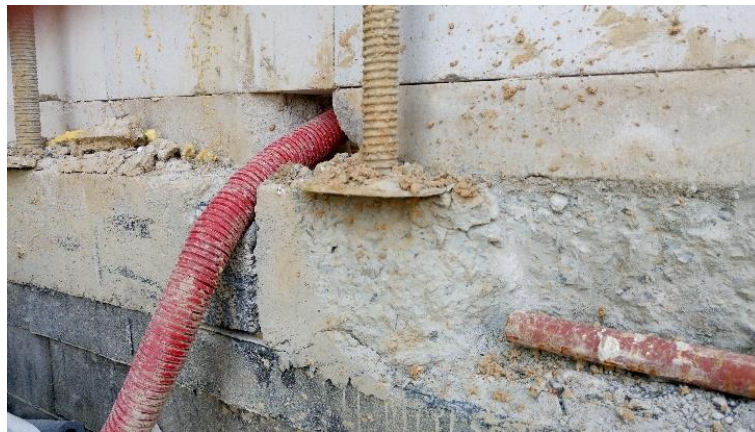
Obr. 63 Chybné založení fasádního lešení (Nánožka)
