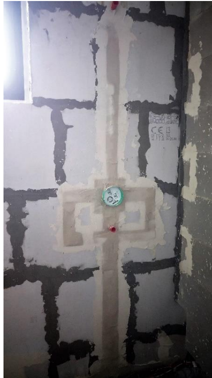
Obr. 23 Utěsněné spáry na obvodové zdi v koupelně
