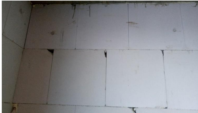
Obr. 104 Poškozené tvárnice zabudované v obvodové zdi (M1040A)
