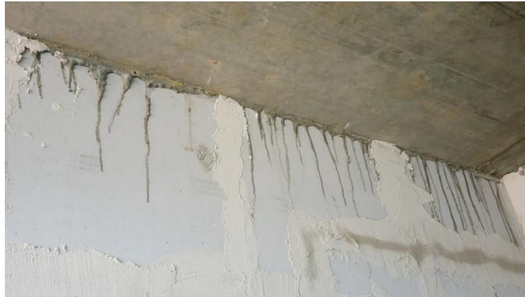
Obr. 102 Přetoky betonu u stropu (M1040A)
