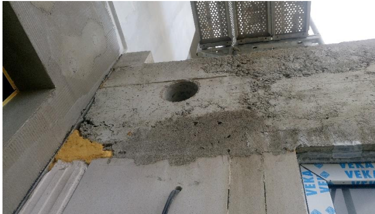
Obr. 91 Pokus o zapravení chyb po betonáži II
