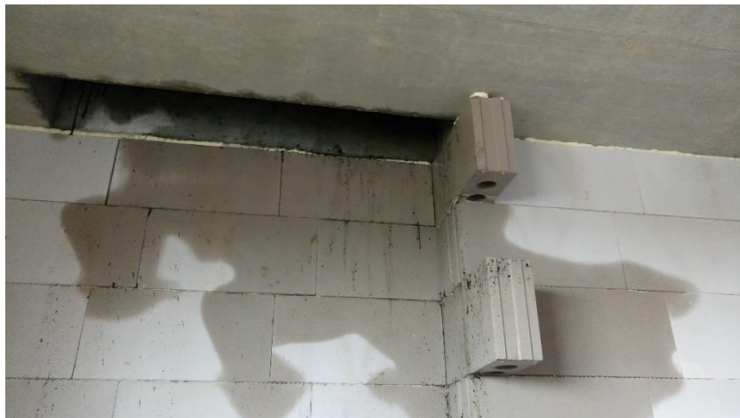
Obr. 112 Nezabezpečený vstup střešou (M1040A)
