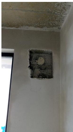
Obr. 118 Nedokončený detail po omítní III (M700)
