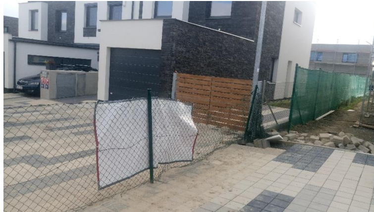
Obr. 58 Nevyhovující oplocení staveniště
