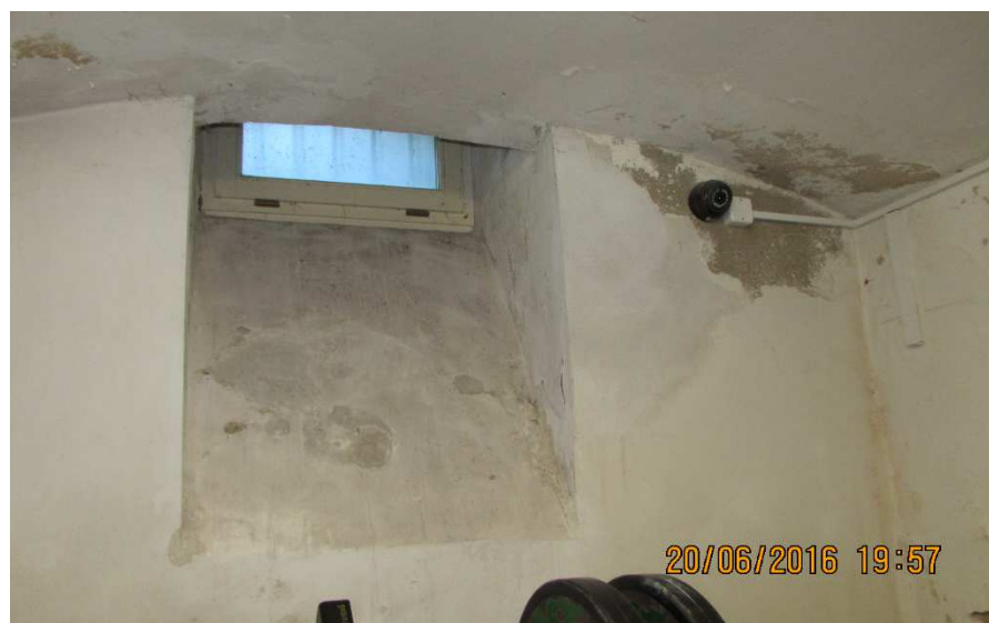
foto č. 3: Vlhkostní poruchy v suterénu
