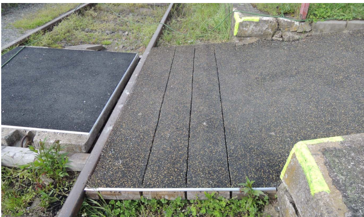
Obr. 90 Upravené trhliny v povrchu rampy
