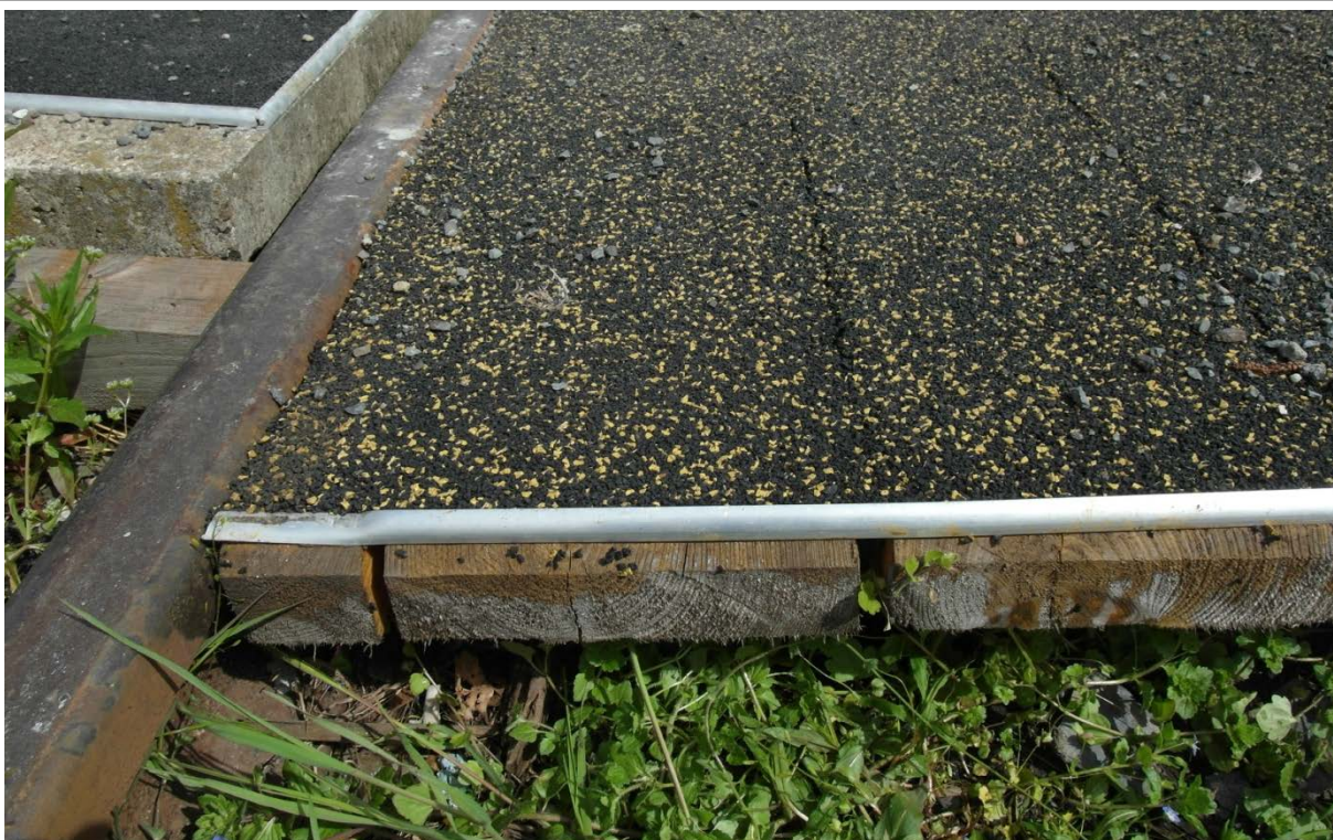
Obr. 87 Trhliny v povrchu rampy
