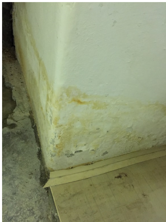
Obrázek č. 19 - Vlhké zdivo, Zdroj: (6)
