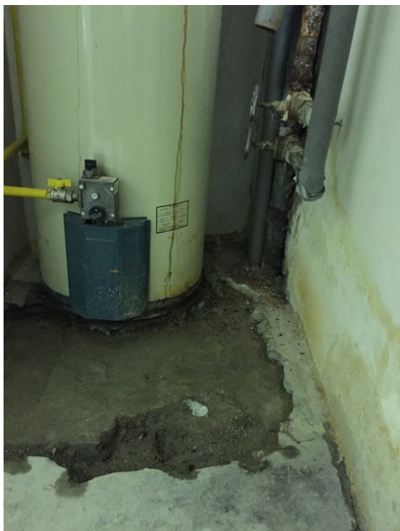
Obrázek č. 18 - Vlhké zdivo, Zdroj: (6)
