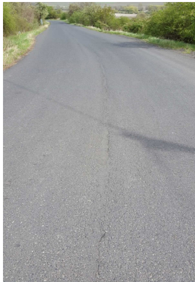
Obr. 18: Trhlina uprostřed vozovky
