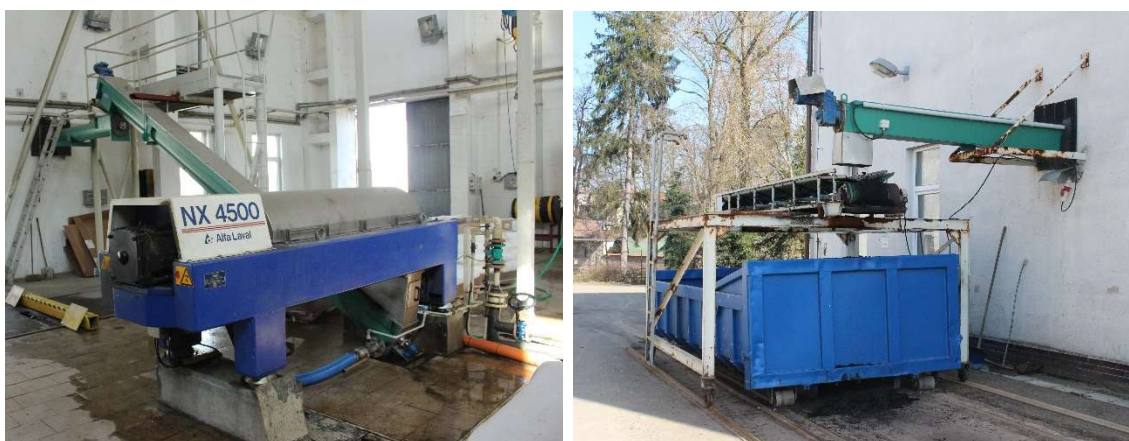
Obr. 3.20: Dekantační odstředivka a kontejner na akumulaci odvodněného kalu
