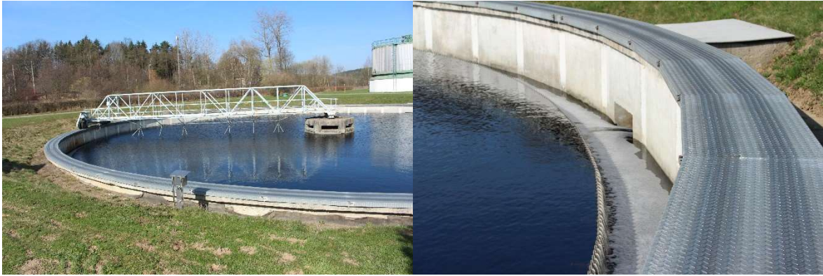
Obr. 3.12: Radiální dosazovací nádrž a přepadová hrana [29]
