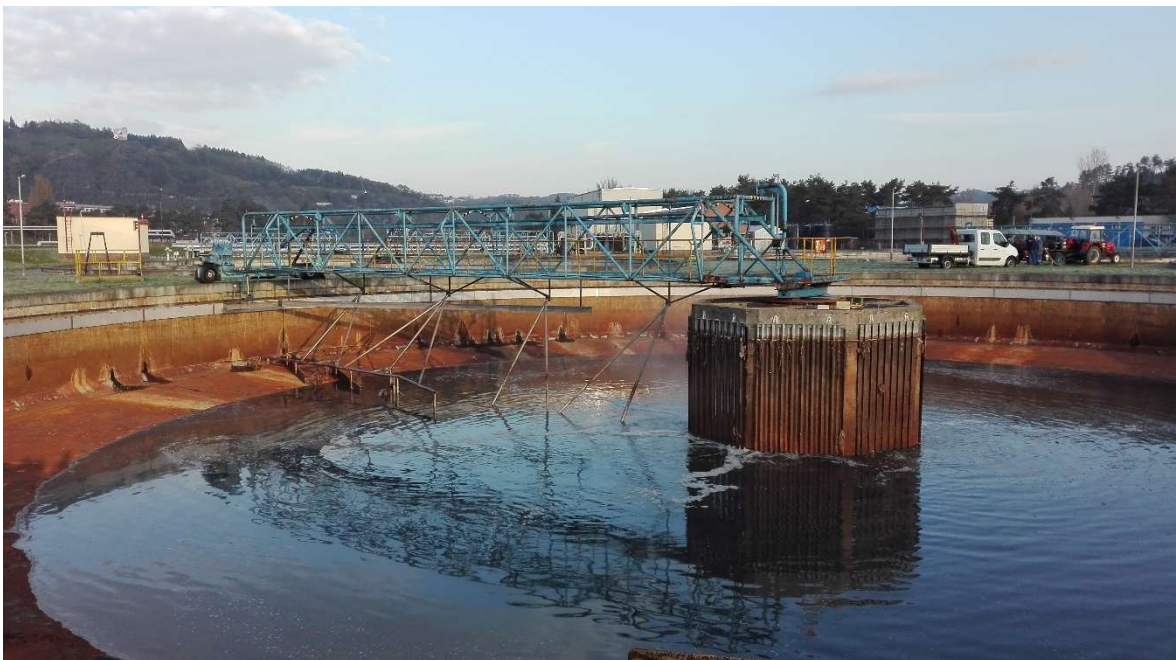
Obr. 3.11: Usazovací nádrž ČOV Praha [29]
