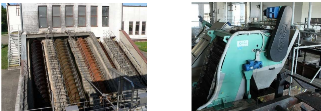
Obr. 5.6: Šneková čerpací stanice a česle Fontana
