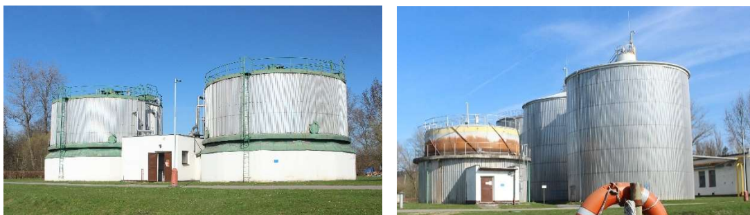
Obr. 3.19: Zleva: zahušťovací nádrže, plynojem a vyhňívací nádrže [22]
