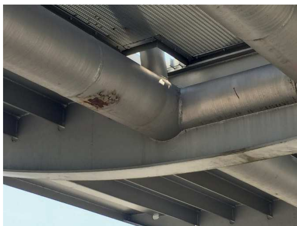
Obrázek 9: Poškození nátěru dolního pásu
