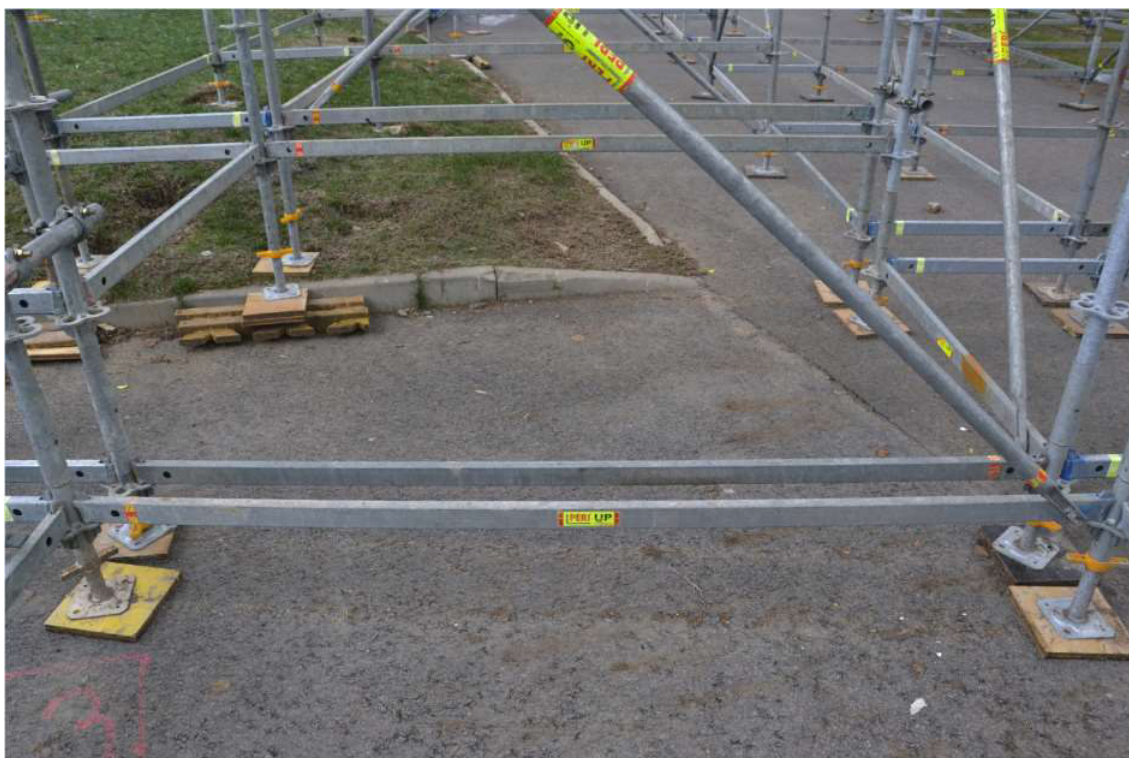
Obrázek 12 - Uložení sloupků na asfaltu a na zemině, ukázka podepření dřevěnými podložkami
