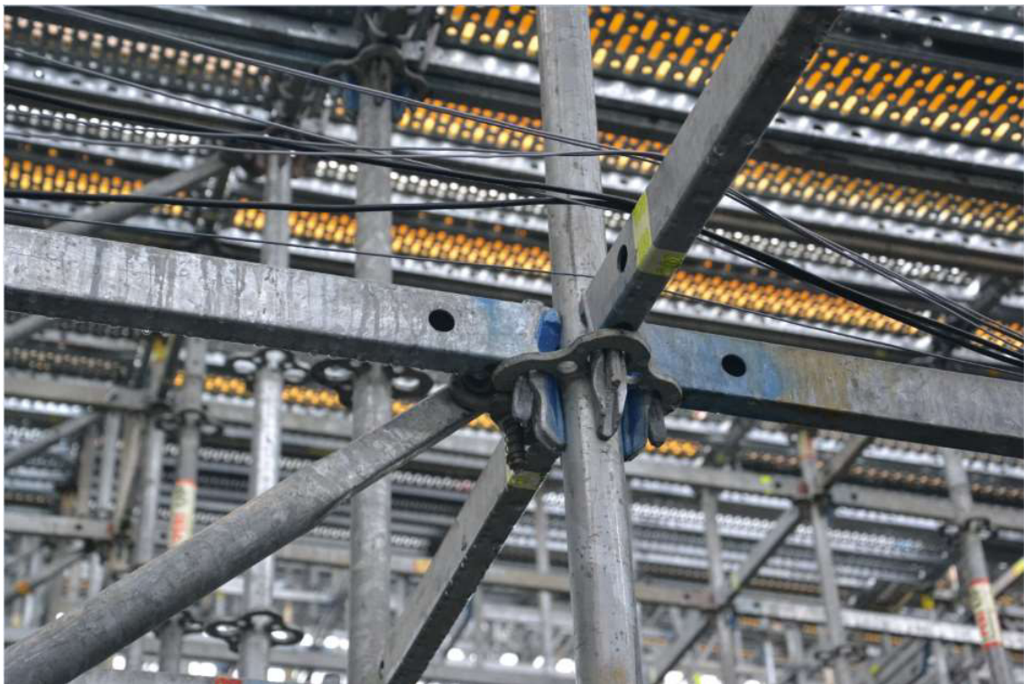
Obrázek 4 - Detail klínku horizontály zapojeném do rozety sloupku a ukázka vedení kabelů ke snímačům odezvy
