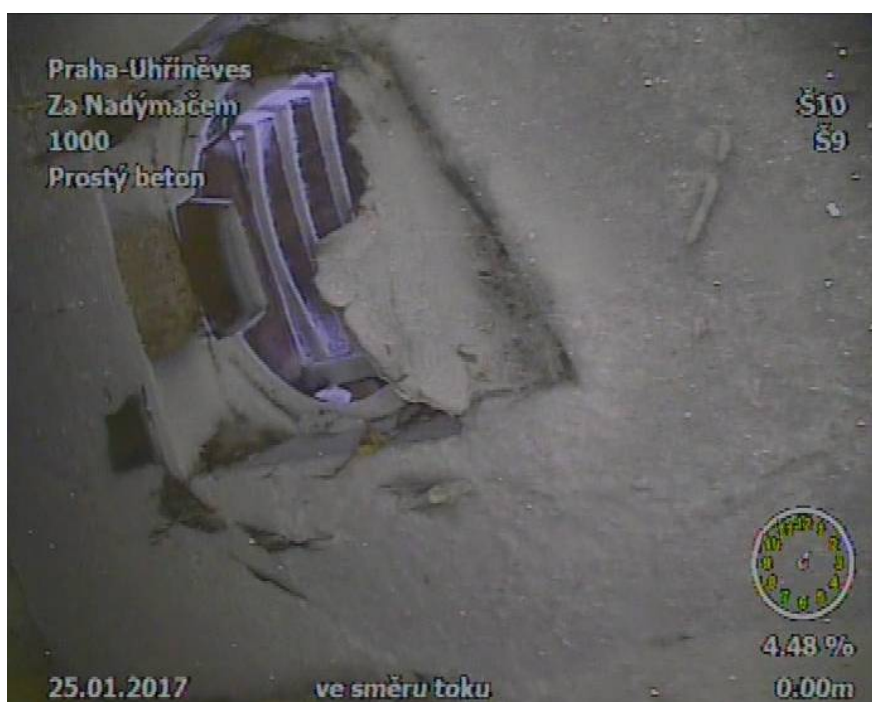
Obr. 53 Pohled na mříž uliční vpusti Š10
