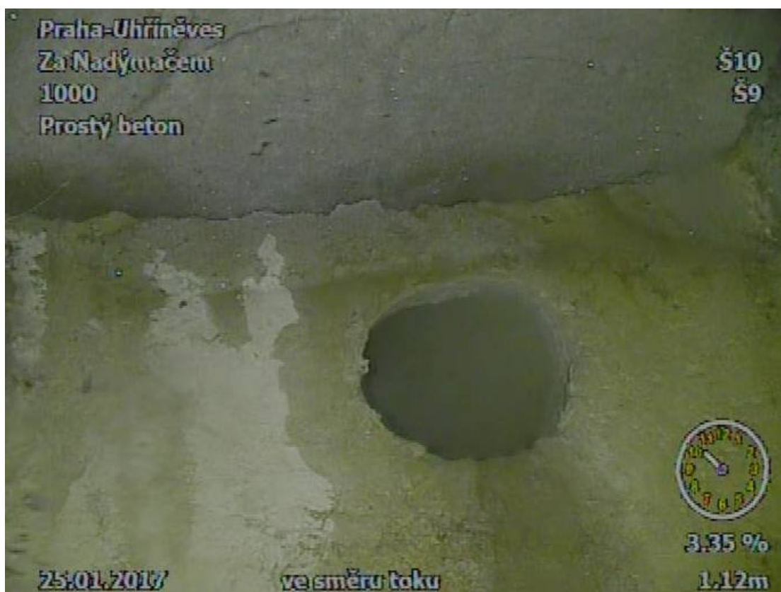
Obr. 54 Kanalizační přípojka 1 a netěsnost stropu a stěnou šachty Š10
