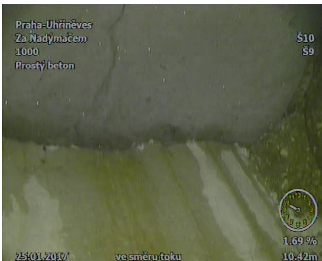
Obr. 60 Netěsnost mezi stropem a stěnou šachty
