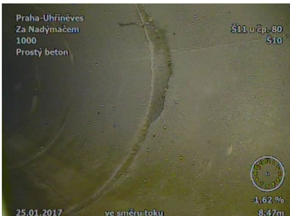
Obr. 46 Chybějící materiál skruže
