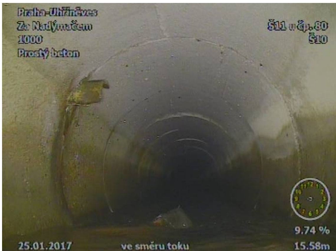
Obr. 47 Kanalizační přípojka a sediment na dně
