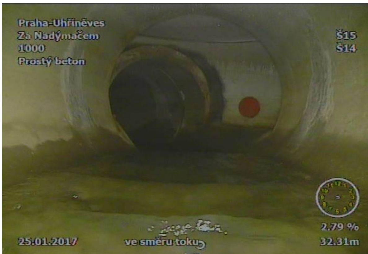
Obr. 32 Šachta Š14 a zaslepená kanalizační přípojka
