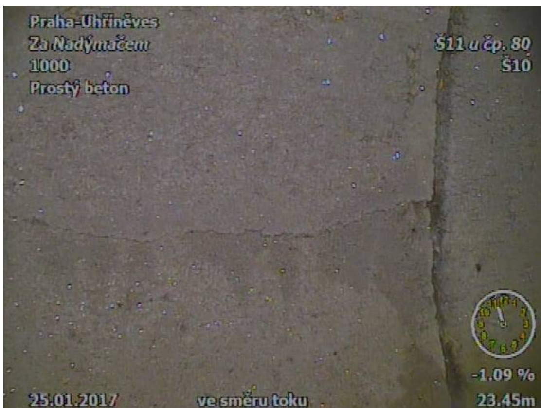
Obr. 49 Povrchová prasklina skruže
