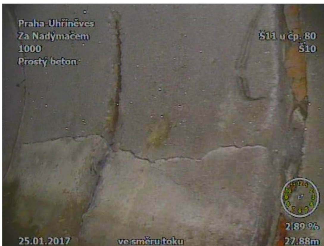
Obr. 50 Viditelná vnitřní výztuž a prasklina kruhové skruže
