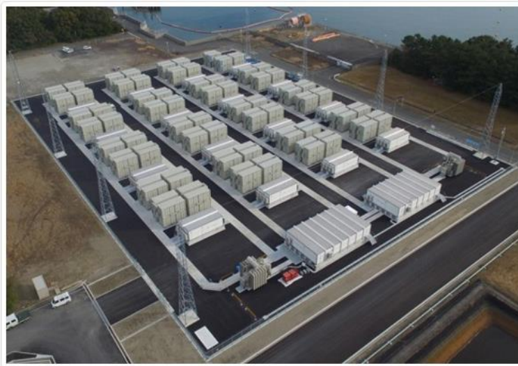
Obrázek 7: Největší instalace sodík-sírového akumulátoru [27]
