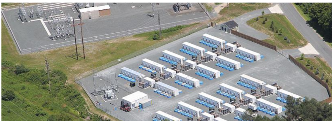
Obrázek 9: Pohled na instalaci setrvačnicku ve Stephentownu [30]
