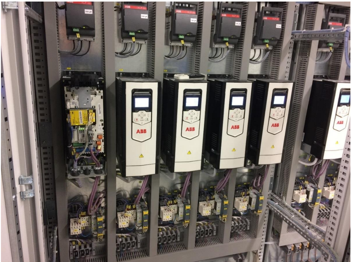
Obrázek 48 Zapojení měničů a modulu FSO-12 v rozvaděči
