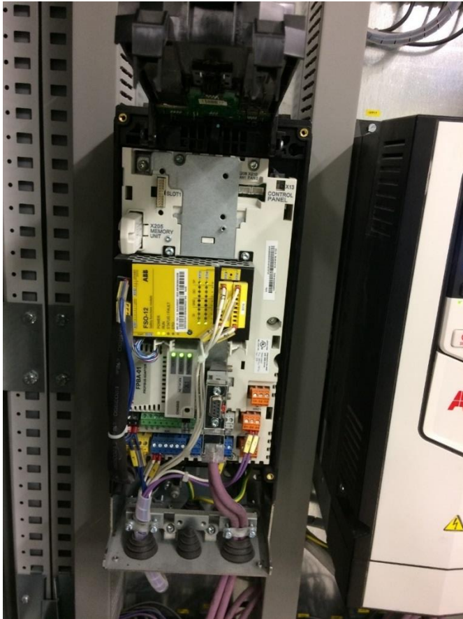
Obrázek 49 Detail zapojení bezpečnostního modulu FSO-12 ve Vápence Čertovy schody
