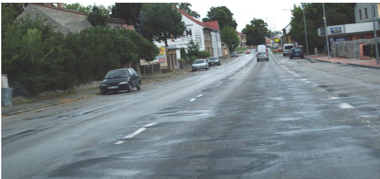
Obrázek č. 102. Nevyhovující technický stav vozovky ve městě Lišov.[autor]
