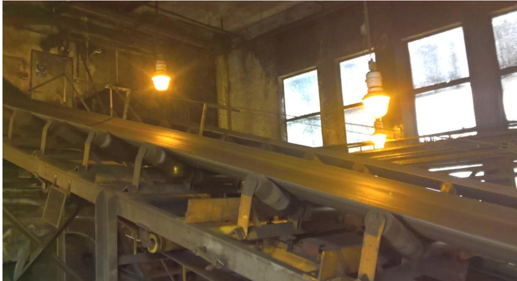
Obr. 10 – Pásový dopravní používaný v Elektrárně Opatovice (zdroj: Autor )
